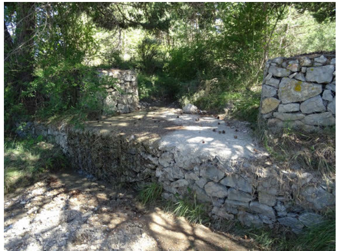
Foto 10. Dique de retención de sólidos en un afluente de la RNF del Mijares
