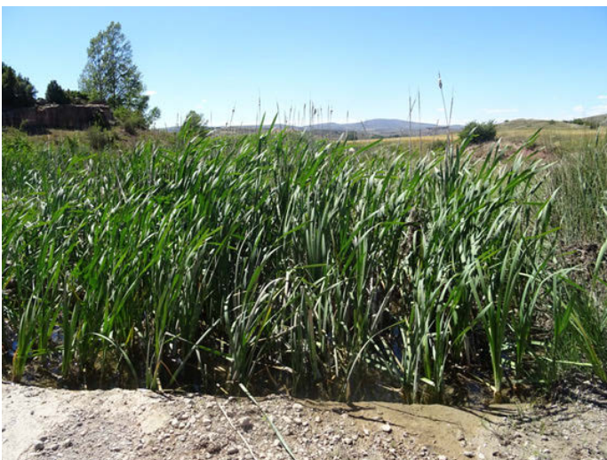
Foto 11. Paso entubado totalmente colmatado de sedimentos y carrizo en el tramo medio
