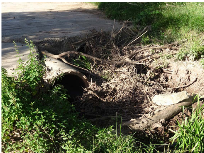
Foto 25. Colmatación de sedimentos y restos vegetales en un paso entubado
