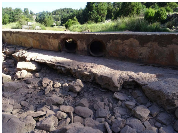
Foto 26. Descalce de la estructura del paso entubado en el tramo bajo de la RNF
