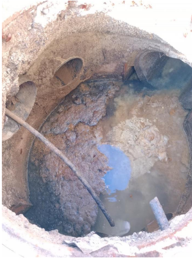
1. C/ ALBACETE. ARQUETA ATERRADA PARCIALMENTE
