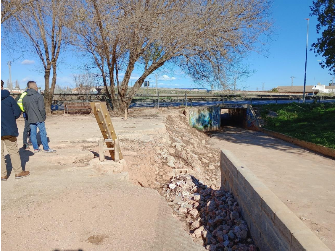
8. C/ RAFAEL ALBERTI. DAÑOS EN SALIDA HACIA PASO INFERIOR
