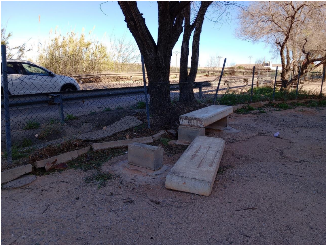
8. C/ RAFAEL ALBERTI. CUNETA DESTROZADA Y DAÑOS EN EL PARQUE
