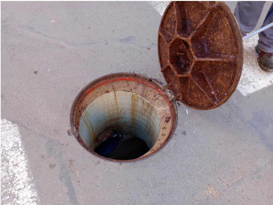
1. C/ ALBACETE. POZO LIMPIADO RECIENTEMENTE
