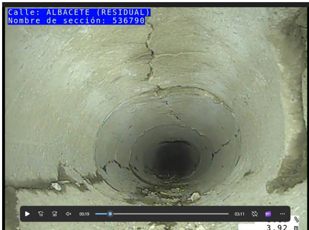
Detalles de la deformación y agrietamiento de la tubería de hormigón revisado con la cámara.
