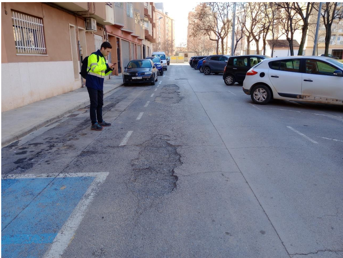
3. C/ ALBACETE. HUNDIMIENTO EN ASFALTO ENCIMA DEL COLECTOR
