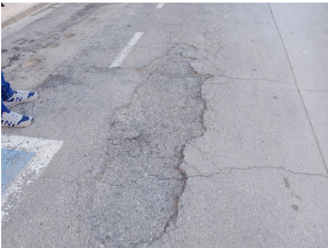
3. C/ ALBACETE. DETALLE DEL HUNDIMIENTO EN EL FIRME
