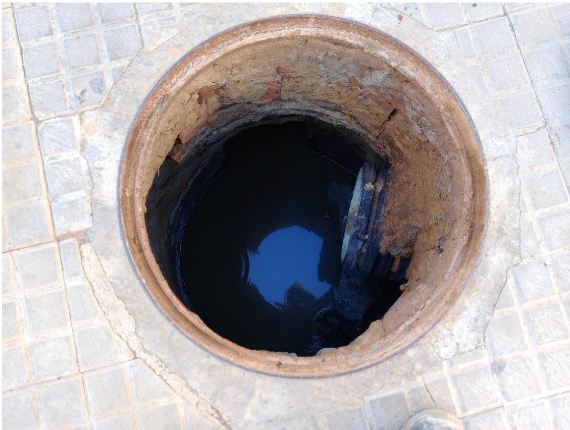
4. C/ CUENCA. DETALLE DE FÁBRICA DE LADRILLO DAÑANA
