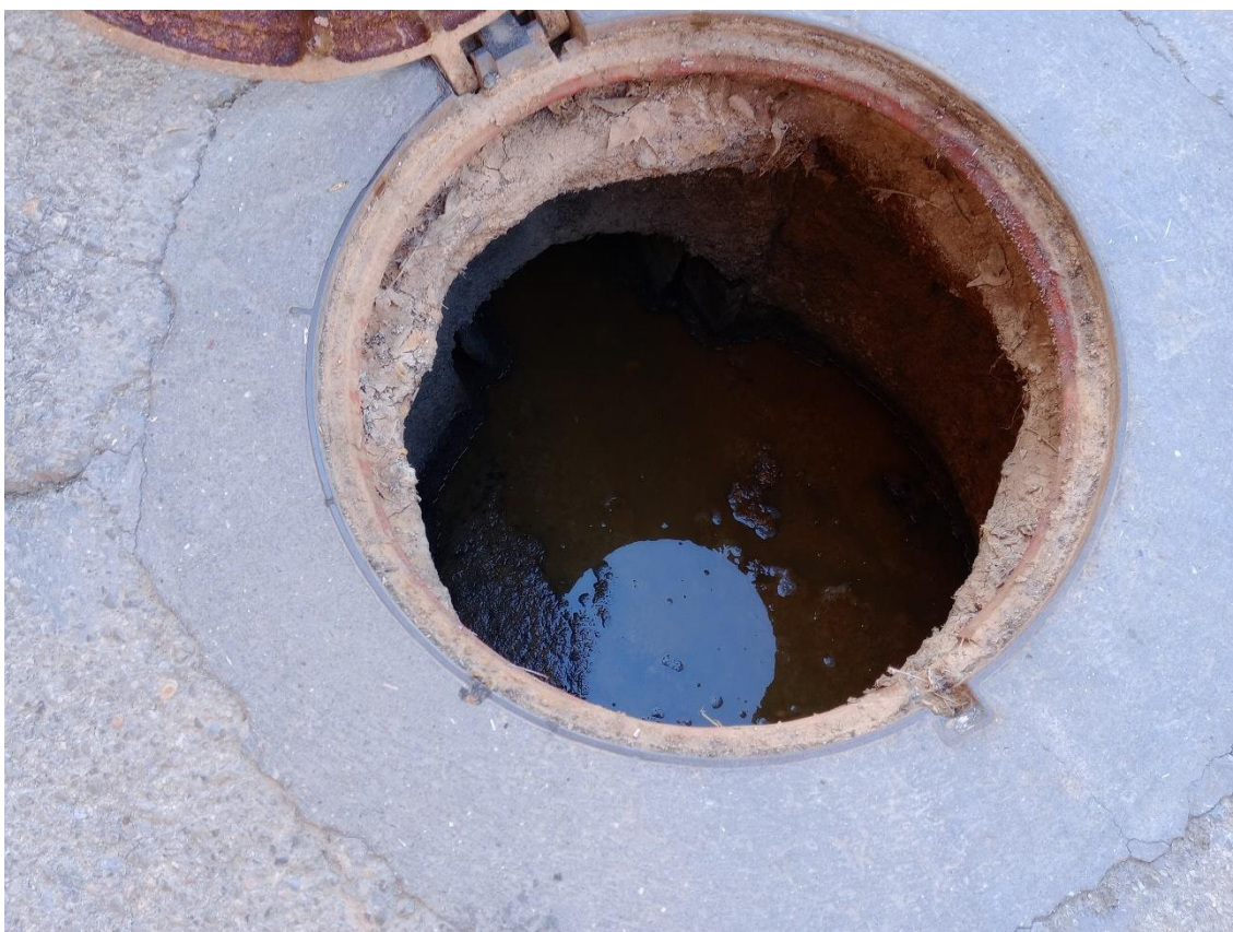
2. C/ ALBACETE. POZO DAÑADO Y PARCIALMENTE ATERRADO
