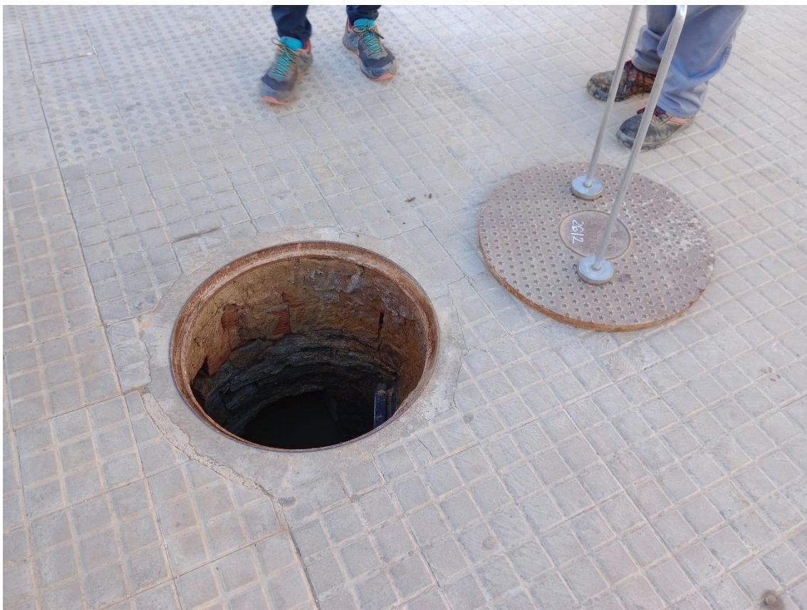
4. C/ CUENCA. ARQUETA DAÑADA
