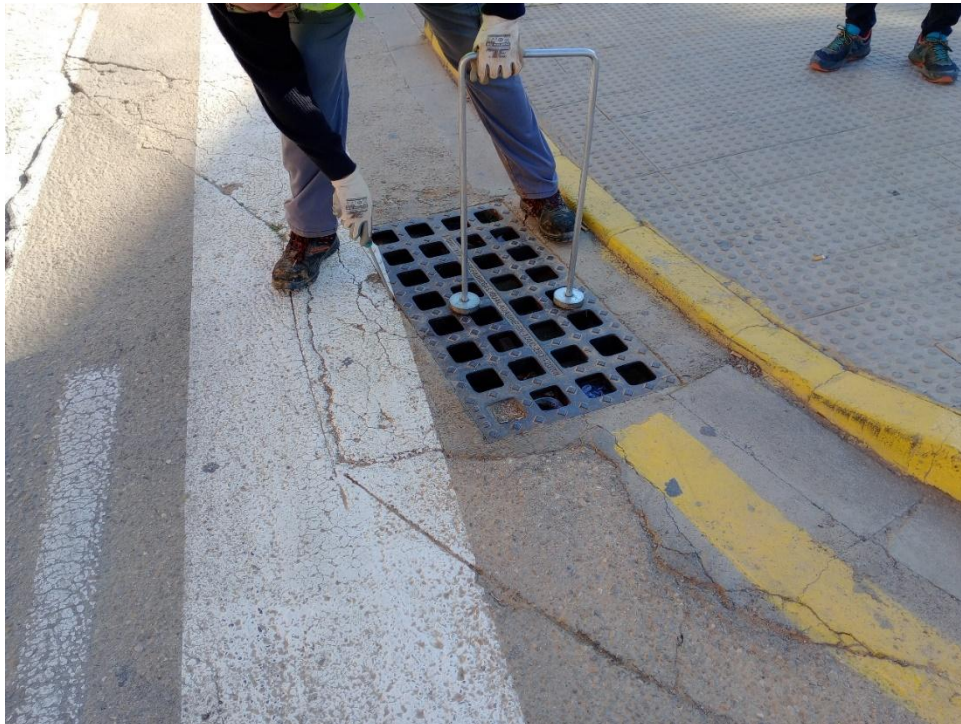
Detalle de agrietamiento entorno a imbornal.
