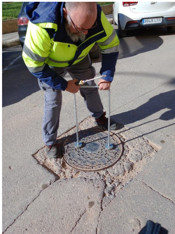
1. C/ ALBACETE. ARQUETA DAÑADA
