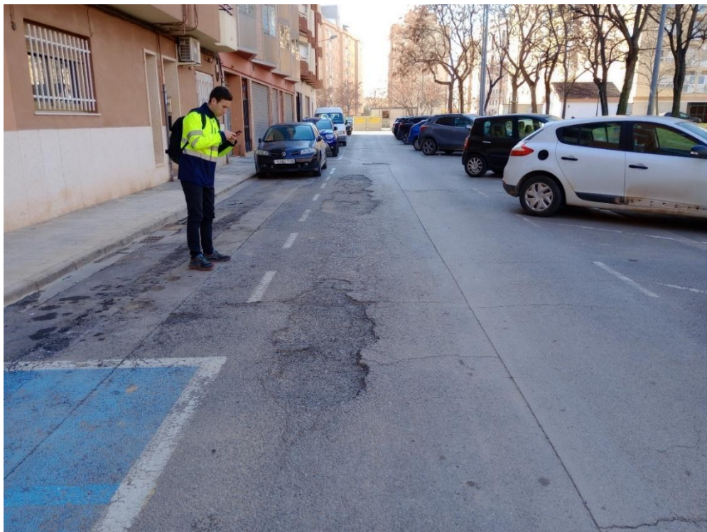
Daños y deformaciones en el firme de la calle Albacete.
