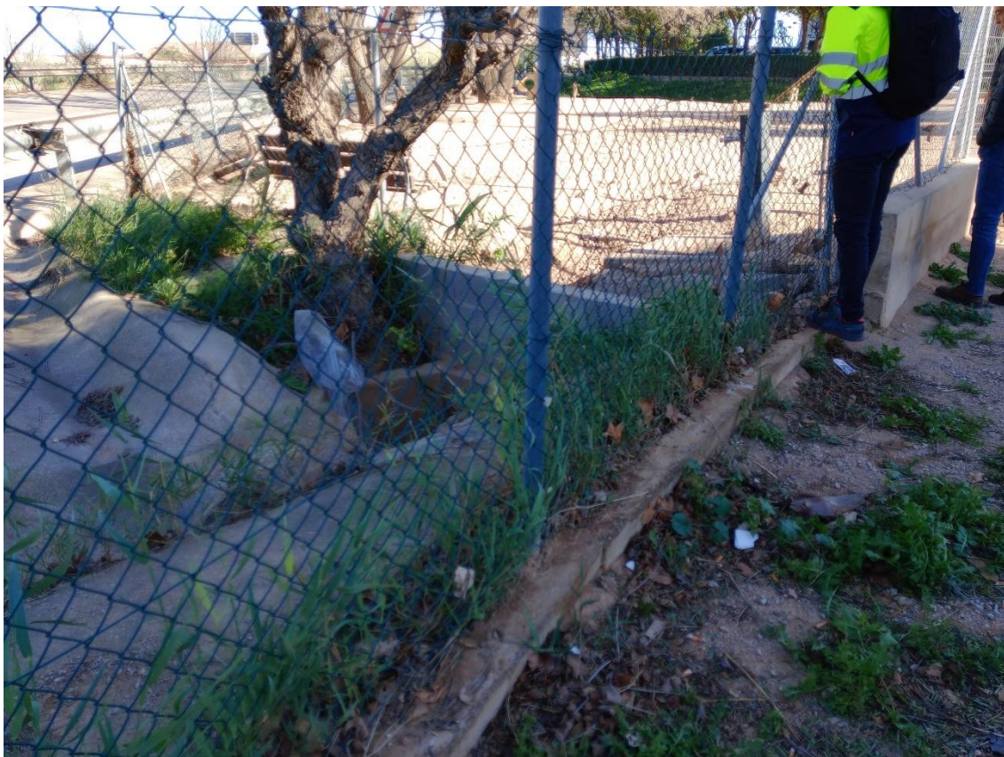
8. C/ RAFAEL ALBERTI. DAÑOS EN CUNETA
