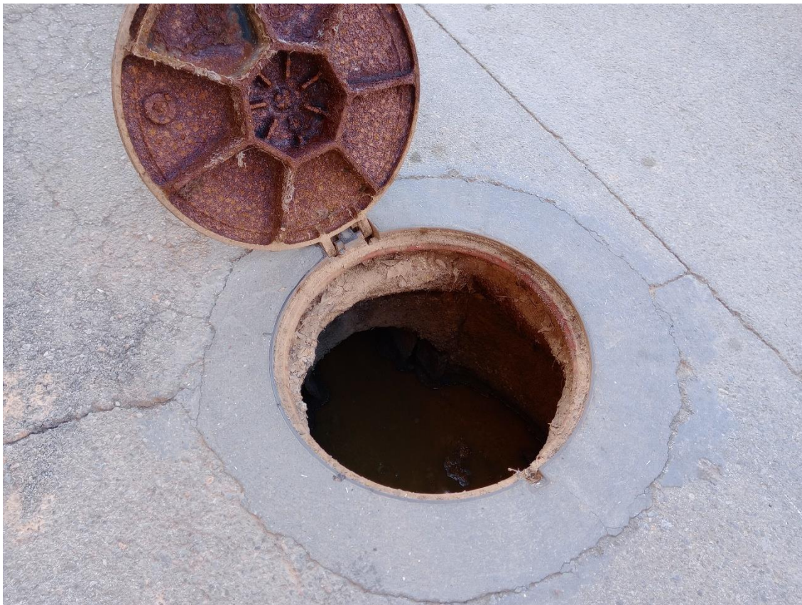
2. C/ ALBACETE. HUNDIMIENTO EN EL ASFALTO EN ENTORNO DEL POZO
