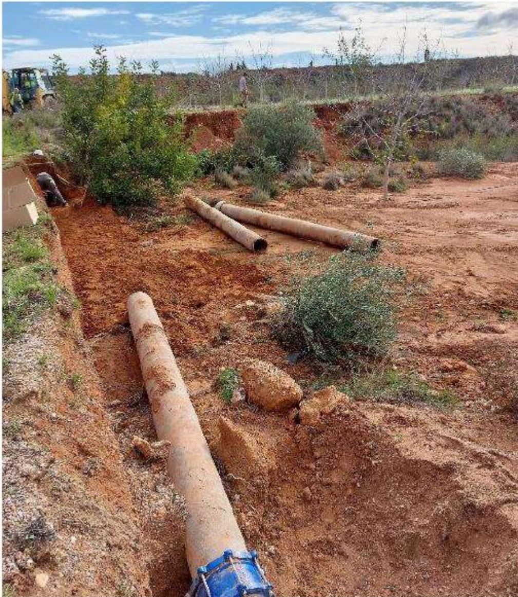
Imagen 8: Segunda rotura de tubería FC 300 mm paso rio Magro
