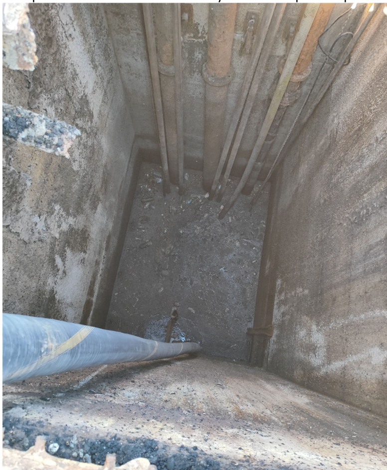
Estado actual pozo de bombeo EBAR Bonaire
