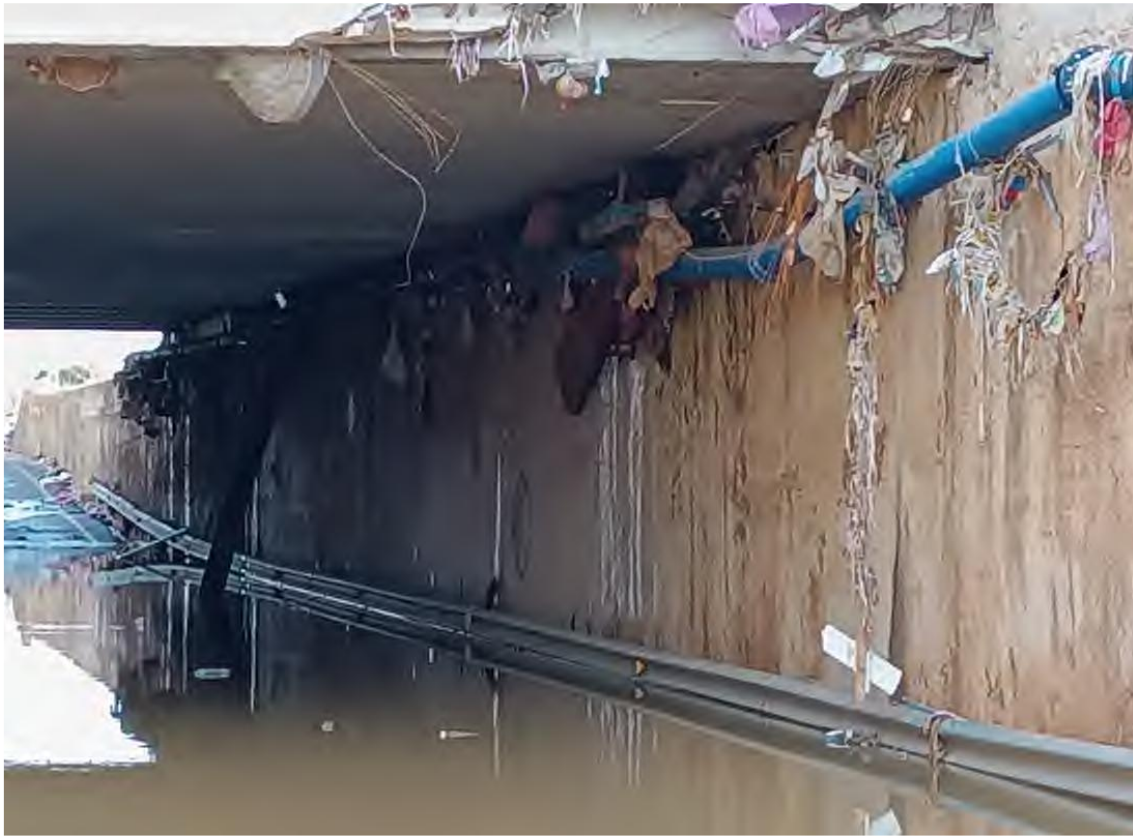
Imagen nº11. Tubería EMSHI dañada
