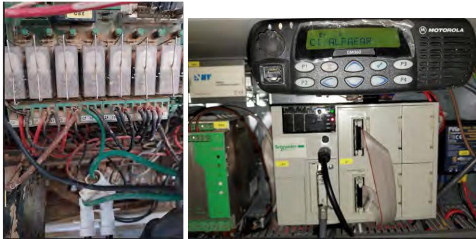
Imagen nº7. Componentes Eléctricos deteriorados
