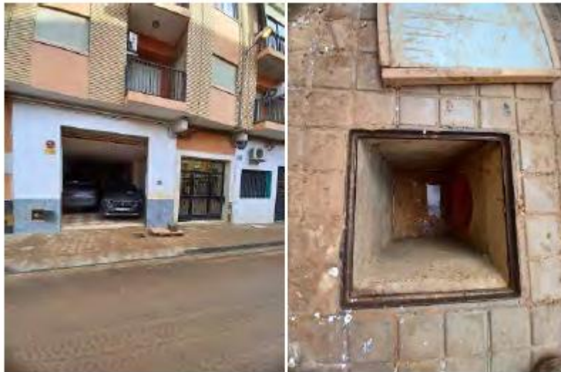
Imagen nº26. Ausencia o pérdida de Tapas de Registro
