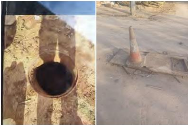
Imagen nº25. Ausencia o pérdida de Tapas de Registro
