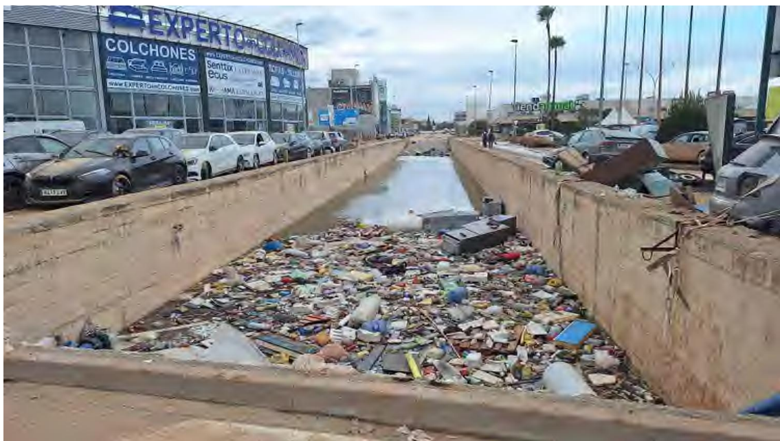
Imagen nº20. Estación de Bombeo Carrefour
