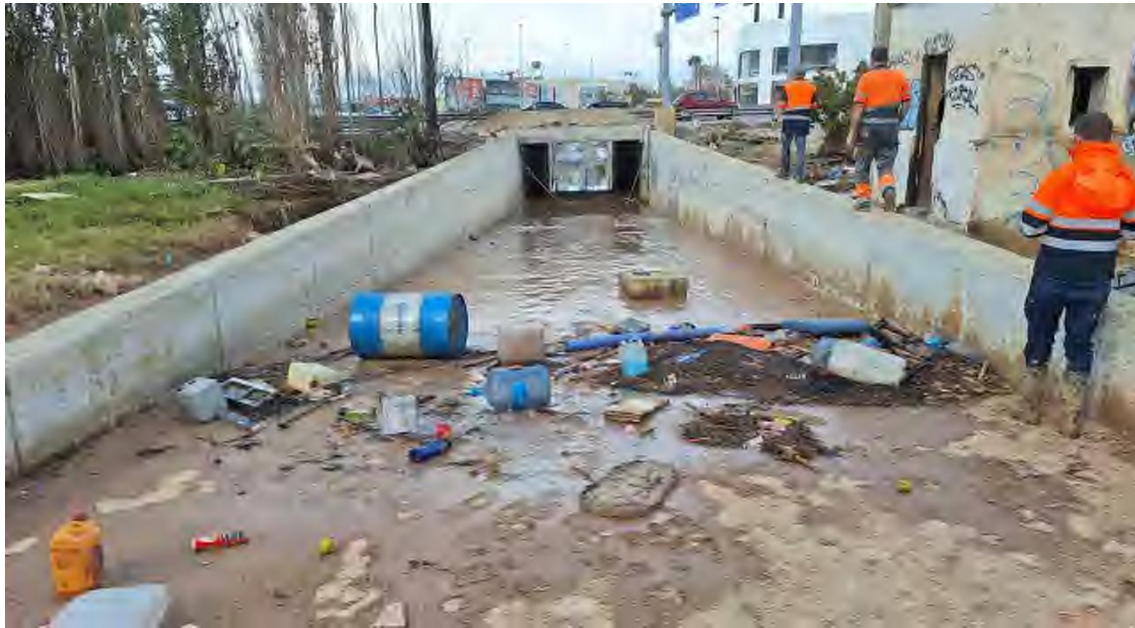
Imagen nº19. Estación de Bombeo Pont de Pedra
