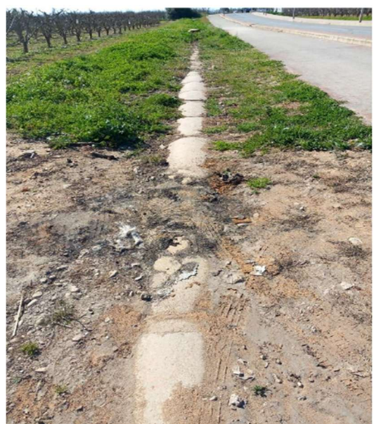
8.- Colector Ronda Hljinia Noja despues de Dana.
