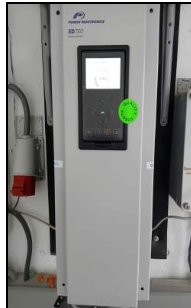
Fotografía nº 2. Variador Bombeo Depósito superior
