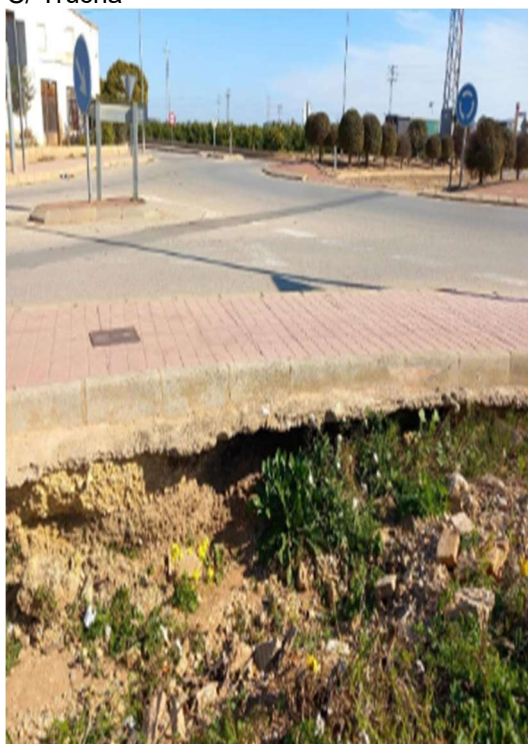
11.- Estado de la calzada c/ Trucha cruce Ronda Hijinia Roja .
