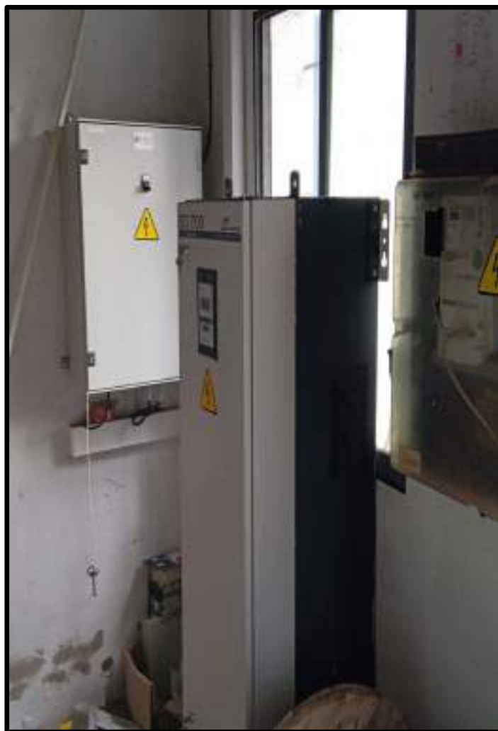
Fotografía nº 1. Variador Pozo Los Lagos
