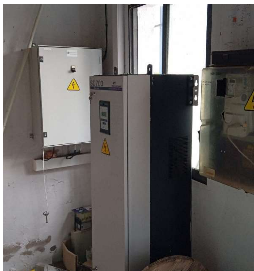
3.- Variador frecuencia bombeo pozo
