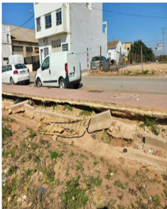
10.- Colector en al c/ Trucha despues de Dana.
