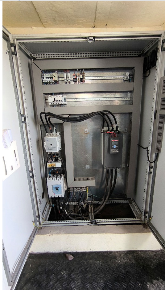
Vista general del cuadro de protección del bombeo "Povea 2". Fuente: Inspección de campo realizada por AMBLING con fecha de 23/01/2025
