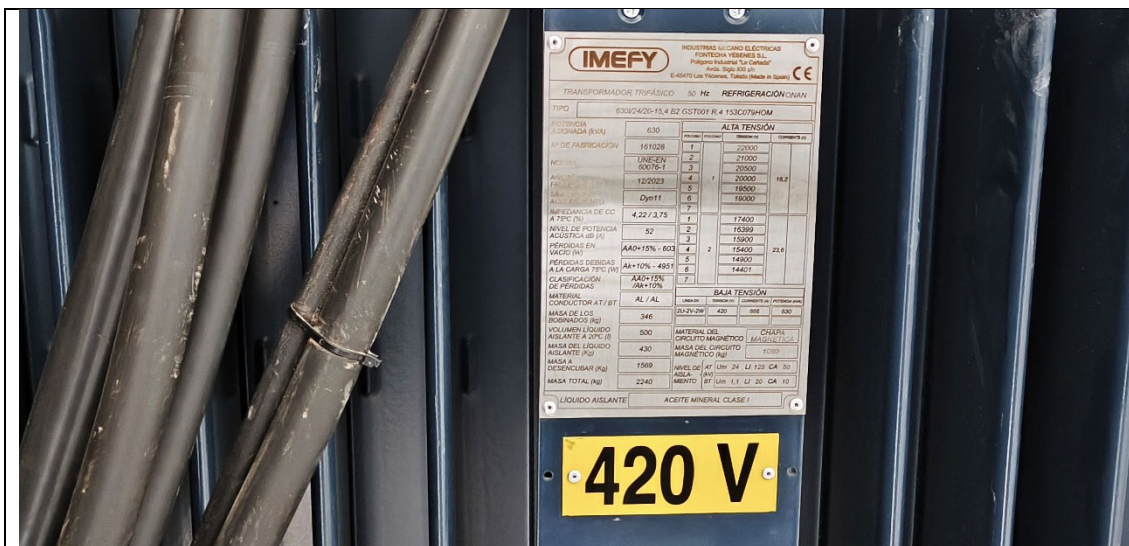
Identificación del nuevo transformador, con potencia asignada 630kVA. Fuente: Inspección de campo realizada por AMBLING con fecha de 23/01/2025
