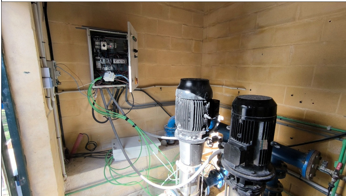
Vista general del cuadro de protección del rebombeo de Tomillares. Fuente: Inspección de campo realizada por AMBLING con fecha de 23/01/2025
