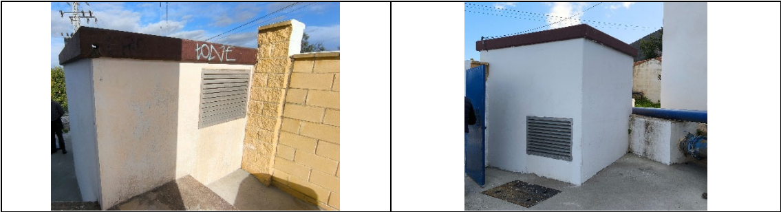
Rejillas de ventilación ejecutadas en la caseta del centro de medida (en paramentos enfrentados). Fuente: Inspección de campo realizada por AMBLING con fecha de 23/01/2025
