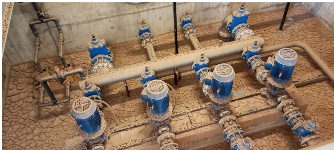
Imagen 1: Sistema de Impulsión depósito El Plà
