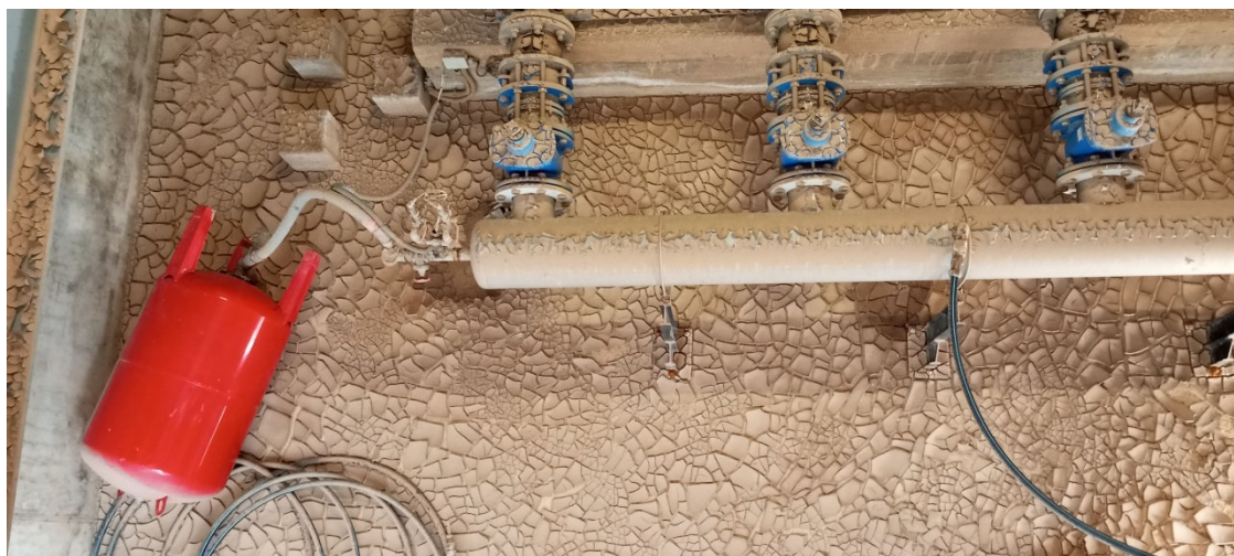
Imagen 2: Sistema de Impulsión depósito El Plà
