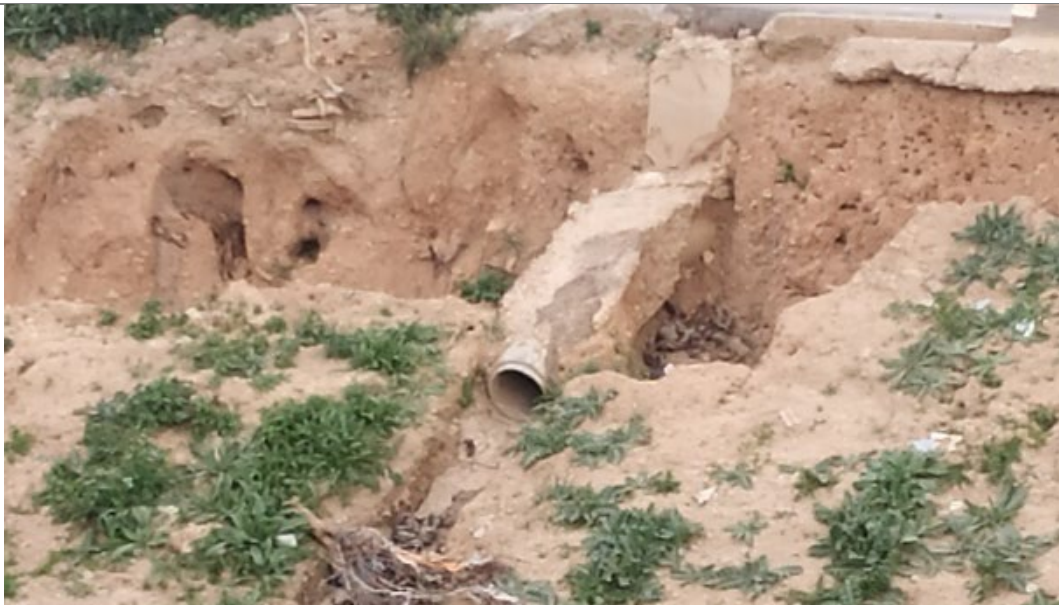
Detalle de salida de pluviales al barranco dañada
