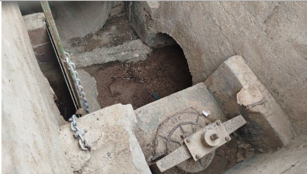
Estado de arqueta de salida al barranco de pluviales
