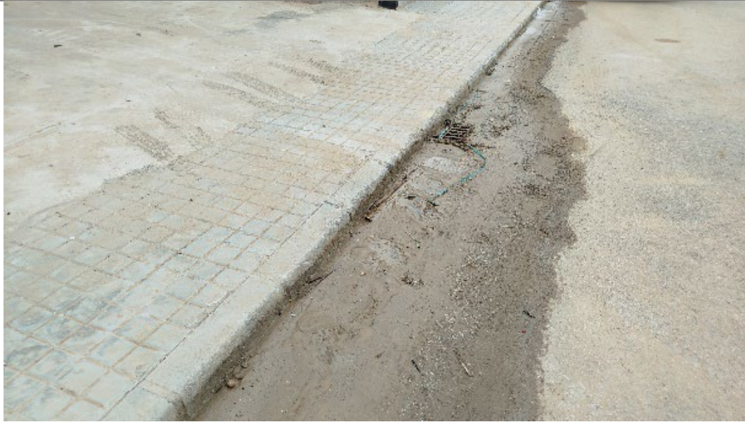
Sumidero del polígono industrial Vereda Sur de Beniparrell atascado
