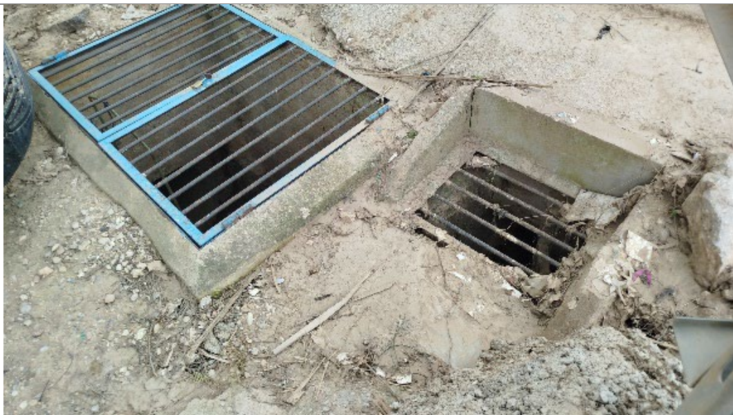
Estado de los sumideros de pluviales a limpiar
