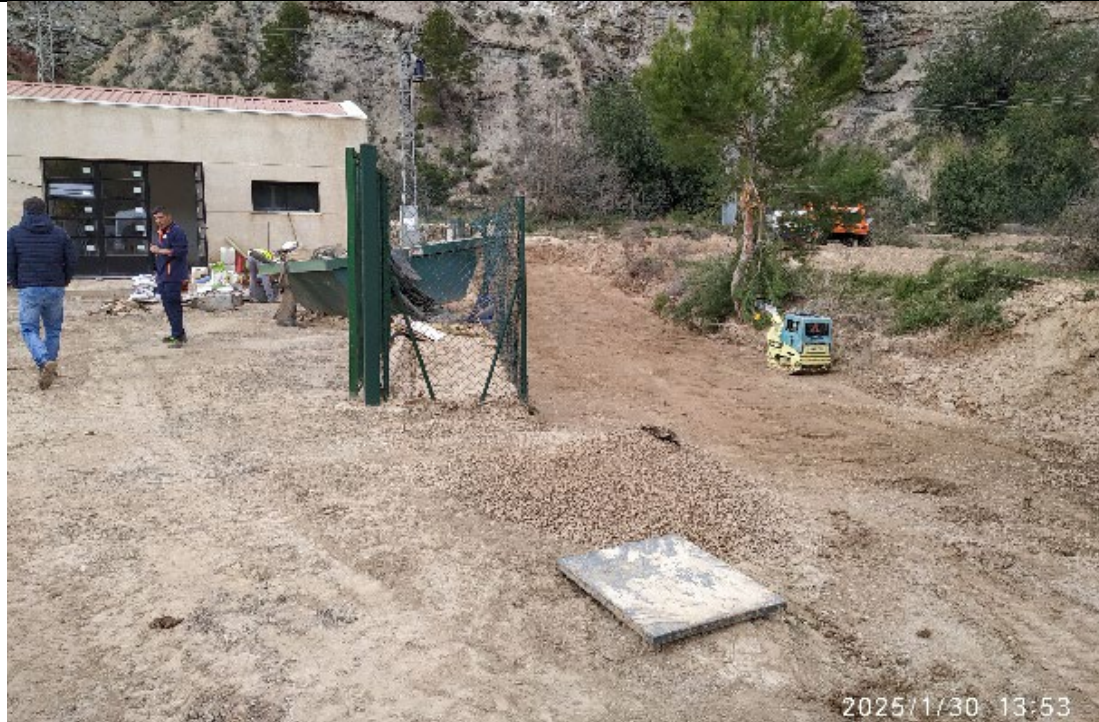
Vista de la entrada a la EDAR
