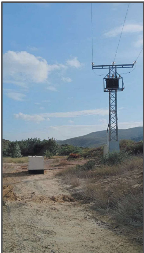
Fotografía nº 1. Alquiler del grupo electrógeno
