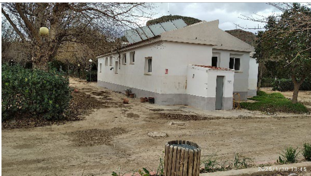
Edificio del camping cercano al bombeo, se aprecia la marca de la altura a la que llegó la inundación.
