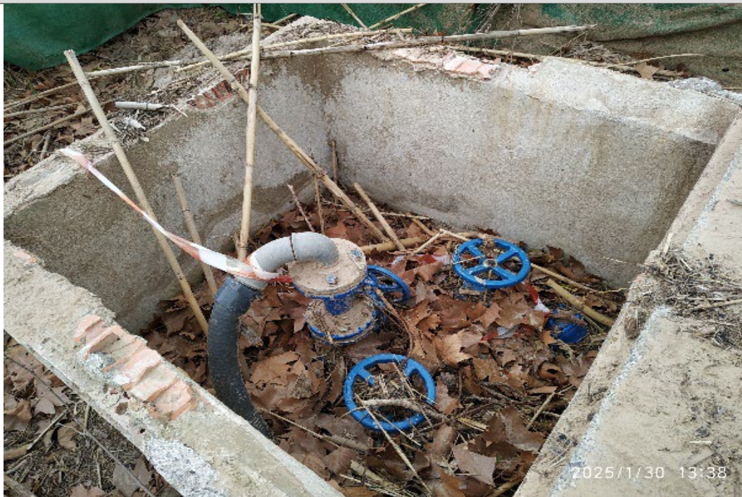
Arqueta de válvulas del bombeo, totalmente llena de maleza.
