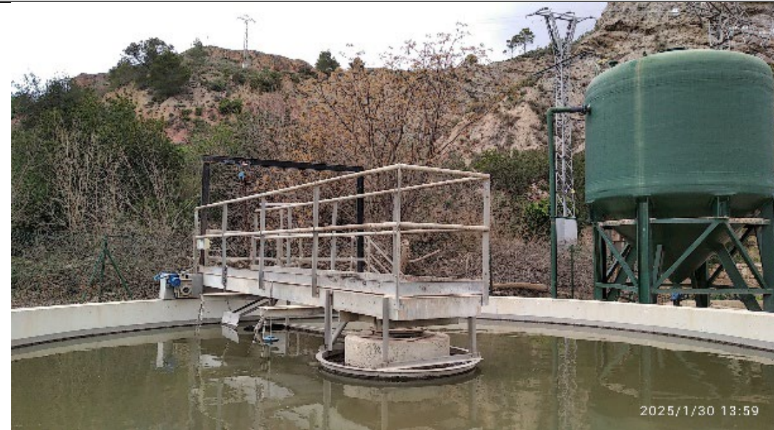
Vista del decantador secundario y el decantador de fangos
