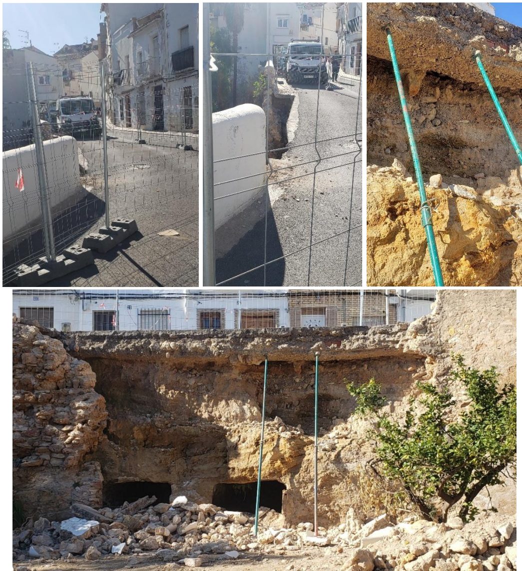
Daños en el muro de contención. Fuente: Visita realizada (03-02-2025).
