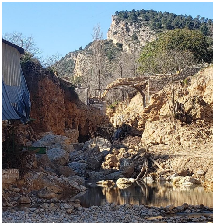
Daños en el puente del camino Piscina. Fuente: Visita realizada (03-02-2025).
