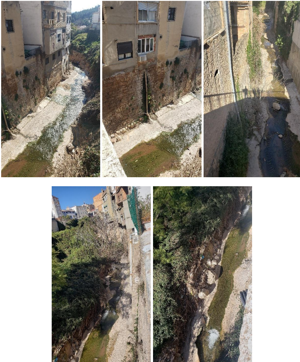
Acometidas domiciliarias de saneamiento dañadas. Fuente: Visita realizada (03-02-2025).
