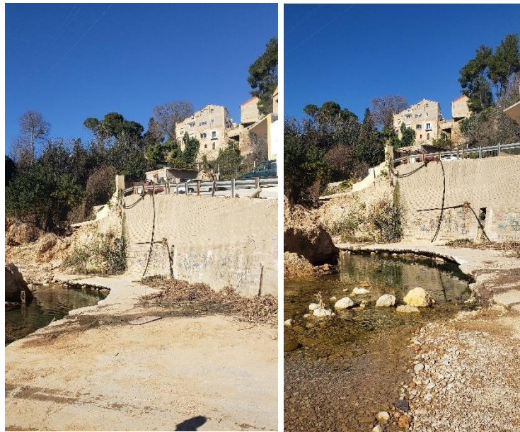
Estado de las duchas del evento de La Tomatina. Fuente: Visita realizada (03-02-2025).
