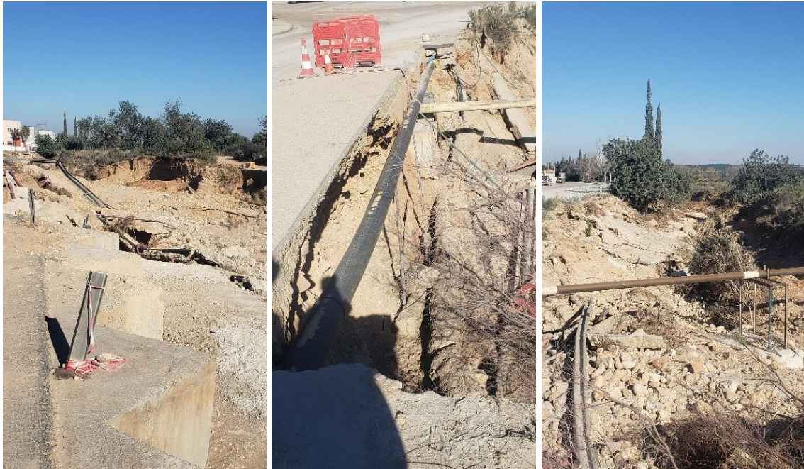
Afecciones en tubería de abastecimiento. Fuente: Visita realizada (3-02-2025)
