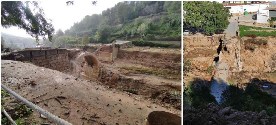
Daños en el puente del camino Piscina. Fuente: Fichas Diputación.
