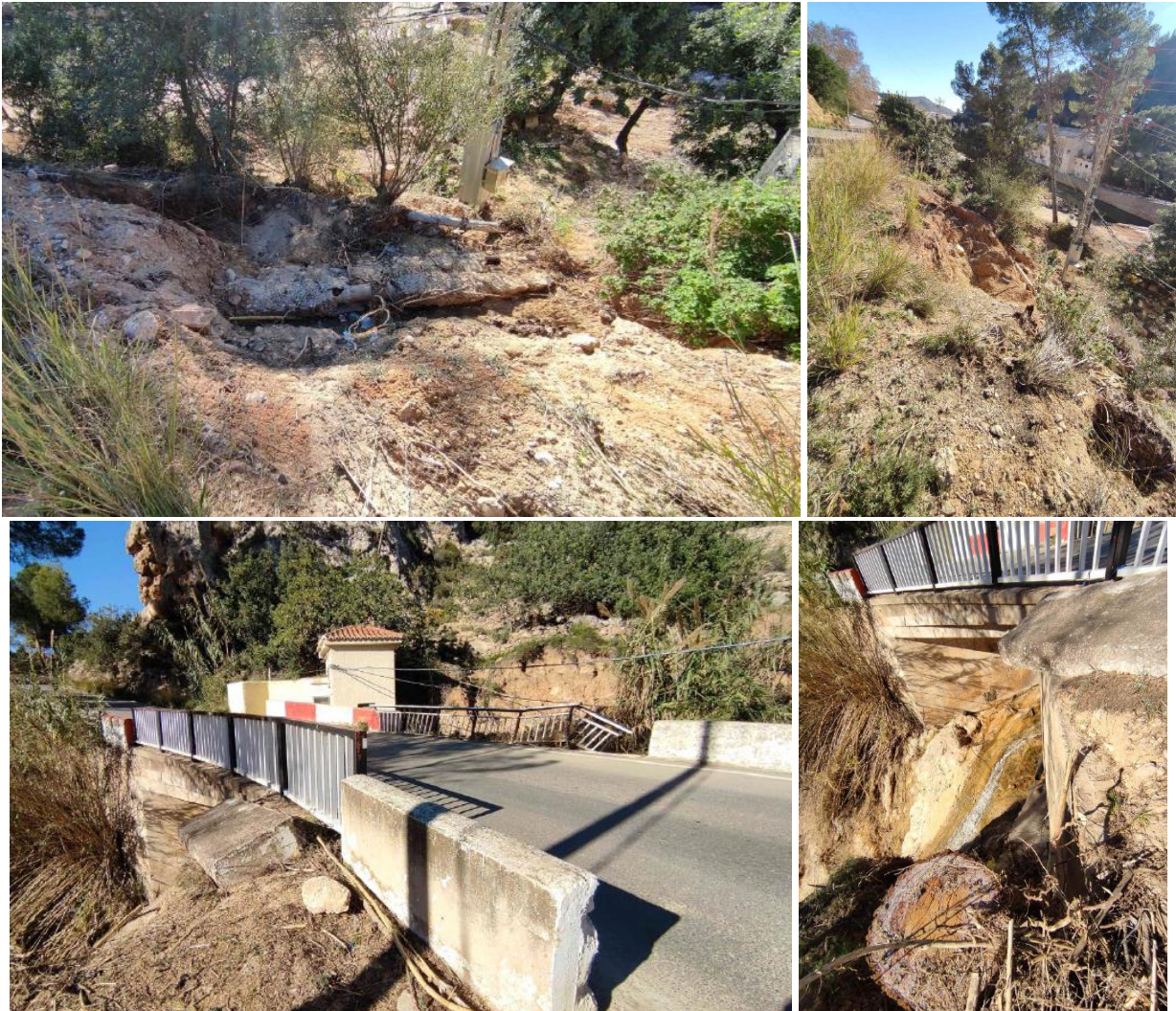
Daños en la tubería de fibrocemento. Fuente: Fichas Diputación de Valencia.
