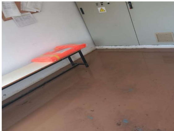
9.- estado del interior de la zona de cuadros eléctricos, el nivel de agua llego a unos 30 cm por encima del nivel del suelo
