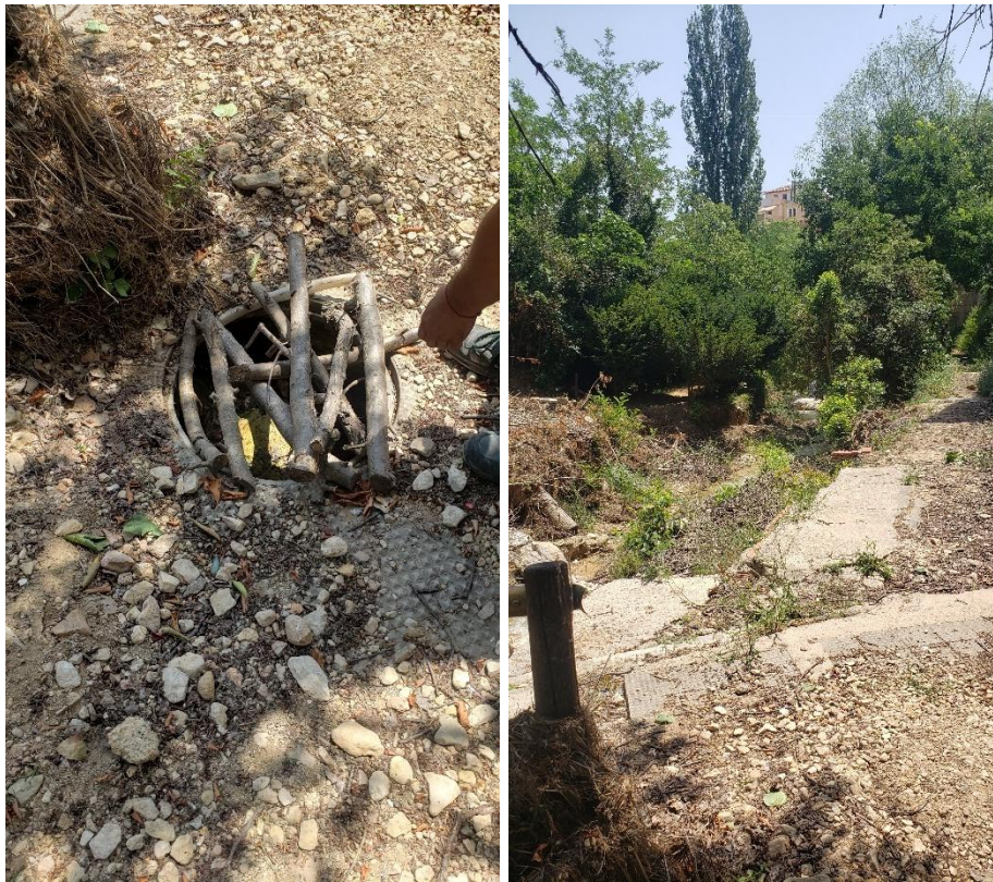
Colector en la calle La Fuente hacia la depuradora
