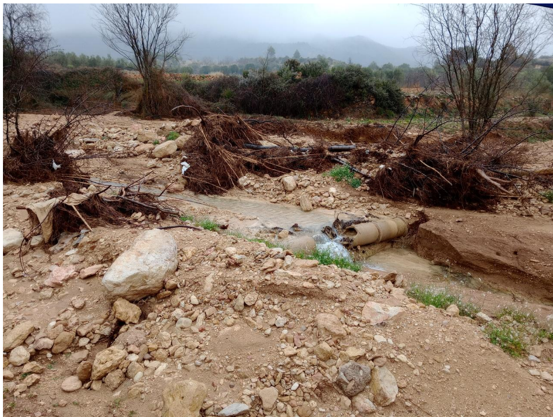
Colector de salida roto. Véase cauce desviado sobre el colector
