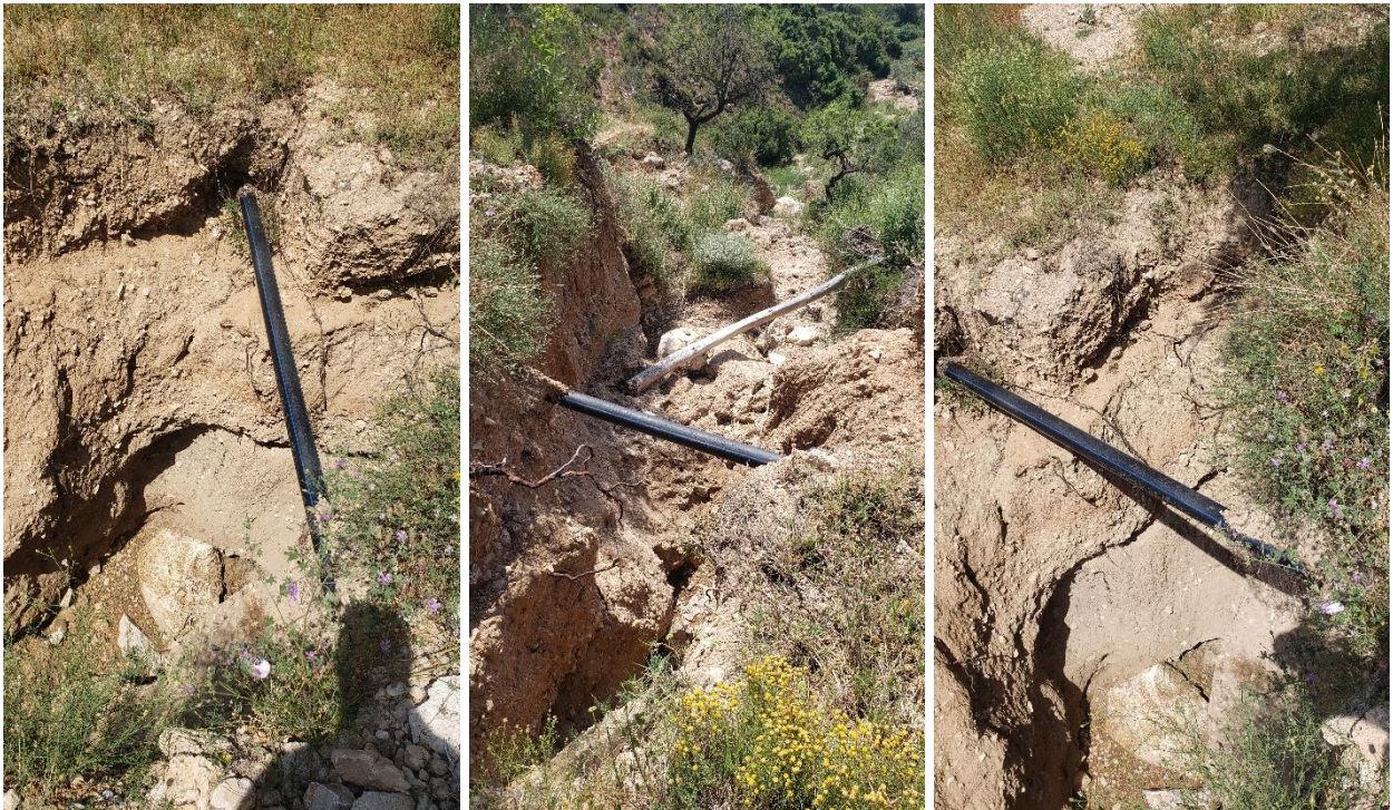
Socavón previo al cruce con el barranco de la Ermita. Fuente: Visita realizada.
