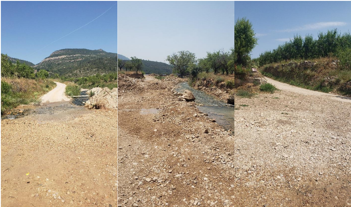
Daños en el cruce sobre el barranco de la Ermita en la unión al camino Casa del Conde. Fuente: Visita realizada (18-06-2025).
