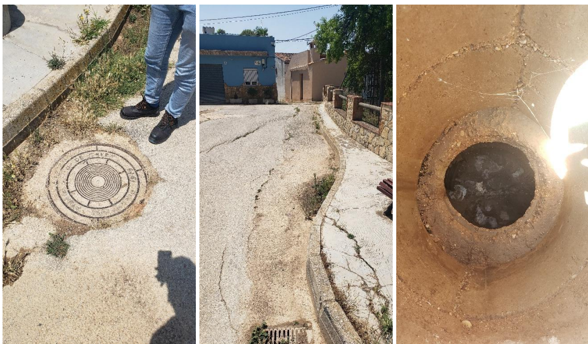
Colector en la calle Estrecha
