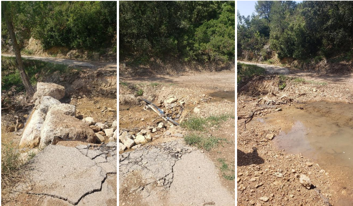
Daños en el camino de subida al depósito de cloración. Fuente: Visita realizada.
