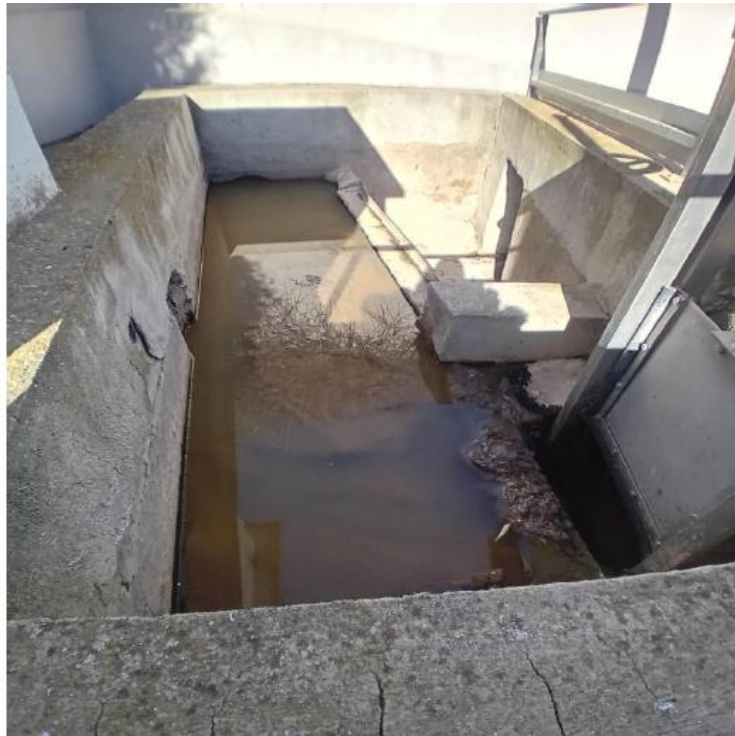
Obra de entrada colmatada de sedimentos
