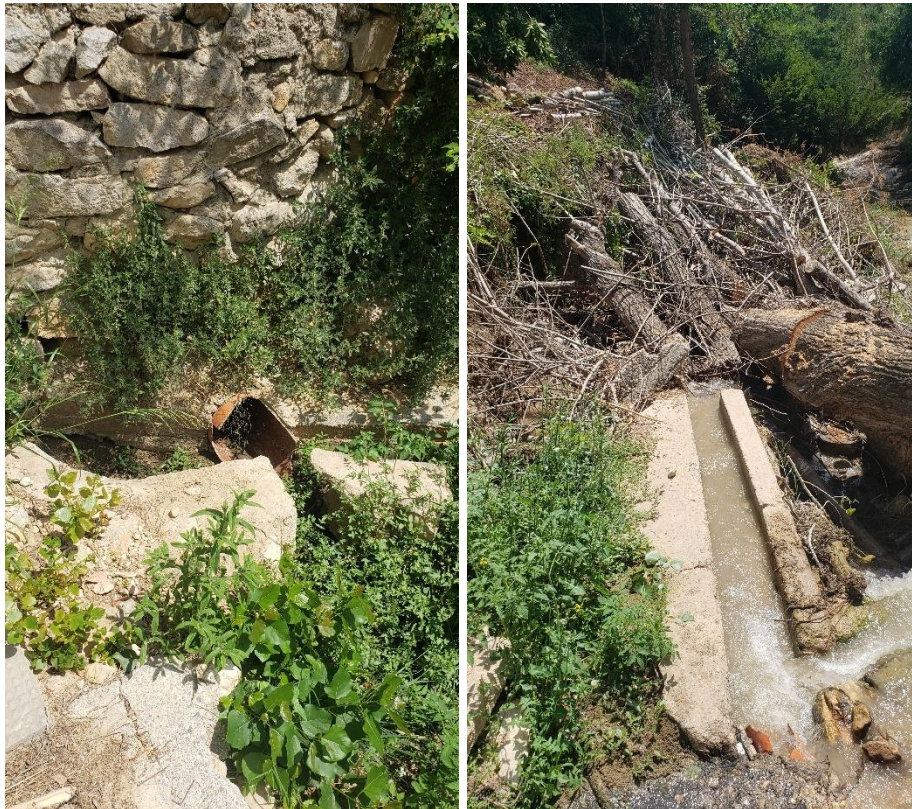
Colector en desconectado y acequia.
