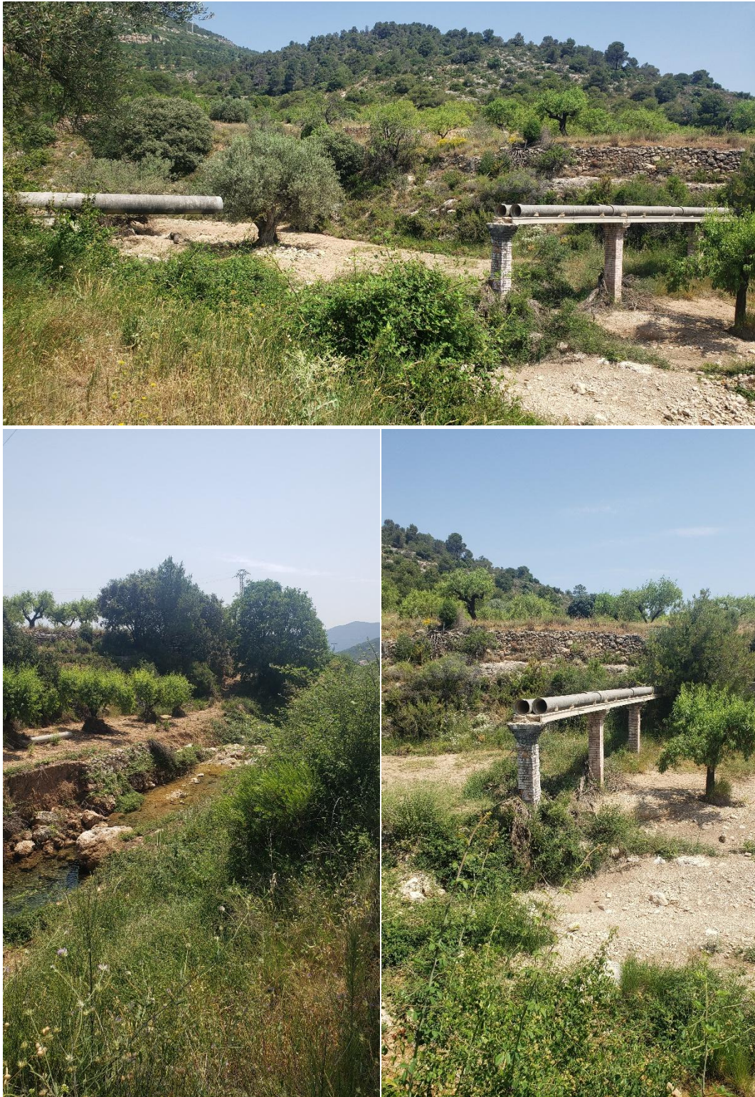
Daños en el cruce del barranco de la Ermita a la salida de alivio. Fuente: Visita realizada (18-06-2025).
