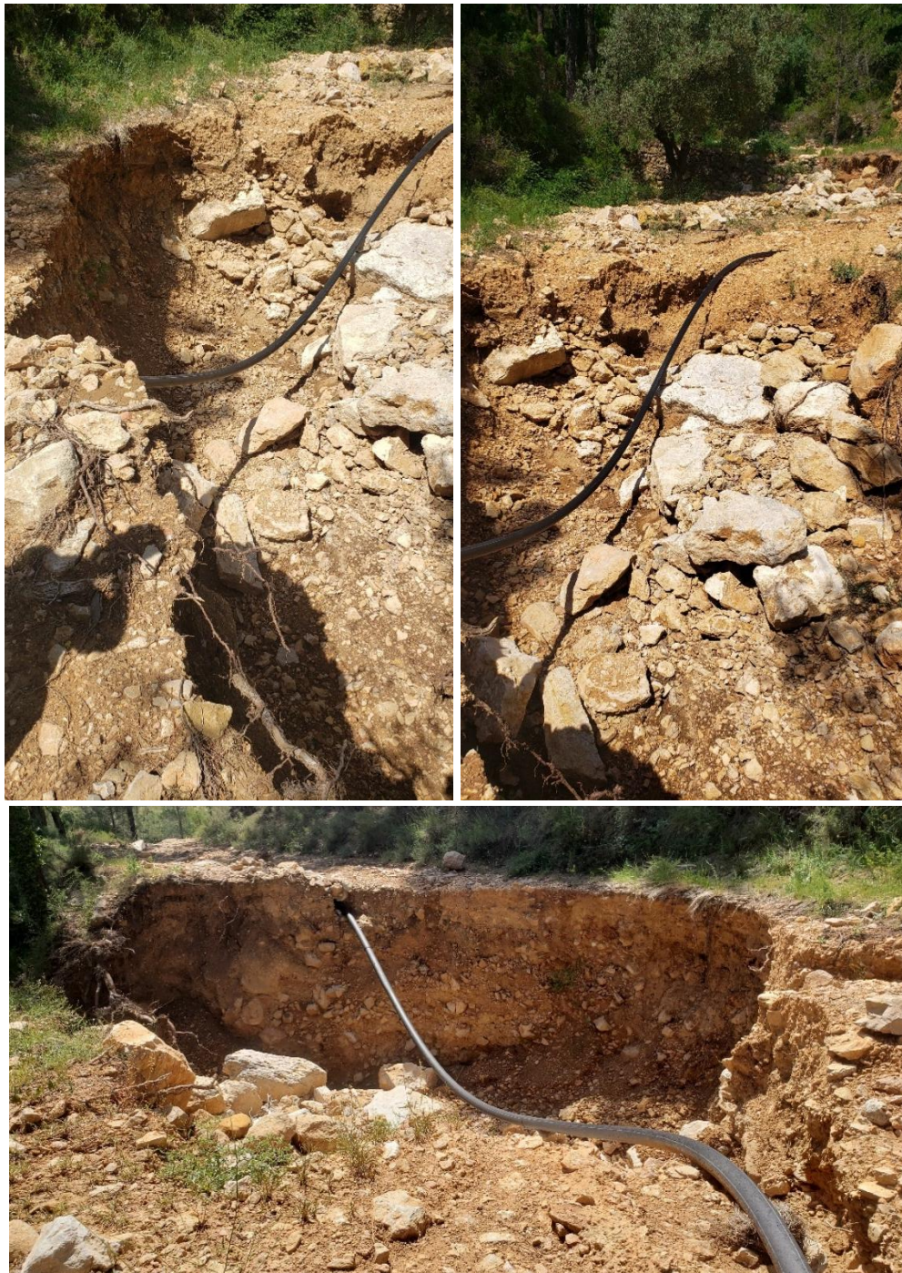
Socavón en el camino de acceso a las captaciones. Fuente: Visita realizada.
