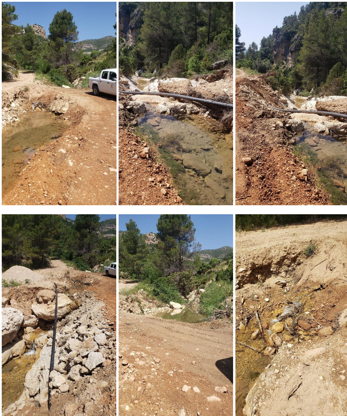
Afecciones en camino de ascenso a las captaciones. Fuente: Visita realizada.
