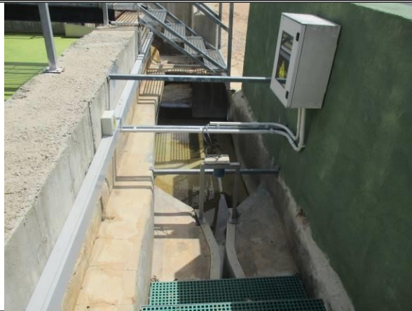
Caudalímetro de agua tratada.
