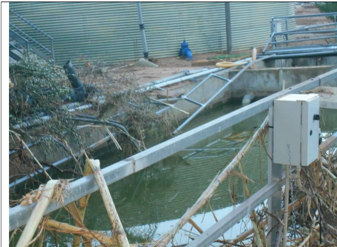
Imagen 12: Estado del reactor biológico
