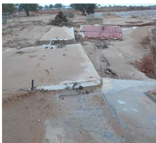
15.-Vista caseta y equipos desaparecidos
