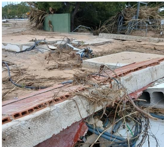
Edificios de control y equipos
