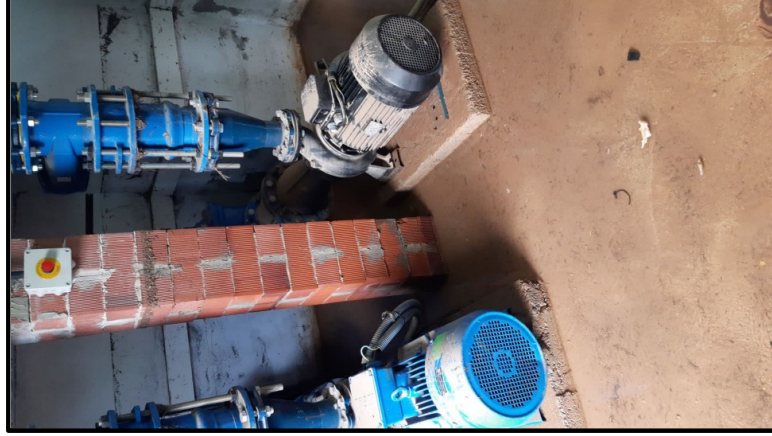
Fotografía nº 3. Motores a reemplazar
