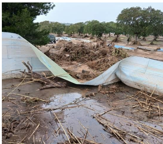
Interior depósitos de regulación.
