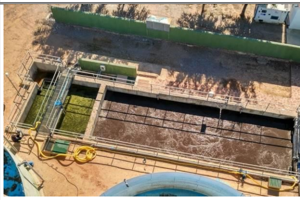
Punto de toma de muestra de agua tratada.
