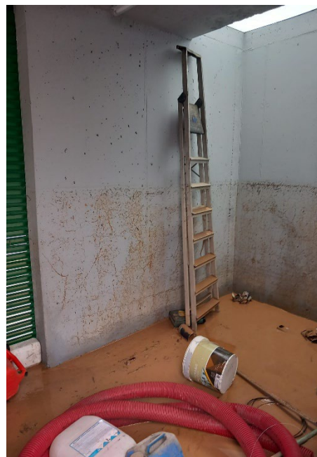
Imagen 10: Daños EBAR Corbera
