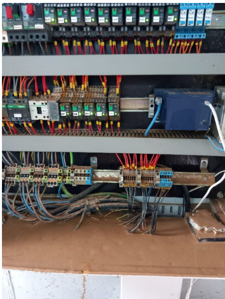
Imagen 7: Cuadro eléctrico EBAR
