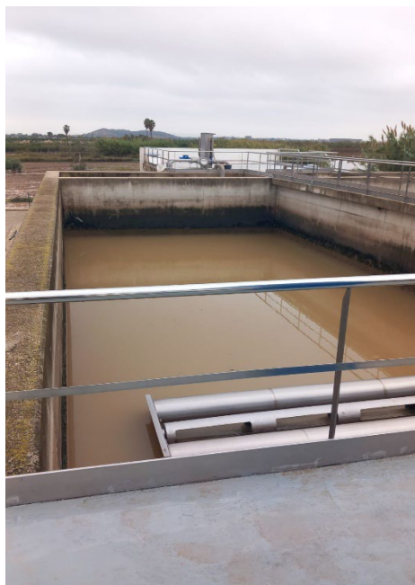
Imagen 9: Daños EDAR Corbera-Llaurí
