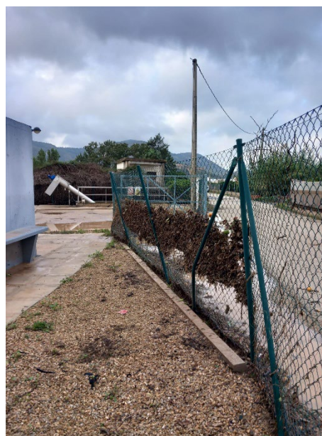
Imagen 6: Daños EBAR Corbera
