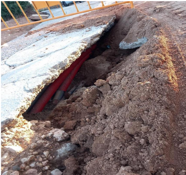
Imagen 6: Acometidas eléctricas a la vista
