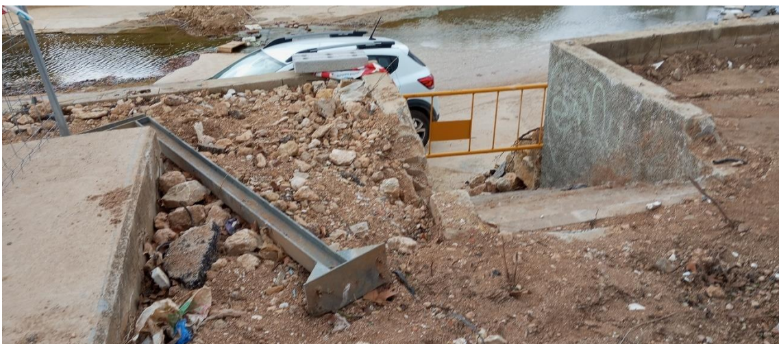
Imagen 12: Estructura Polipasto pozo de bombeo
