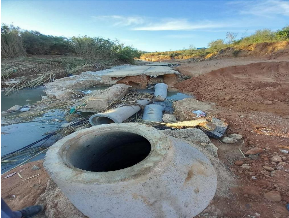
Imagen 3: Estado pozos y colector general
