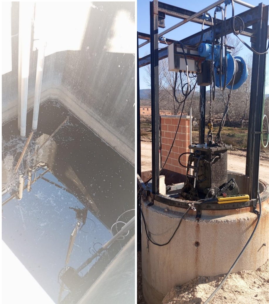
Imagen 10: Pozo de gruesos
