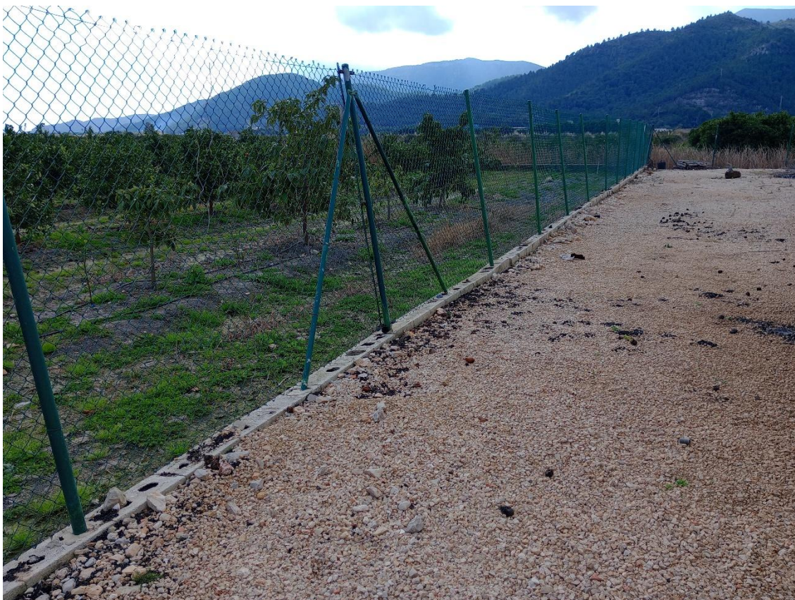
2.1 DETALLE DE APOYO Y VALLA DAÑADOS
