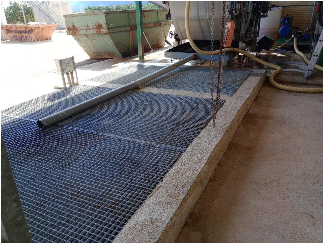
6 TRÁMEX SOBRE BOMBAS A SUSTITUIR
