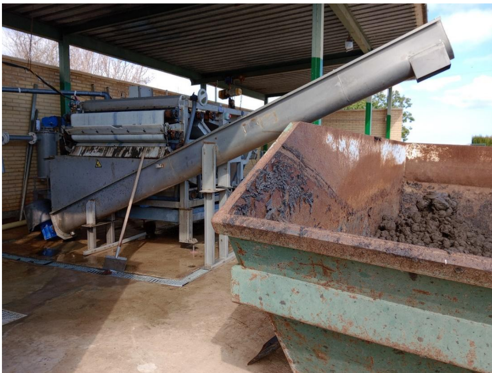
Detalle de la zona del pretratamiento. En el extremo, el motor averiado.
