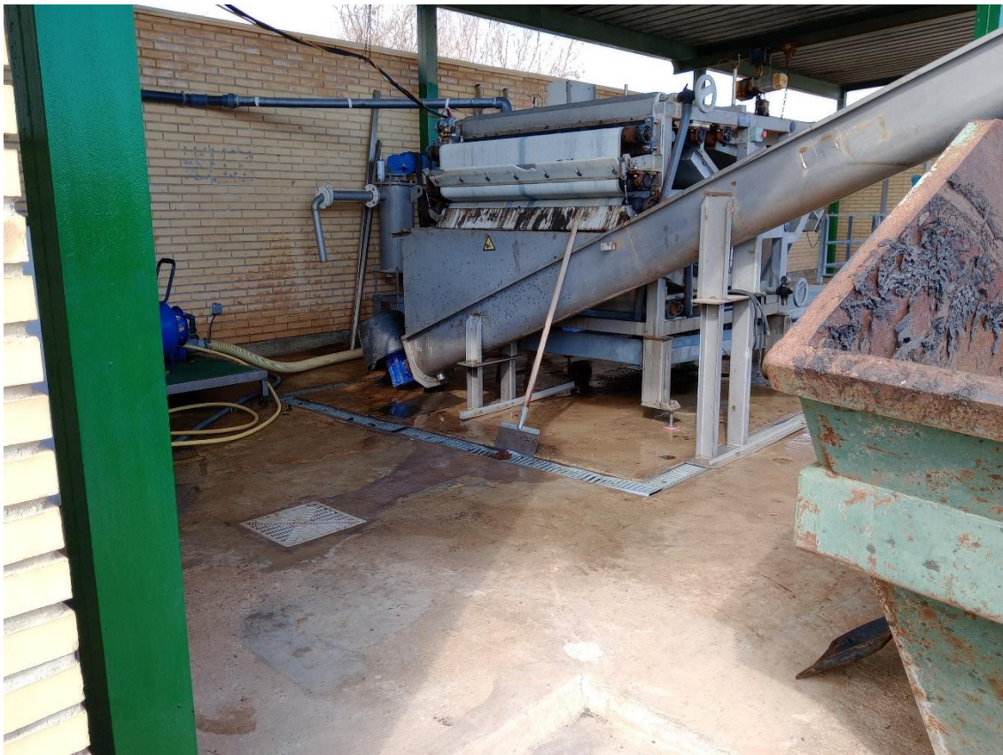
7 DETALLE DEL MOTOR DEL TORNILLO A SUSTITUIR
