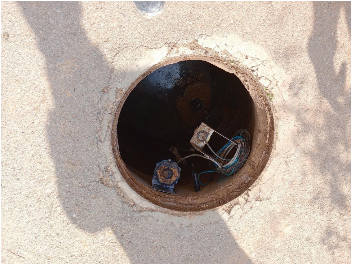
10 DETALLE DE LOS EQUIPOS DE ALIVIO DAÑADOS Y A SUSTITUIR
