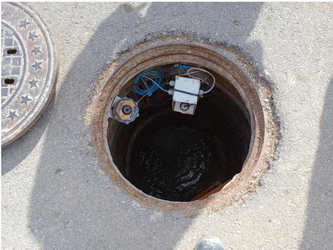
11 DETALLE DEL PUNTO DE ALIVIO 1 Y ARQUETA PARCIALMENTE ATERRADA
