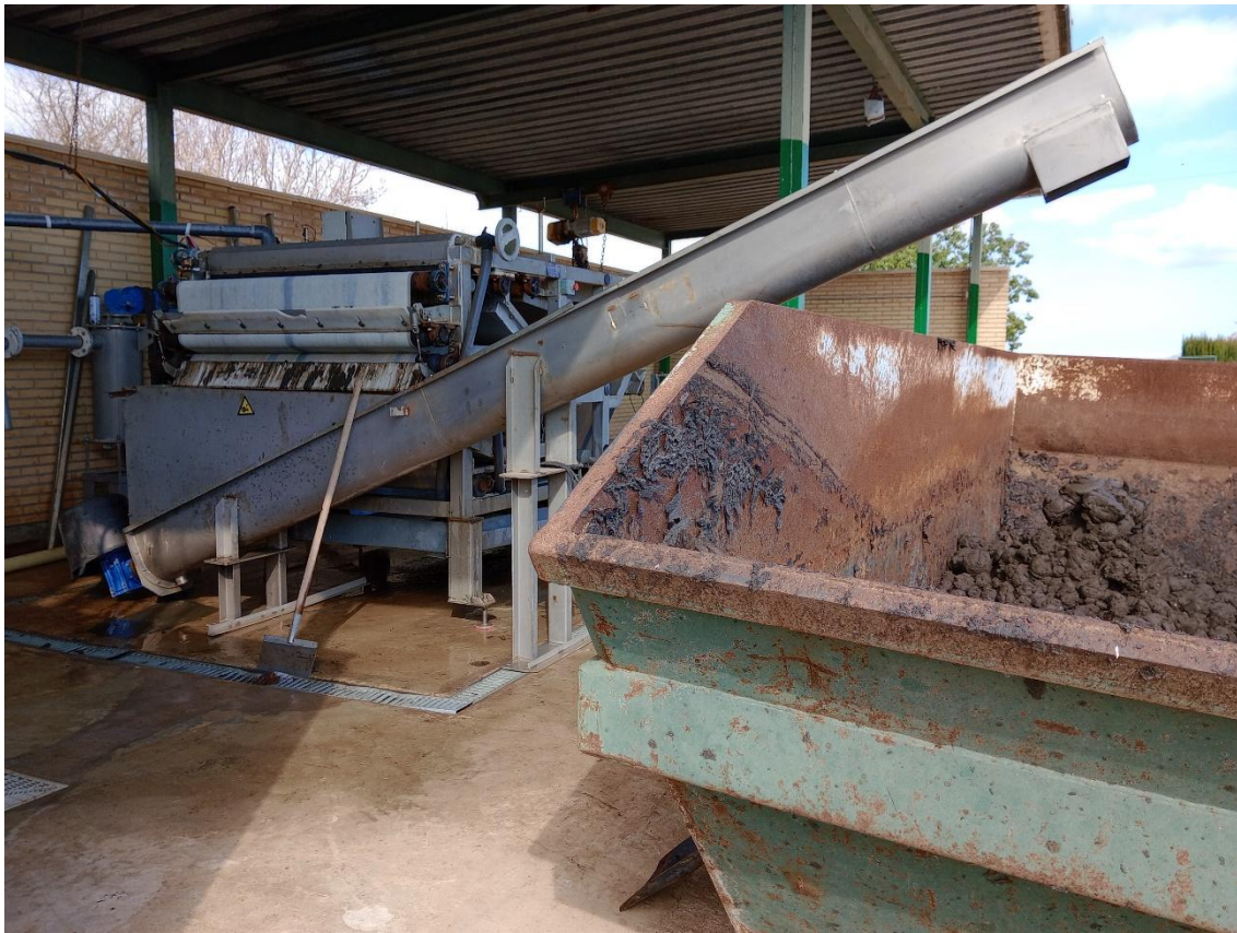
7 MOTOR Y REDUCTOR DEL TORNILLO A SUSTITUIR
