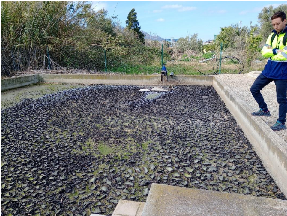
Superficie de la era de secado de fango a reparar.
