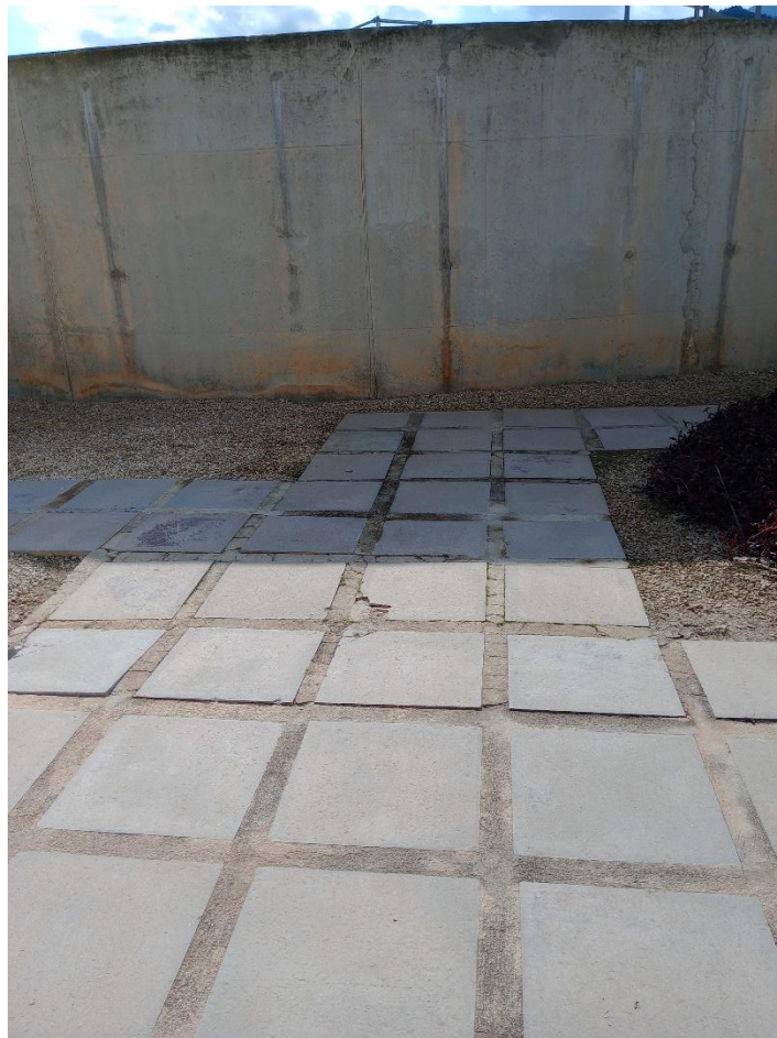
5 HUNDIMIENTO EN EL PAVIMENTO DE ACCESO AL DECANTADOR
