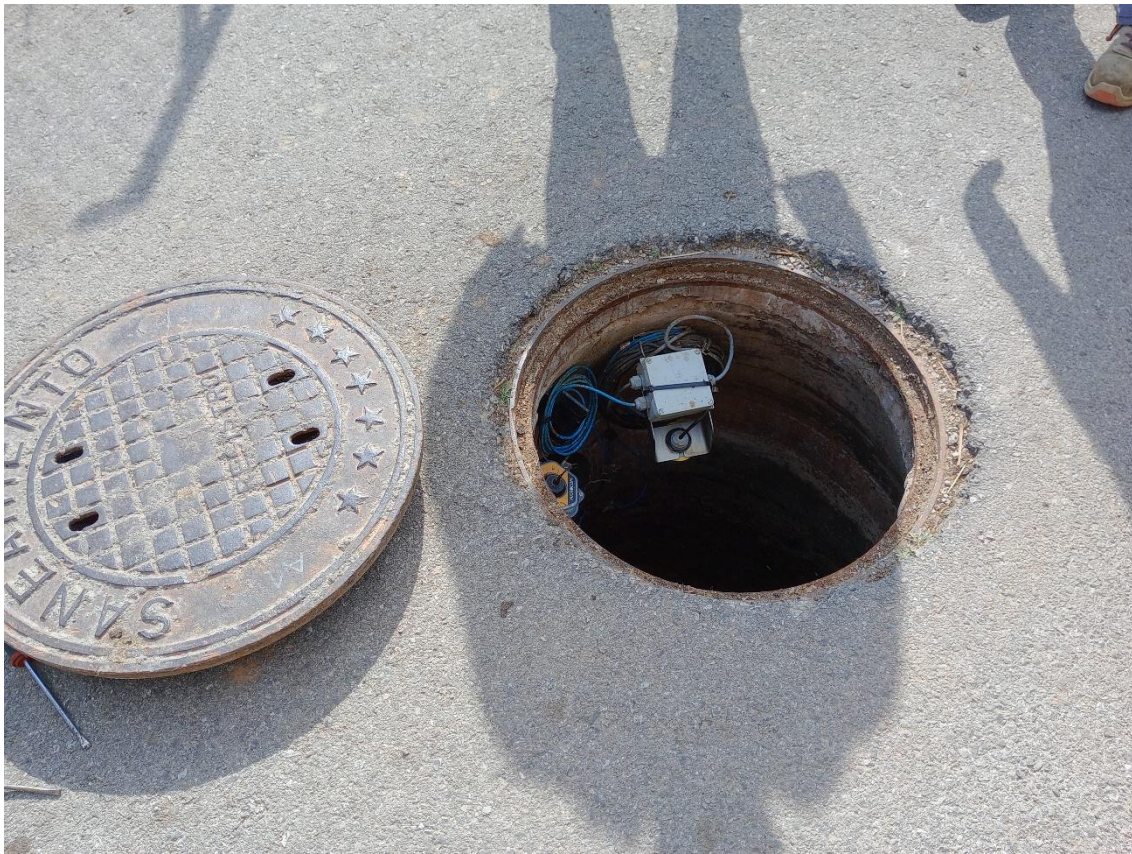
11 PUNTO DE ALIVIO 1 DAÑADO
