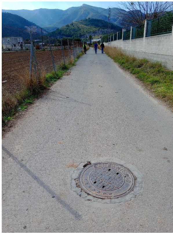
10.1 ARQUETA DE SANEAMIENTO CON DAÑOS SUPERFICIALES
