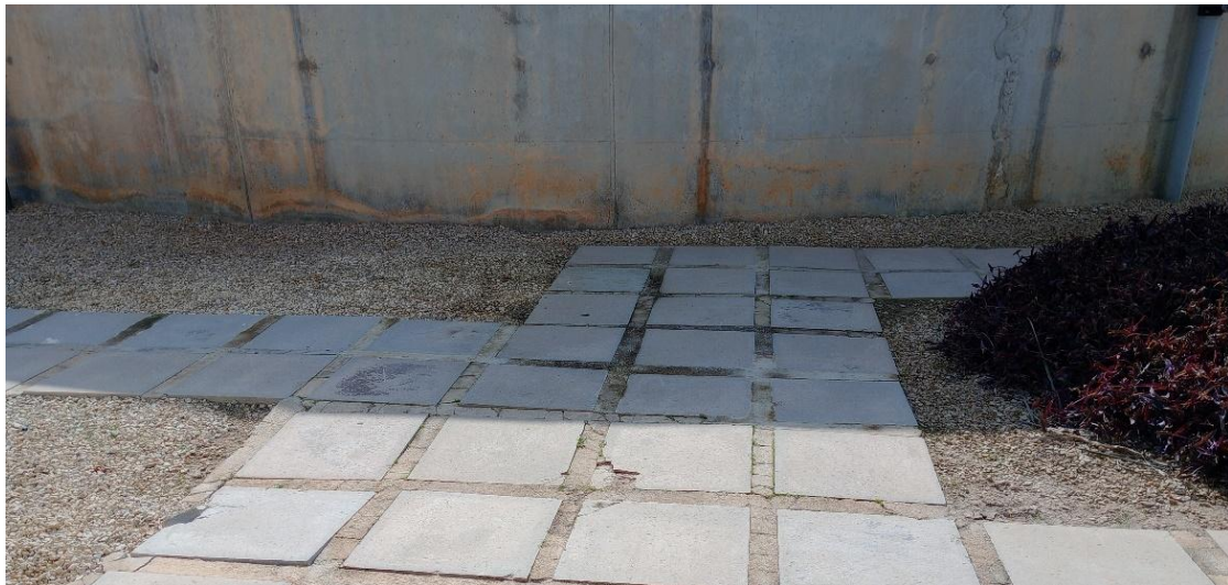
Detalle de losas rotas por el asentamiento
