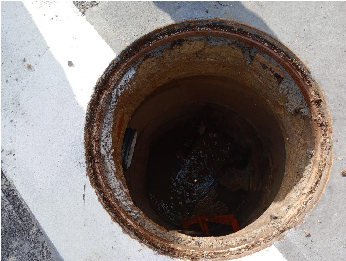
12 DETALLE DE OBRA DAÑADA, PATES DESPRENDIDOS Y PARCIALMENTE ATERRADA
