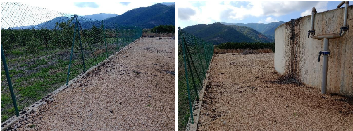
Vallado volcado y apoyos descalzados.
