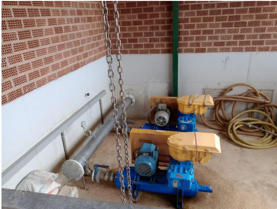
Detalle de los 2 equipos a sustituir.
