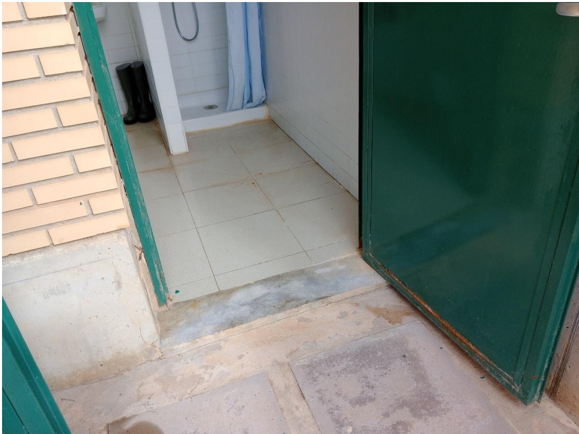
3 PUERTAS DE LOS VESTUARIOS DAÑADAS
