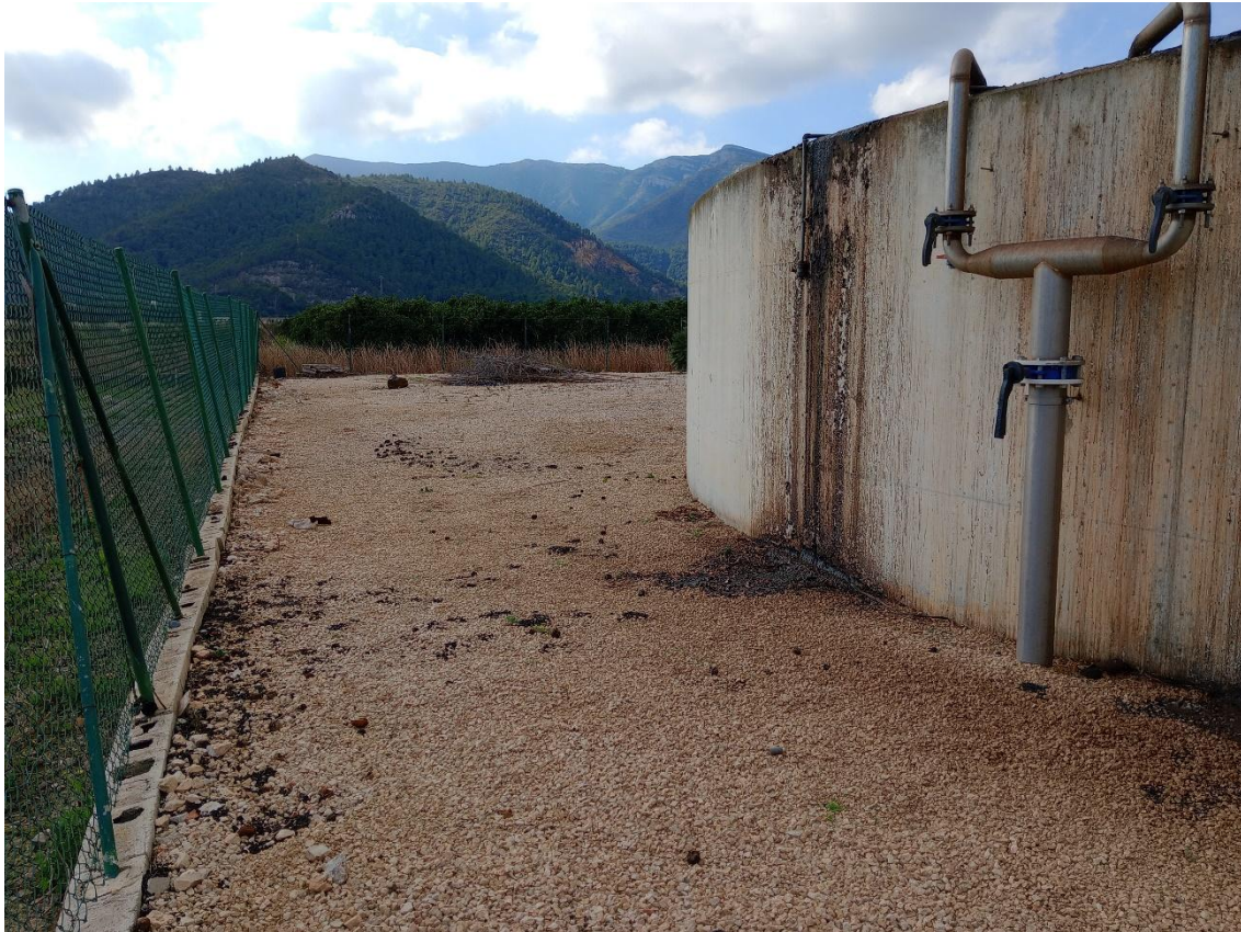
2.2 DETALLE DE APOYO Y VALLA DAÑADOS
