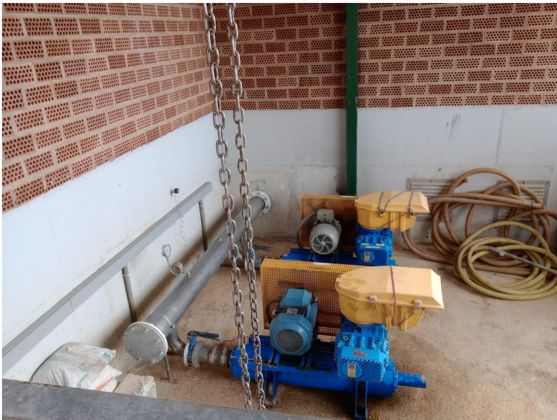
1 SOPLANTES. EQUIPOS DAÑADOS A SUSTITUIR
