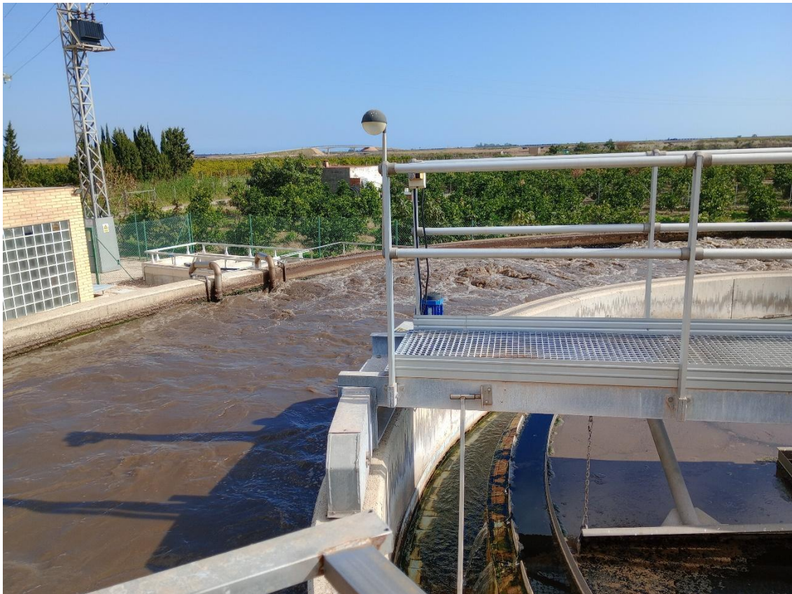
9 DETALLE DE LOS DIFUSORES DAÑADOS DEL DECANTADOR
