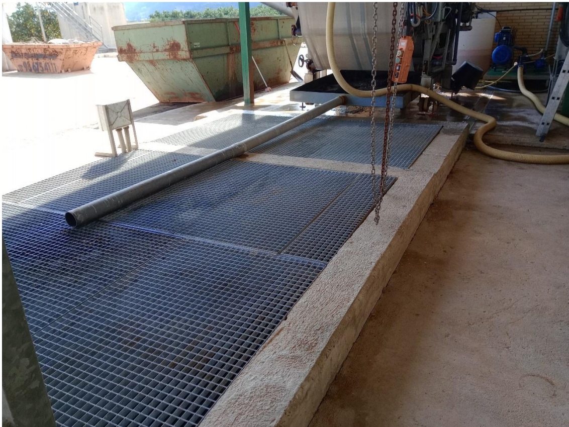
6 TRÁMEX SOBRE BOMBAS A SUSTITUIR
