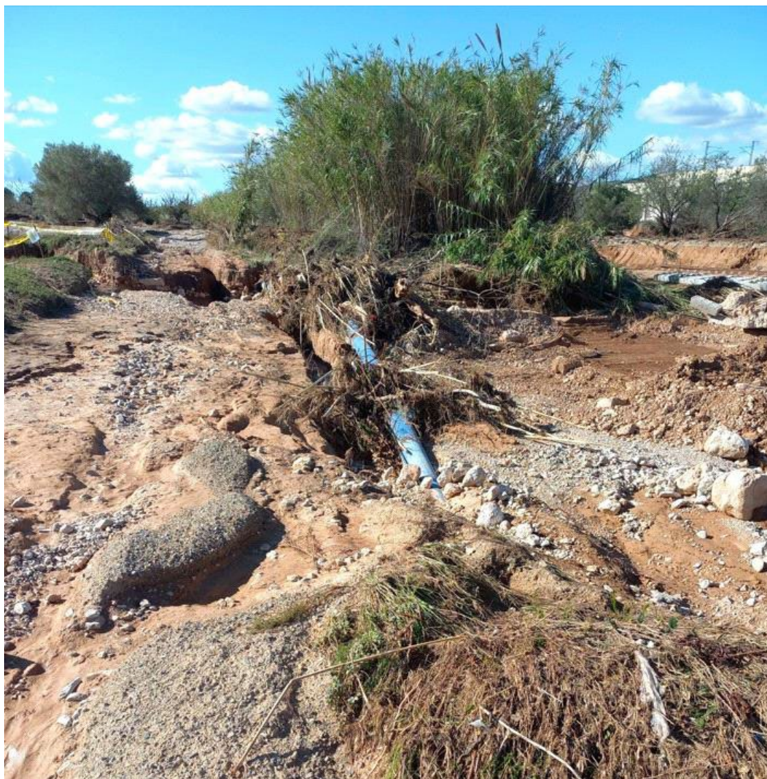
Imagen 3: Conducción afectada La Solana
