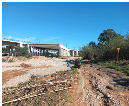
Imagen 5: Conducción afectada La Solana
