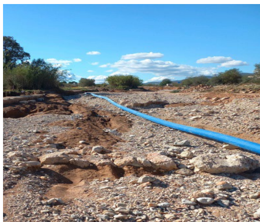
Imagen 4: Conducción afectada La Solana
