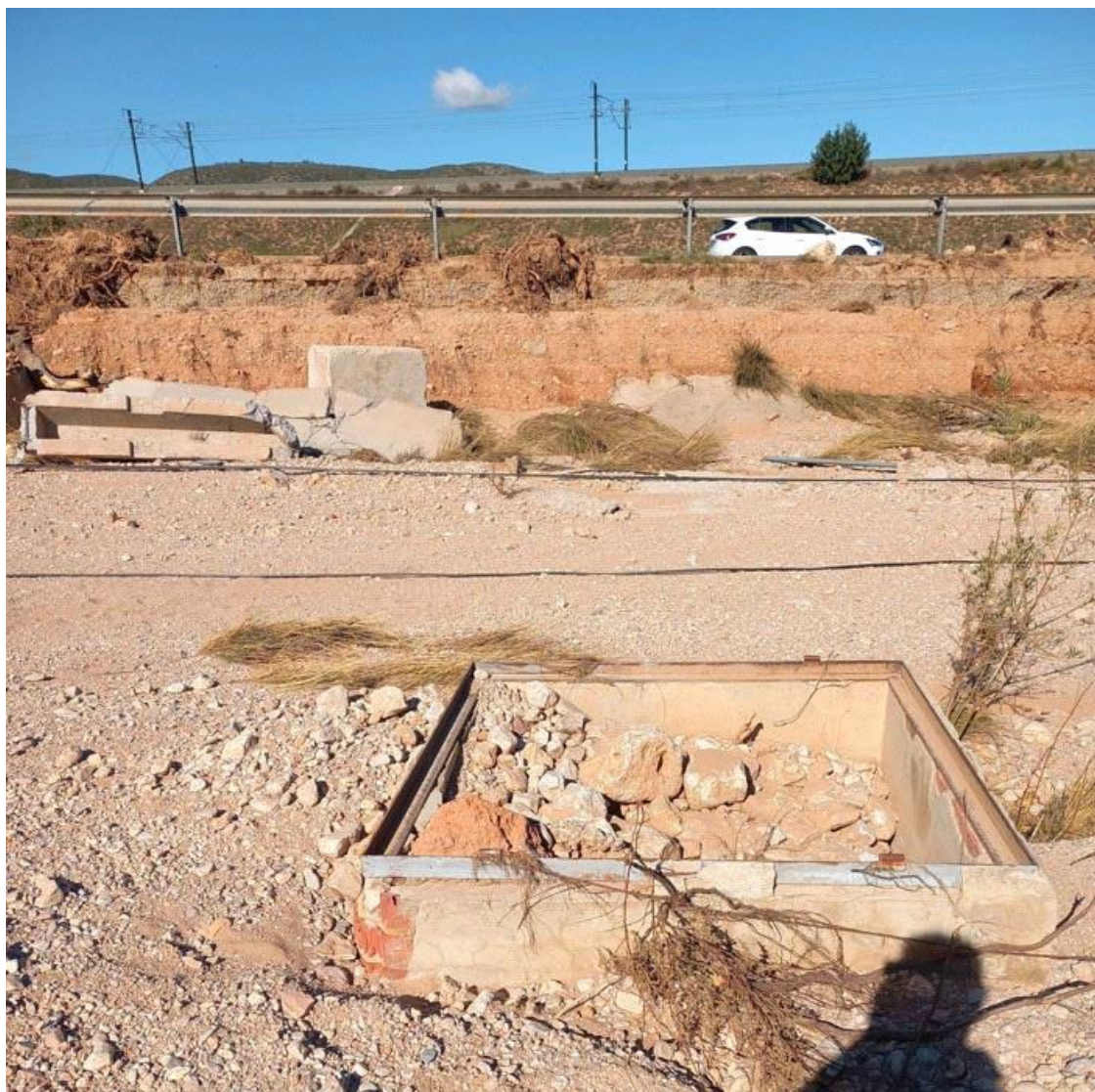
Imagen 1: Arqueta conducción pozo La Solana
