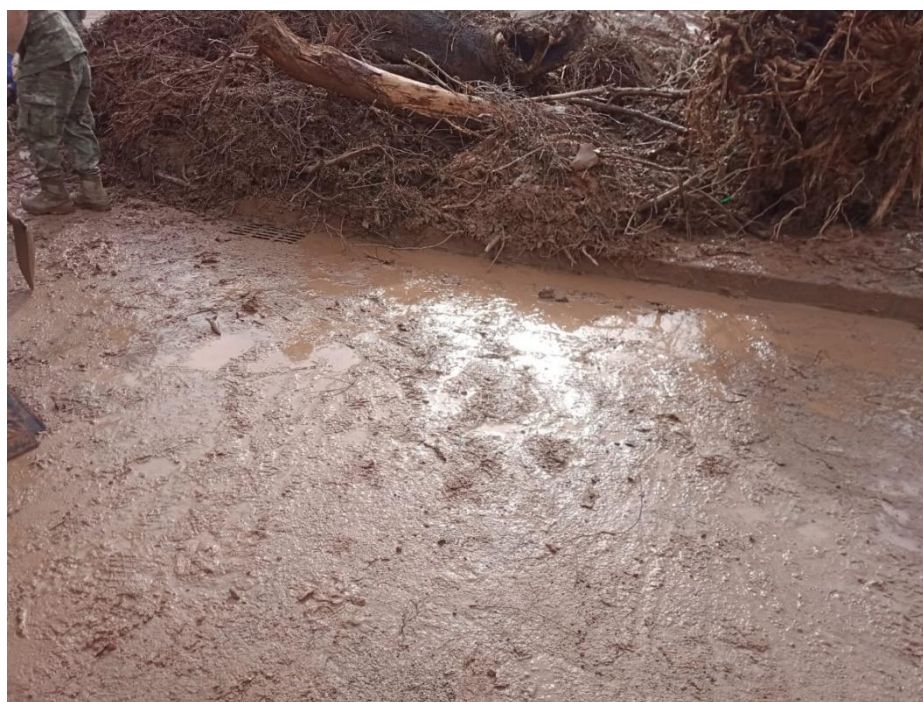
Figura 9. Vista imbornales y acometidas zona afectada DANA
