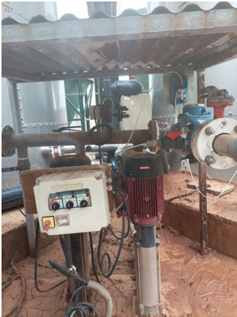
Bombas de agua reutilizada tras la limpieza.
