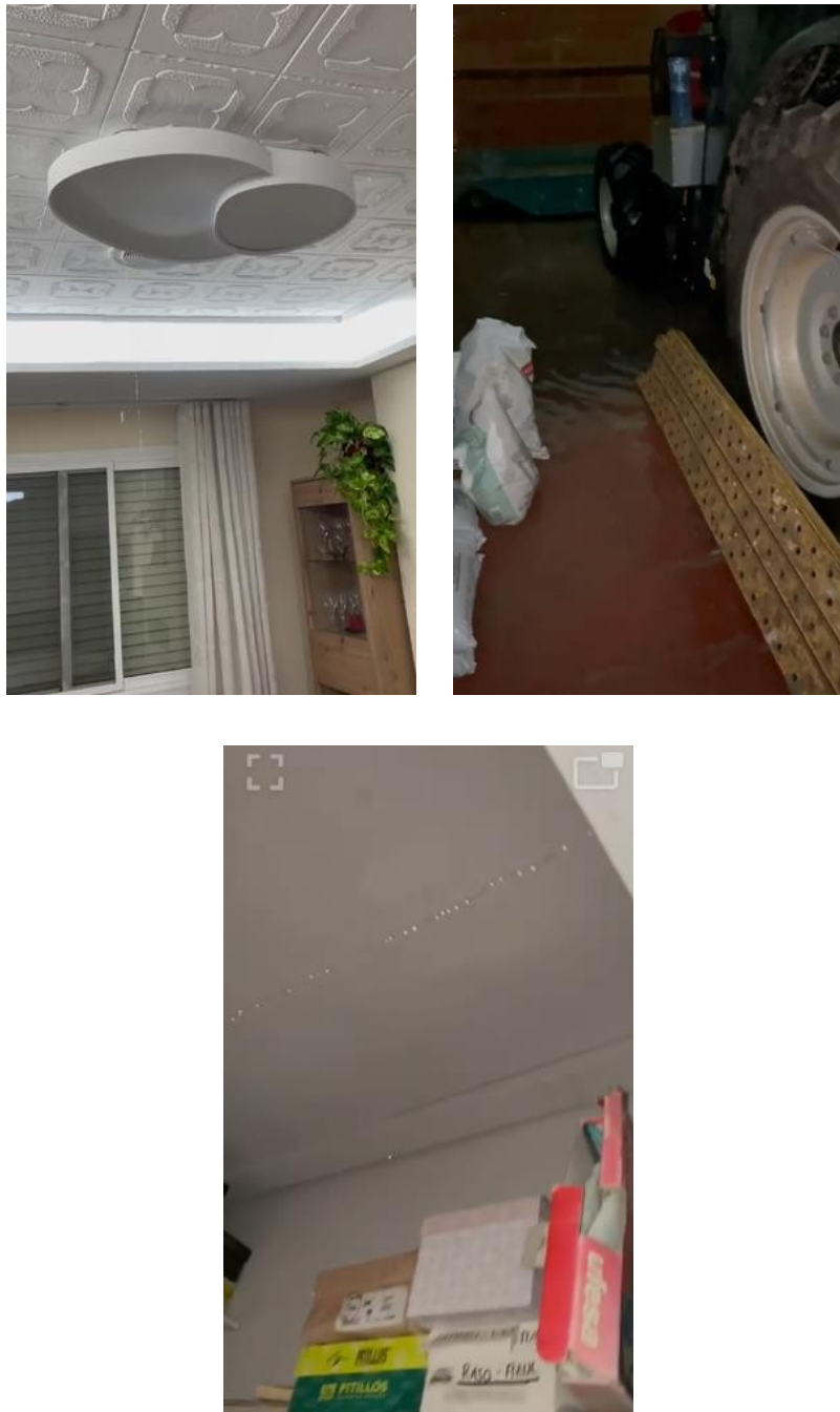
Figura 2. Agua filtrando por los techos y suelo de la vivienda.
