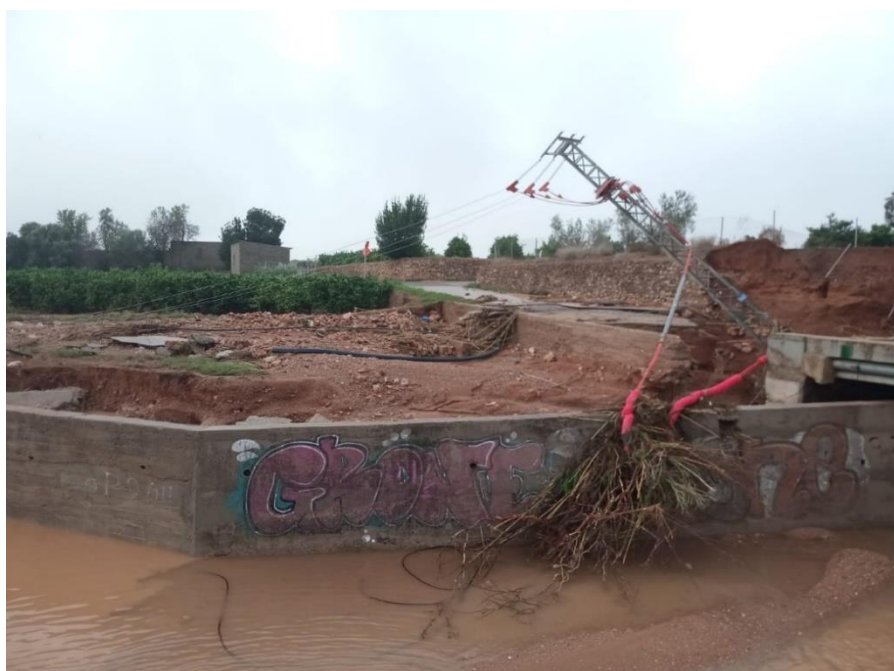
Figura 2. Vista de la tubería de distribución y derrumbe del muro de contención del camino
