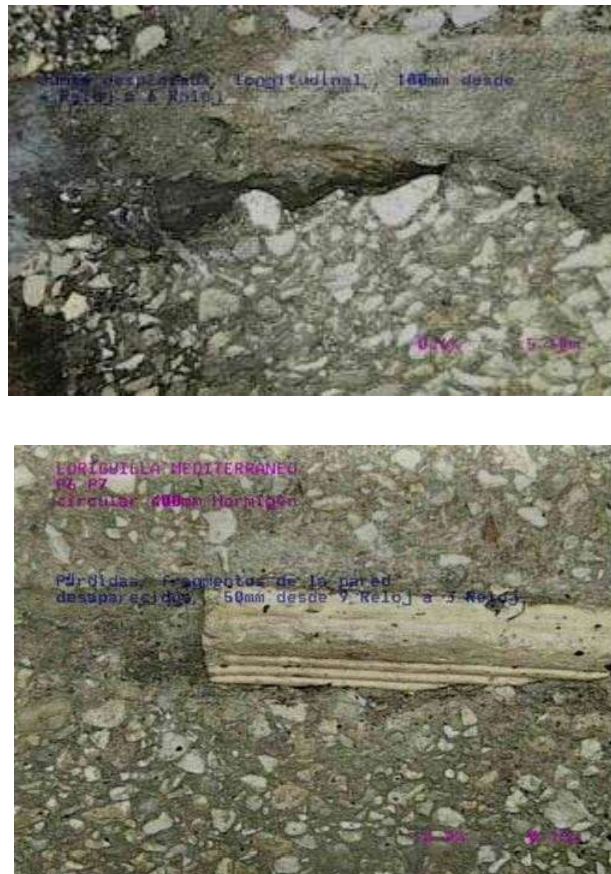
Figura 7. Fisuras por desprendimiento material.
