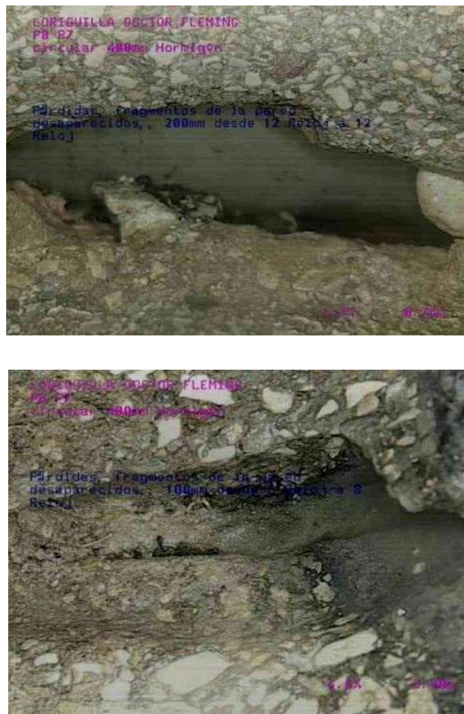
Figura 8. Fragmentos desprendidos del colector por la fuerza y presión del agua.
