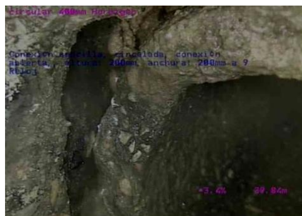
Figura 4. Fragmentos desprendidos del colector por la fuerza y presión del agua.
