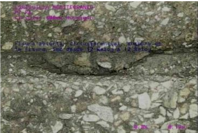
Figura 6. Fisuras por desprendimiento material.
