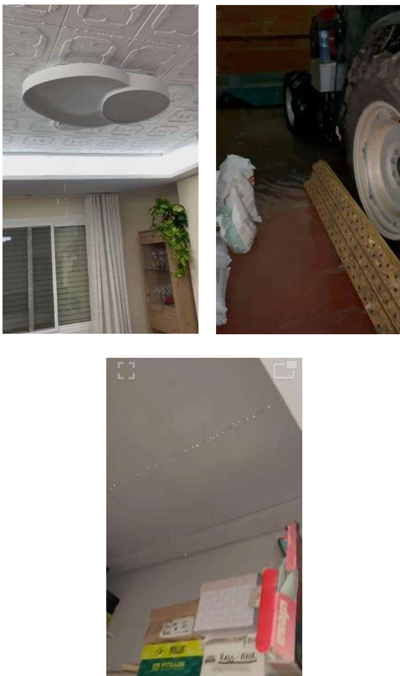
Figura 2. Agua filtrando por los techos y suelo de la vivienda.
