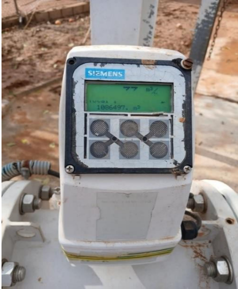
17.-CAUDALIMETRO DE AGUA ENTRADA
