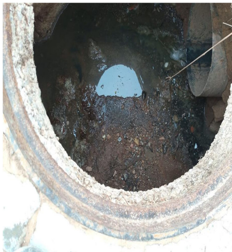
31.-Ejemplo del estado de los pozos después de la Dana
