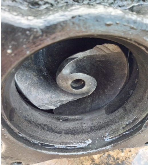
18.-IMPULSOR BOMBA DE ENTRADA
