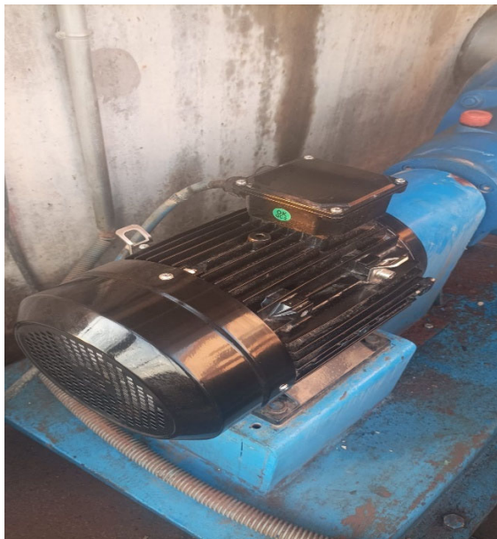
22.-MOTOR BOMBA RECIRCULADORA
