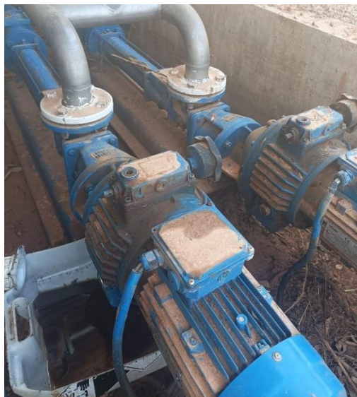
13.-BOMBA DE PURGA
