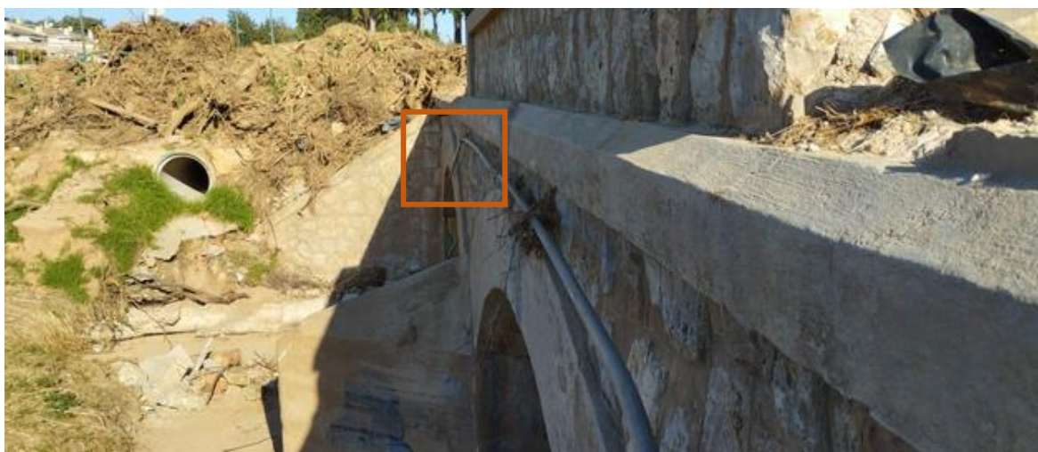
Figura 5. Acometida agua potable de la Estación Ferroviaria a la altura del cruce del barranco.
