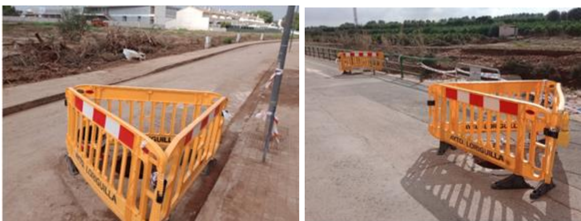
Figura 4. Pozos de registro sin sus tapas correspondientes.
