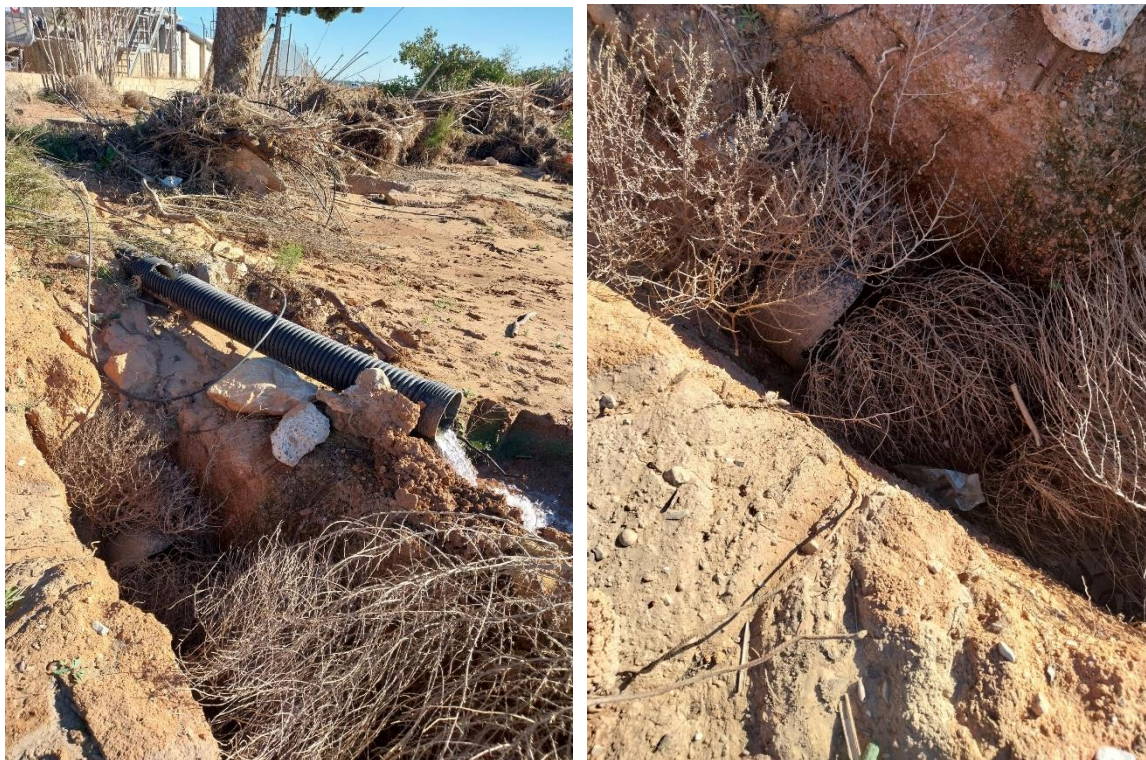
Figura 14. Vista salida aliviadero EDAR Loriguilla
