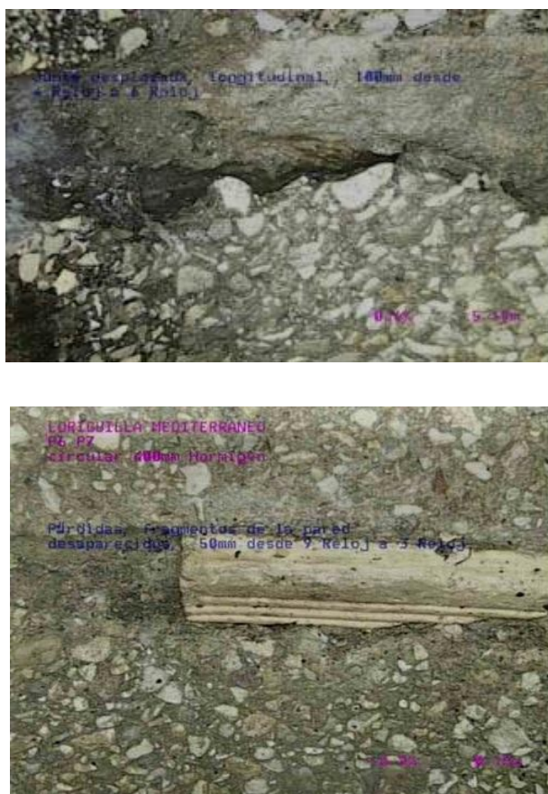
Figura 7. Fisuras por desprendimiento material.
