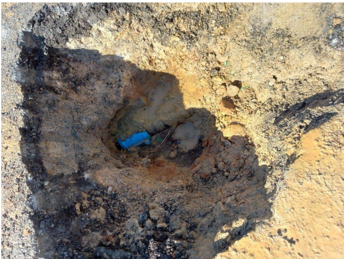
Imagen 4: Estado y Reparación provisional Calle Justo y Pastor
