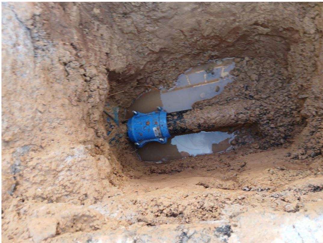
Imagen 2: Estado y Reparación provisional Calle Concheta
