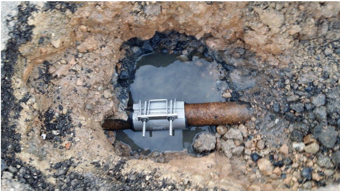
Imagen 3: Estado y Reparación provisional Calle Sagrado Corazón de Jesús
