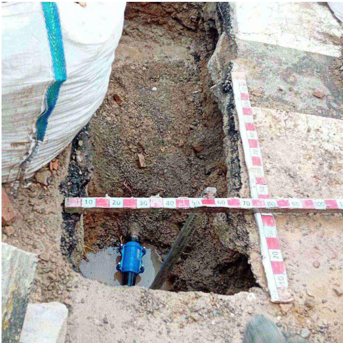
Imagen 5: Estado y Reparación provisional Calle Norte
