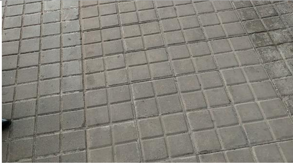
Detalle de pavimento repuesto por la avería en la calle Gregorio Gea
