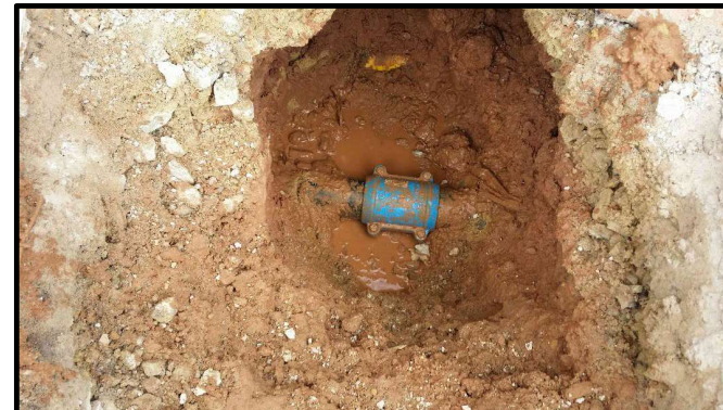
Fotografía 3. Estado actual y reparación provisional calle Vicente Salvatierra
