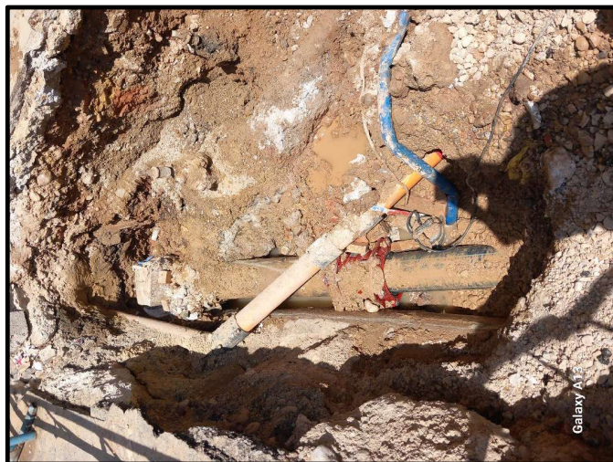
Fotografía 1. Estado actual y reparación provisional calle Lepanto
