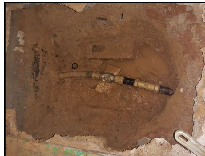
Fotografía 2. Estado actual y reparación provisional calle Vall
