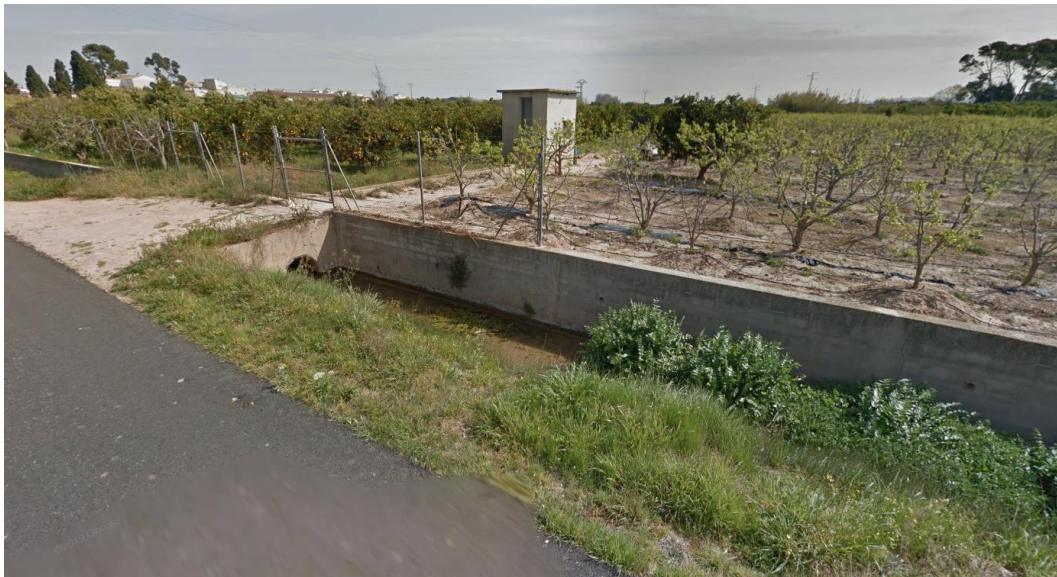
Imagen 5: Cuneta recogida pluviales hasta acequia primera
