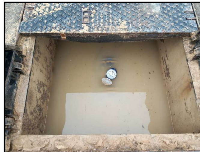
Fotografía nº 3. Estado actual arquetas de sectorización afectadas. Detalle 3.
