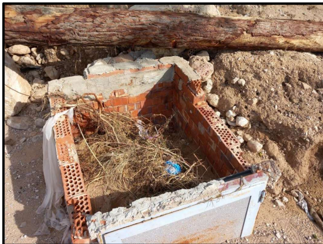
Fotografía nº 1. Estado actual arquetas de sectorización afectadas. Detalle 1.
