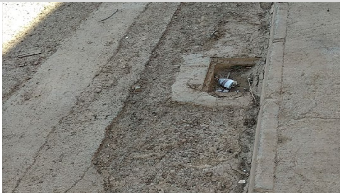
Imbornal destruido y totalmente cegado en la C/ Pintor Joaquín Sorolla.
