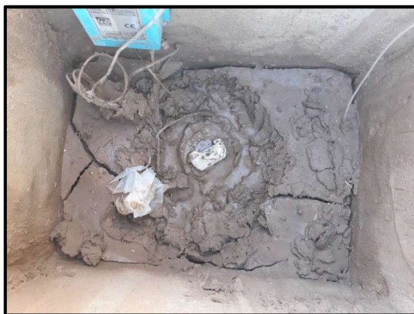
Fotografía nº 2. Estado actual arquetas de sectorización afectadas. Detalle 2.
