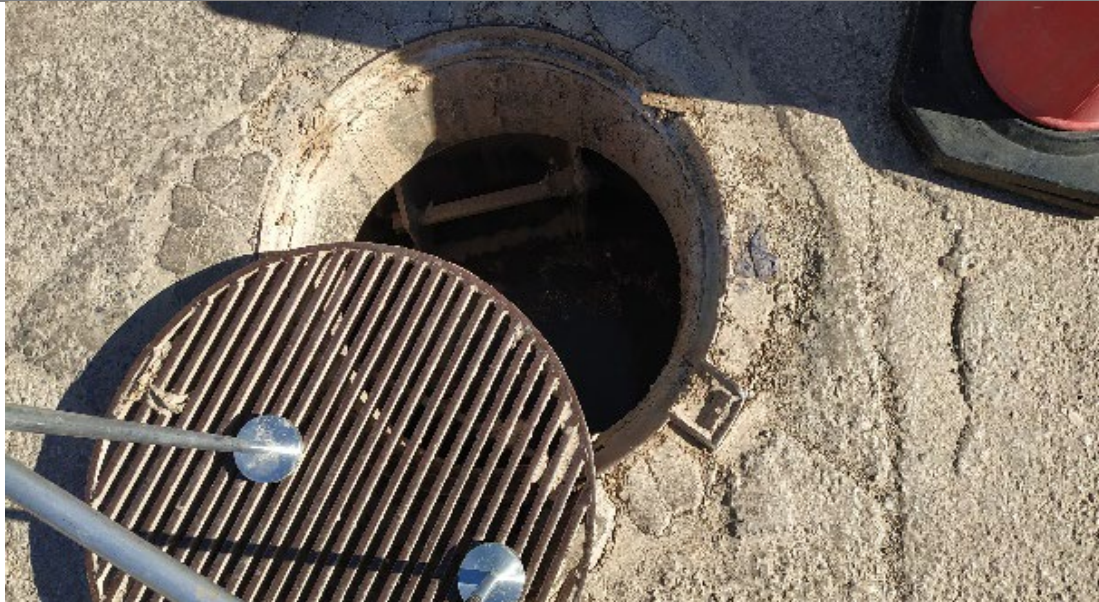
Pozo cegado en la C/ Pintor Joaquín Sorolla. Se aprecia el agua estancada.
