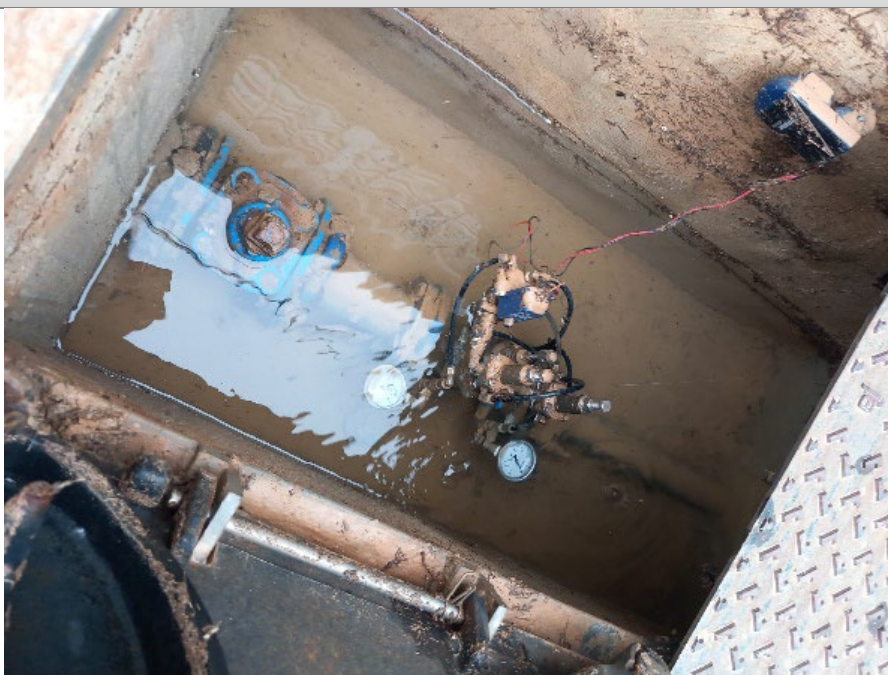
Estado en el que quedaron las arquetas de sectorización afectadas en Quart de Poblet.
