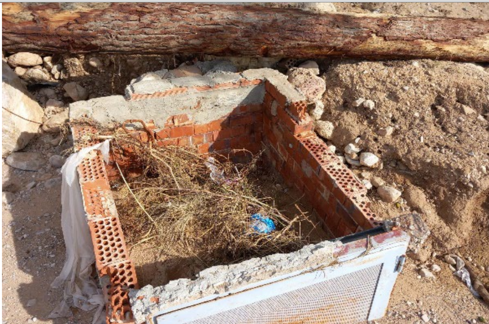
Detalle de arqueta de sectorización afectada
