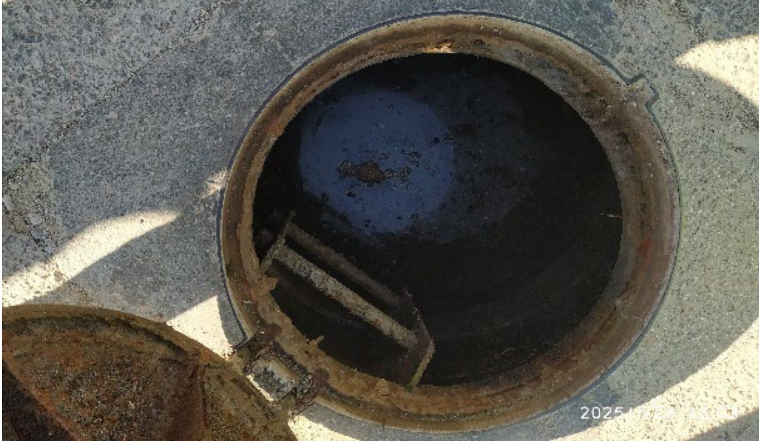
Pozo cegado en la C/ Pintor Joaquín Sorolla. Se aprecia el agua estancada.
