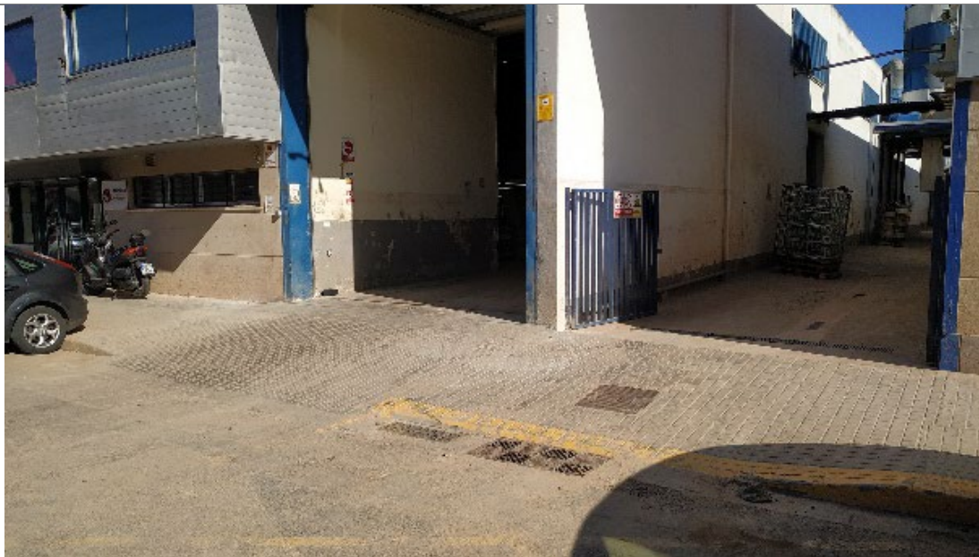
Rejillas cegadas en la C/ Pintor Joaquín Sorolla. Se encuentran atascadas. En los edificios se aprecia la marca de la altura que alcanzó el agua.
