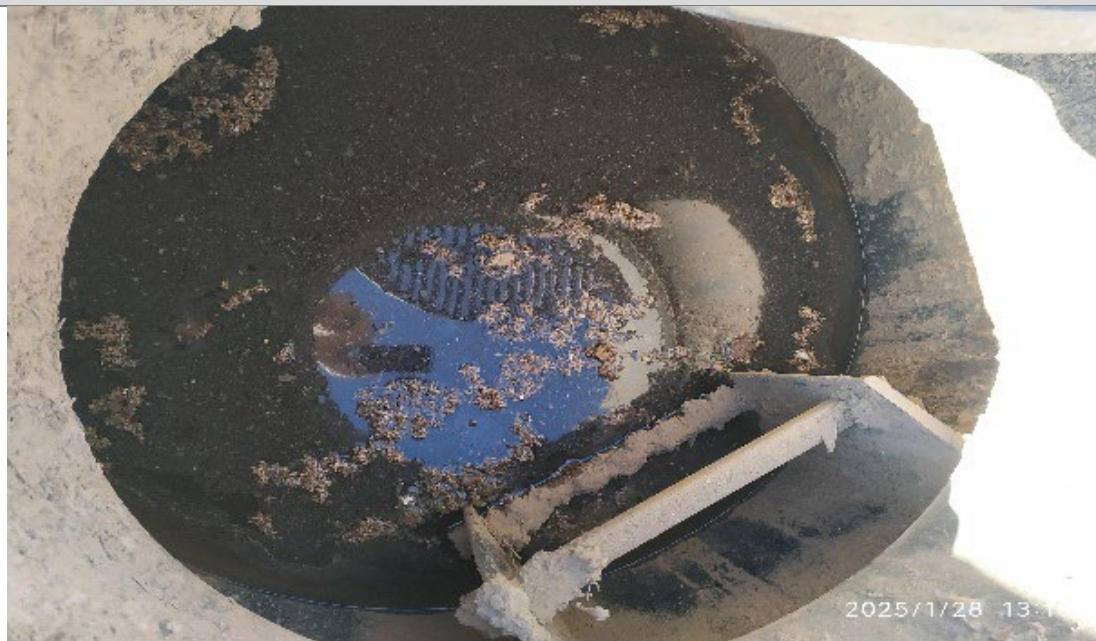
Pozo obstruido en la C/ Pintor Joaquín Sorolla. Se aprecia el agua estancada.
