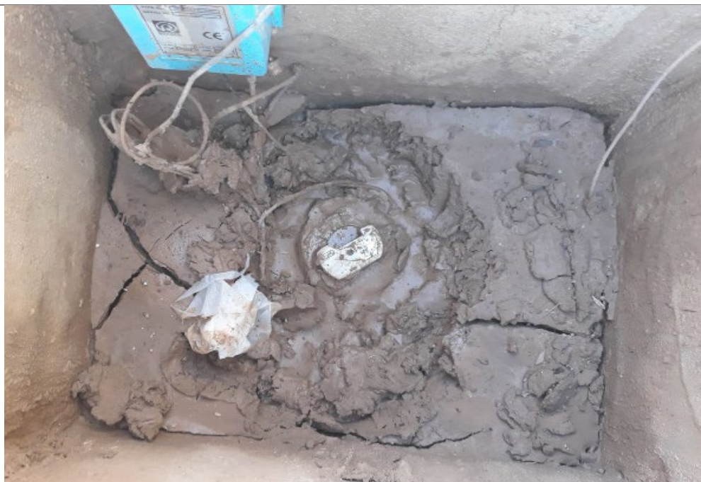
Estado en el que quedaron las arquetas de sectorización afectadas en Quart de Poblet.
