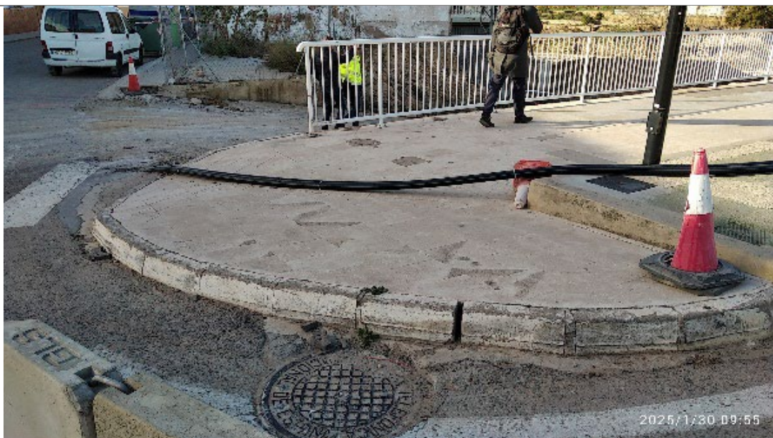
Traída provisional de agua al municipio realizada por la Entidad Metropolitana de Servicios Hidráulicos (EMSHI)
