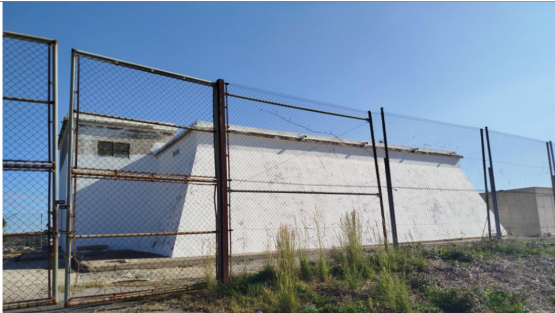
Depósito de agua municipal de Real
