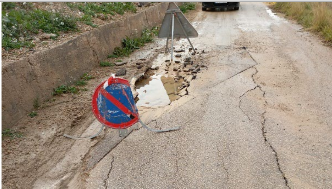
Blandón en vial que implica tubería de abastecimiento con fuga en la subida al depósito
