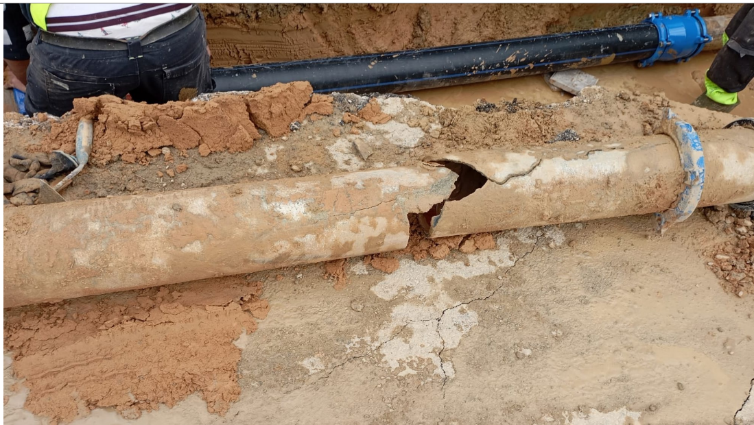
Tubería rota en la subida de abastecimiento de agua municipal al depósito. La canalización puede tener más fisuras, porque la calidad del agua no está garantizada.
