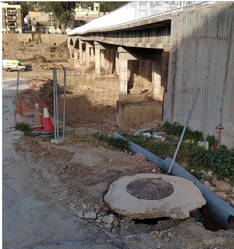
Pozo de saneamiento dañado junto a la pasarela peatonal
