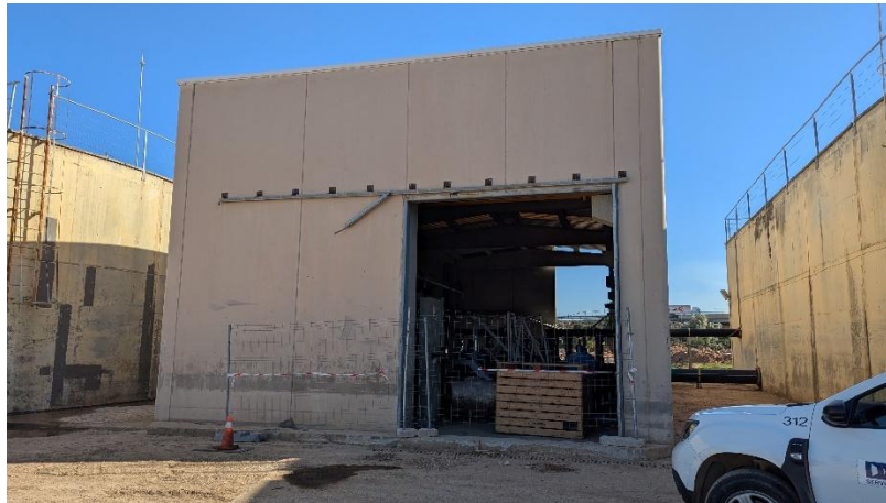
Puerta de entrada a la nave arrancada, falta reposición
