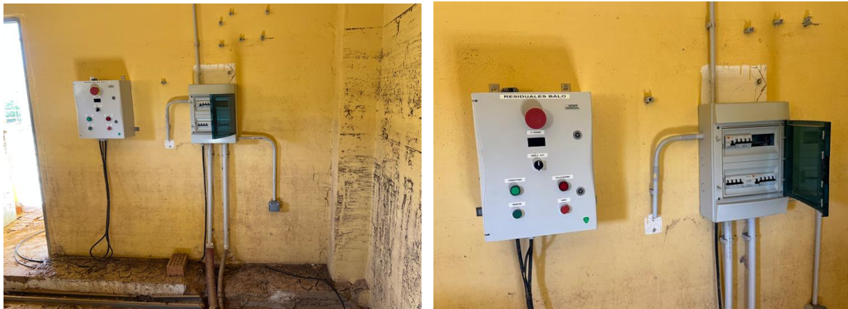
Interior de la estación de bombeo. Cuadros eléctricos de protección y maniobra ya sustituidos
