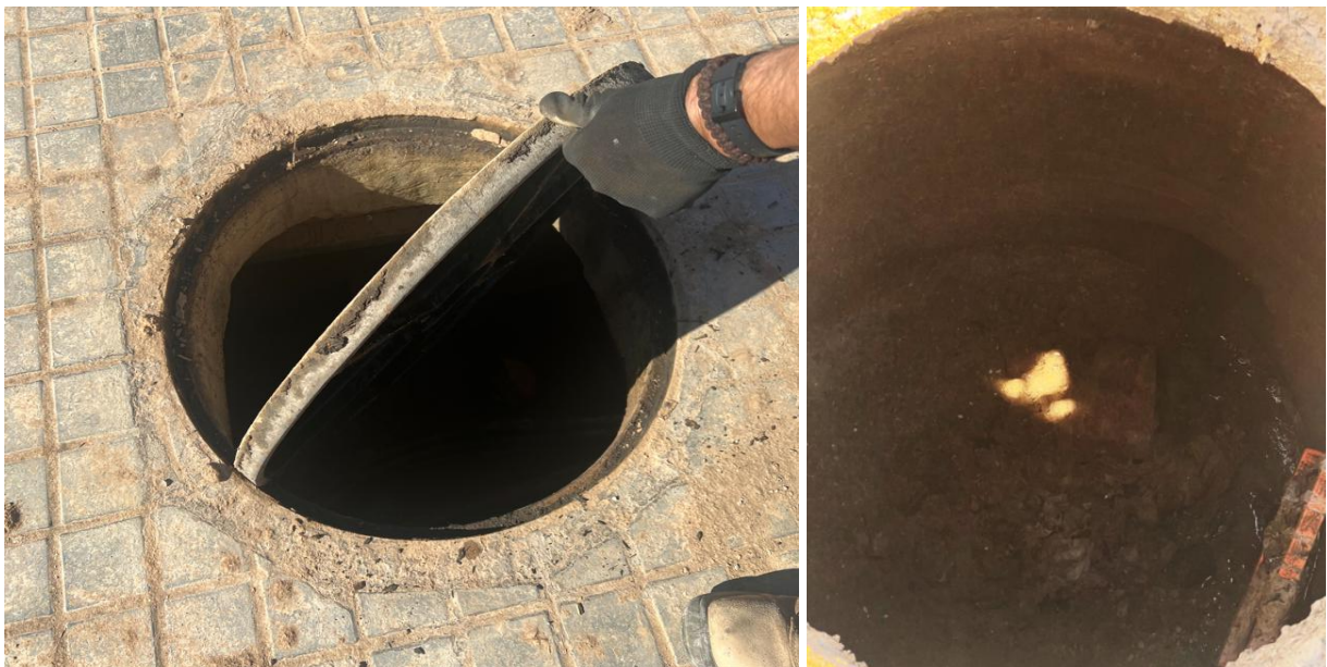
Pozo de registro colmatado en la Av. dels Hostalers en la intersección con Carrer dels Coeters, en el sector 13 del polígono industrial.
