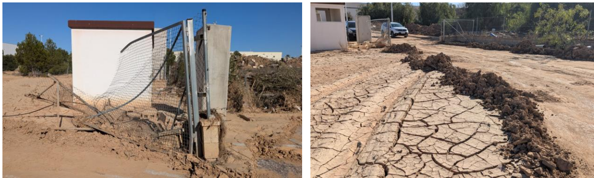
Puerta dañada y acceso a la estación de bombeo
