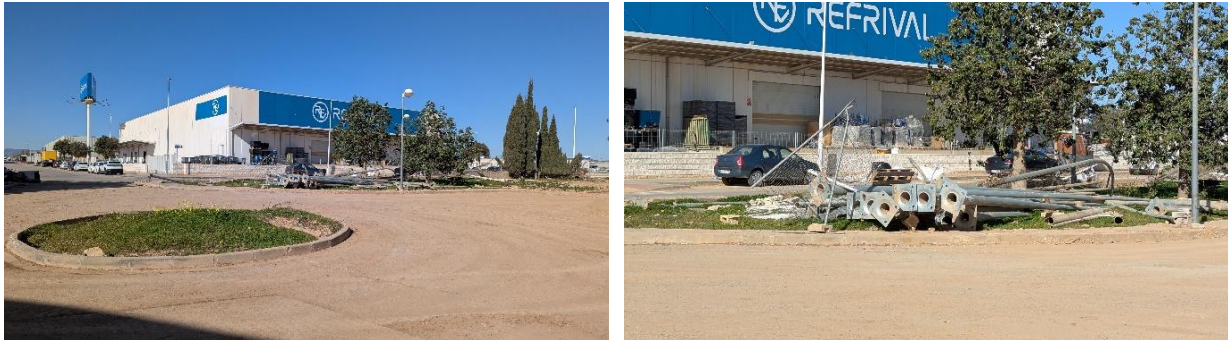
Vallado perimetral de la instalación arrancado, aun sin reponer
