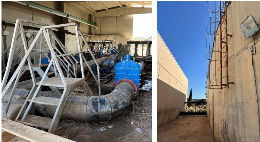
Pasarelas en el interior del edificio y escaleras en la parte exterior de los depósitos dañados
