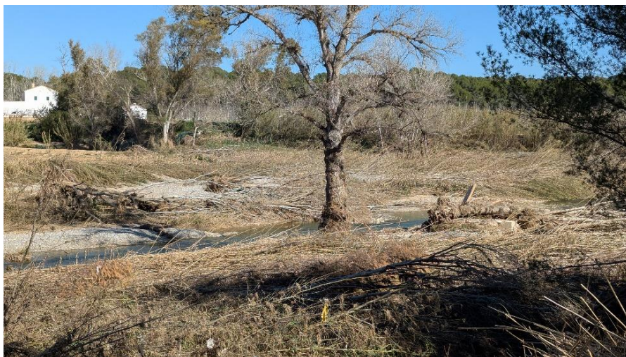
Estado actual de la pasarela, totalmente destruida por la riada
