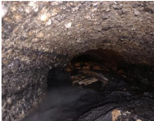
Inspección de cámara tramo aguas abajo. Estado muy deteriorado del tramo
