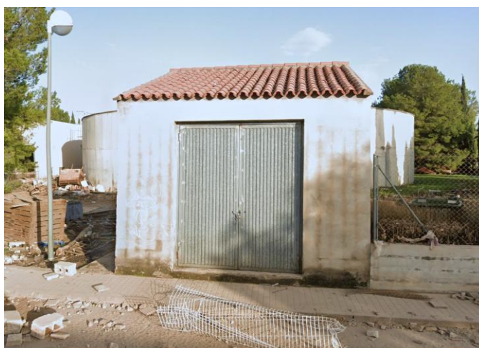
Puerta recolocada del cuarto del grupo electrógeno
