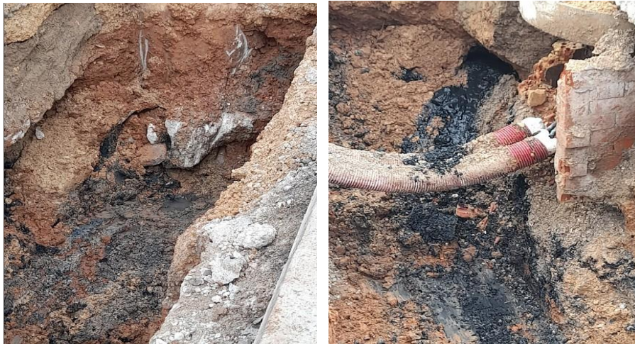
Estado de la red en el primer tramo
