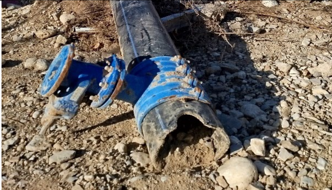
Resto de conducción rota en el lecho del barranco
