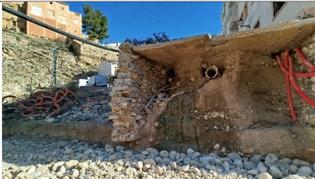
Vista del puente de la tejería destruido con el abastecimiento en precario
