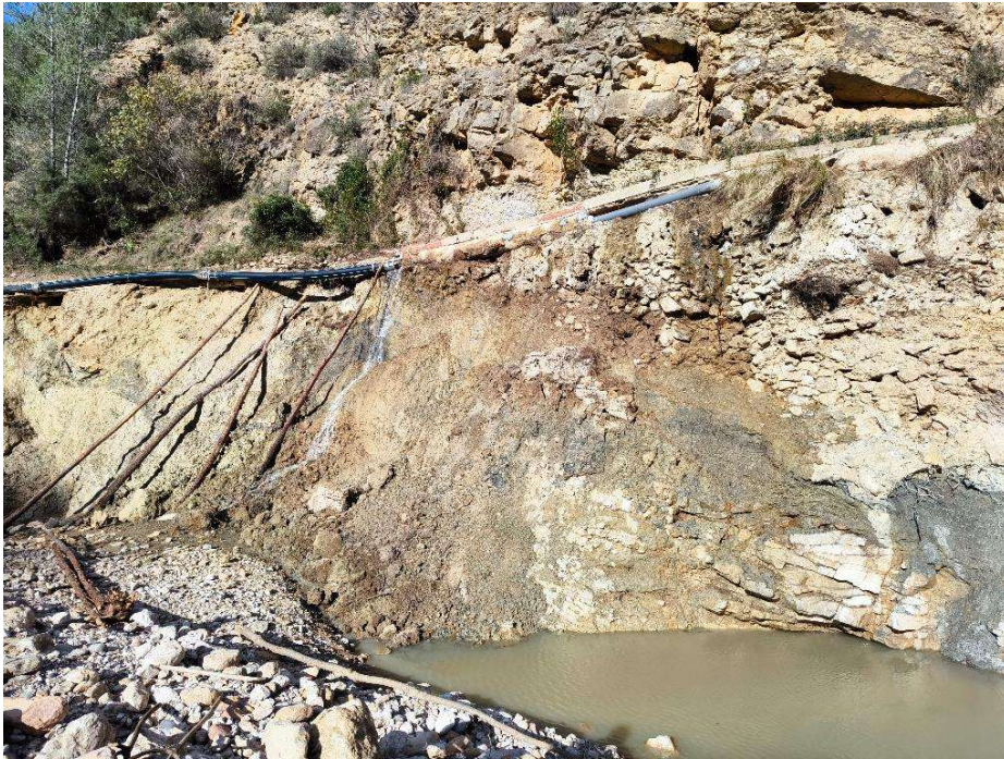
Figura 3. Tubería de abastecimiento "colgada"
