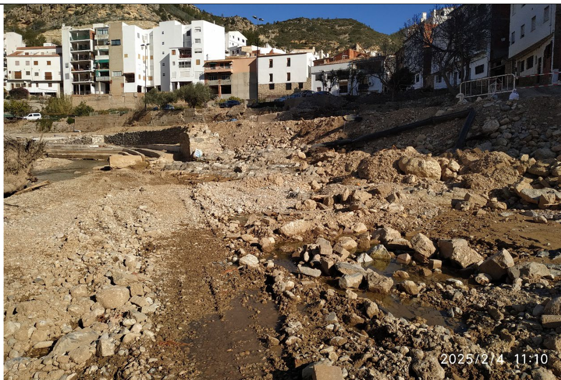
Vista de los restos del estribo de margen izquierda del puente que había aguas arriba del campo de fútbol antes de la DANA. A la derecha del a foto, lo que queda de la calle Ramón y Cajal en la bajada a dicho puente.
