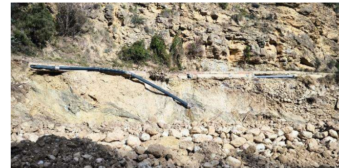
Figura 5. Tubería rota debido a su estado "colgado"
