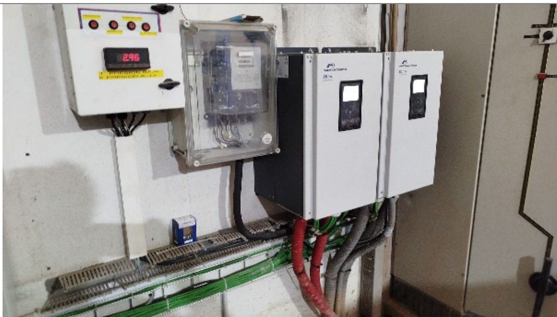
Variadores de frecuencia de las bombas, no parecen haber sido alcanzados por la inundación
