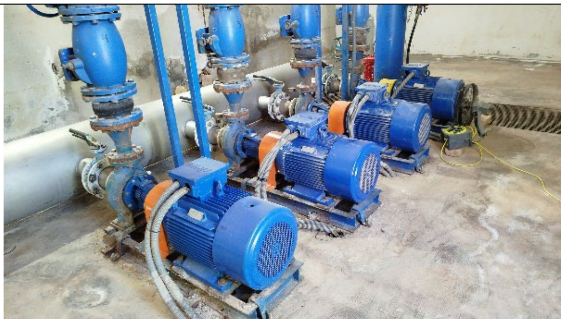
Bombas dañadas en el bombeo desde el depósito viejo hasta la red principal
