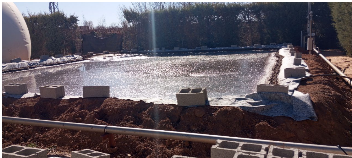
Imagen 1: Balsa de lodos provisional EDAR UTIEL
