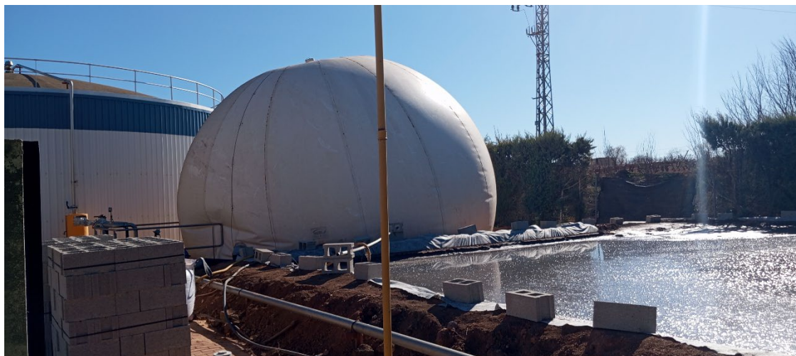
Imagen 2: Balsa de lodos provisional EDAR UTIEL
