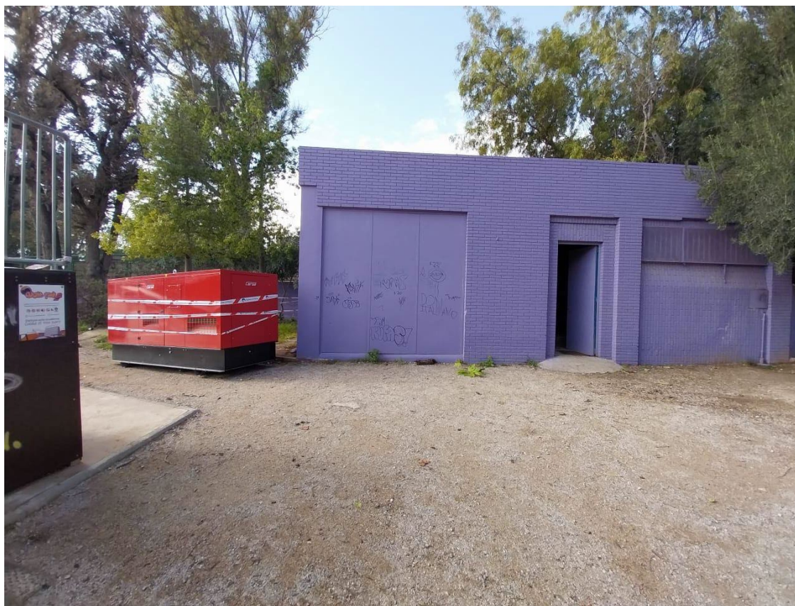
Imagen 2: Grupo electrógeno provisional EBAP
