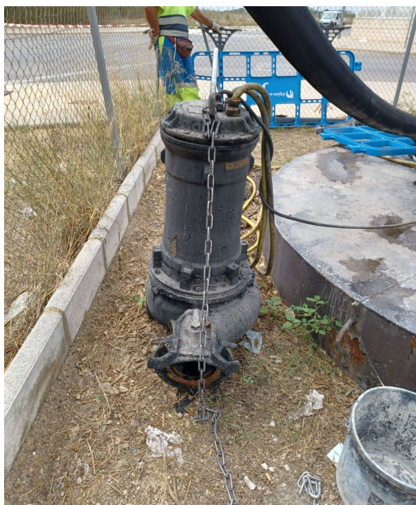
Imagen 6: Bomba EBAR Oficis
