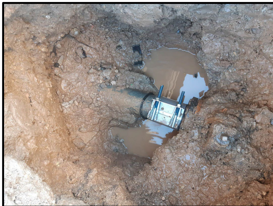
Fotografía nº 1. Estado actual y reparación provisional calle Castelló
