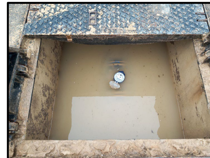
Fotografía 3. Estado actual arquetas de sectorización afectadas. Detalle 3.
