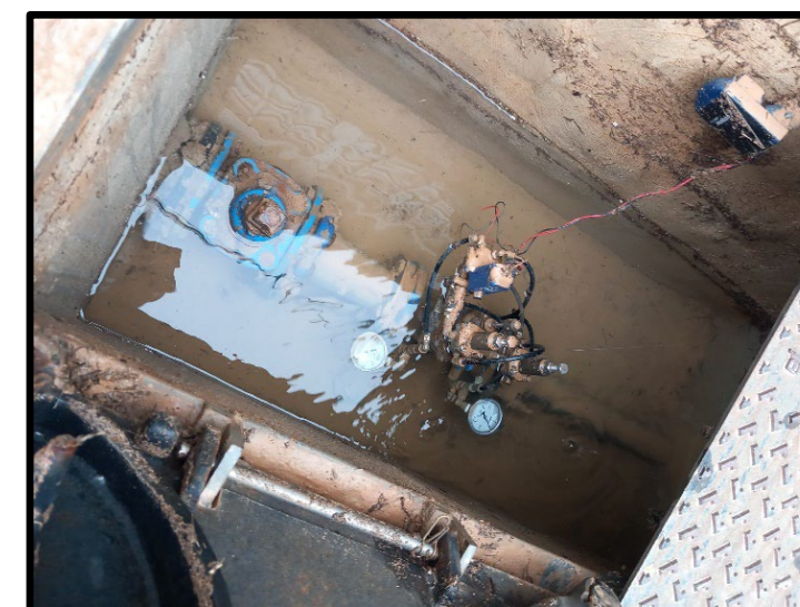
Fotografía 4. Estado actual arquetas de sectorización afectadas. Detalle 4.
