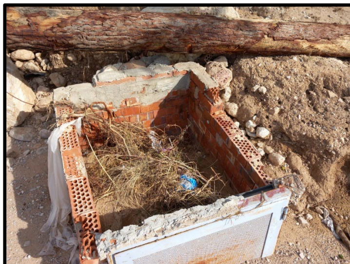
Fotografía 1. Estado actual arquetas de sectorización afectadas. Detalle 1.
