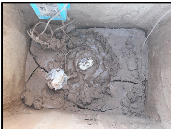
Fotografía 2. Estado actual arquetas de sectorización afectadas. Detalle 2.
