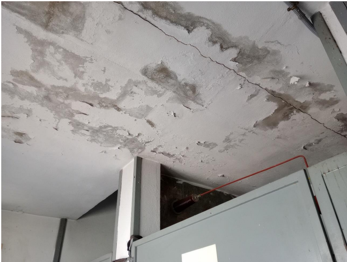
3. CENTRO DE TRANSFORMACIÓN. DAÑOS POR FILTRACIONES EN CUBIERTA (3)
