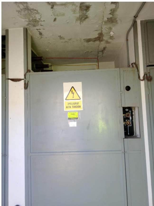
3. DAÑOS POR FILTRACIONES EN LA CUBIERTA (1)
