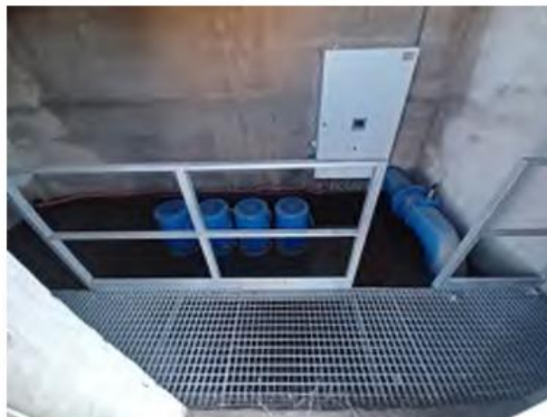
Sala del grupo de bombeo completamente inundada
