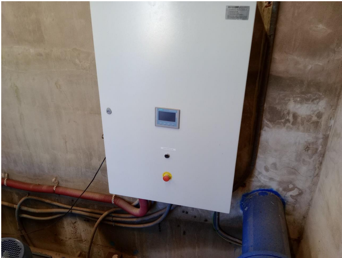
CUADRO DE ACCIONAMIENTO ELÉCTRICO DAÑADO
