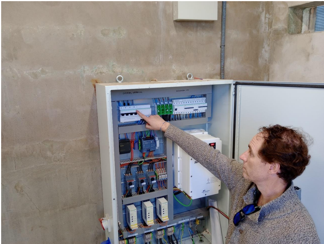
CUADRO DE ACCIONAMIENTO. ELEMENTOS ELÉCTRICOS DAÑADOS
