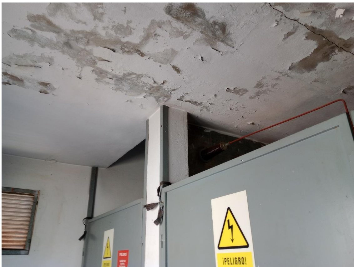
3. CENTRO DE TRANSFORMACIÓN. DAÑOS POR FILTRACIONES EN LA CUBIERTA (2)
