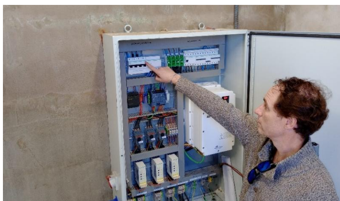
Detalle de elementos cambiados en el cuadro eléctrico.
