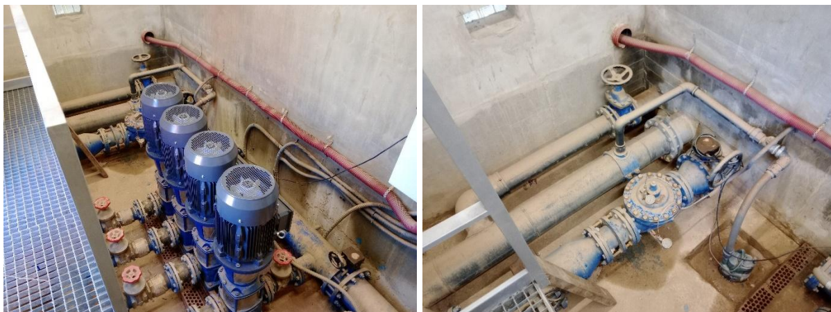
Detalle de los cuatro motores cambiados y las huellas que todavía quedan de la inundación registrado.
