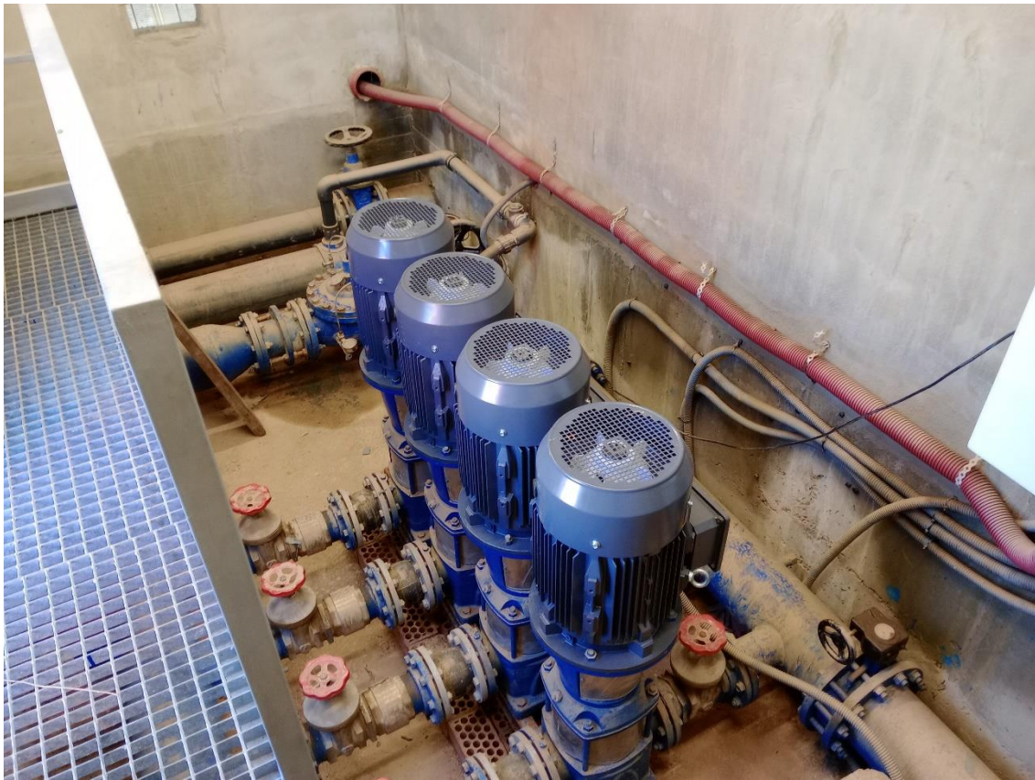
BOMBAS DAÑADAS Y SUSTITUIDAS
