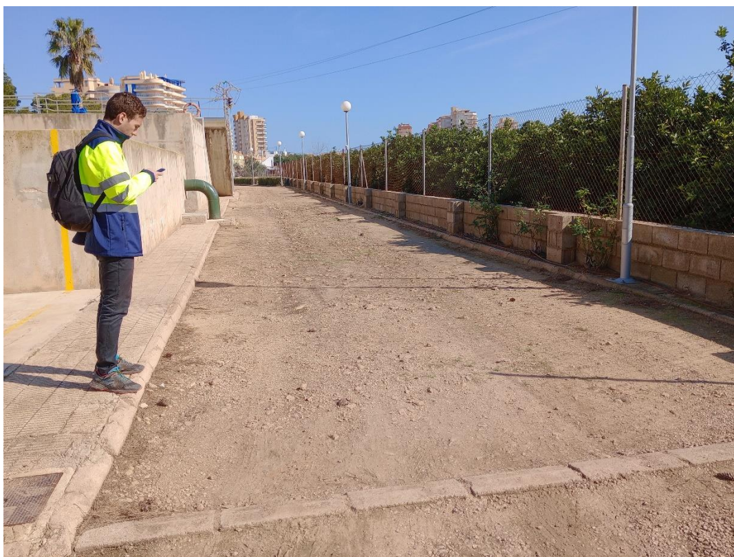
2. SECCIÓN DE CAMINO DETERIORADO
