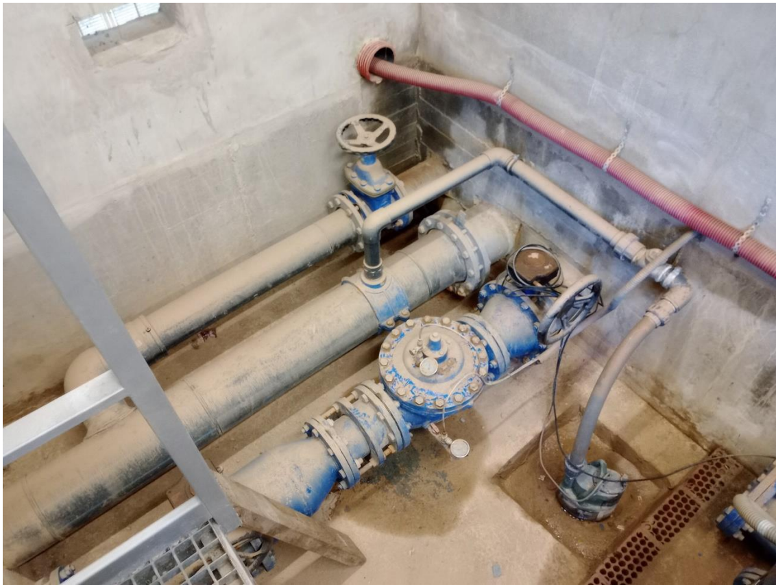
RESTOS DE LA INUNDACIÓN EN LAS TUBERÍAS
