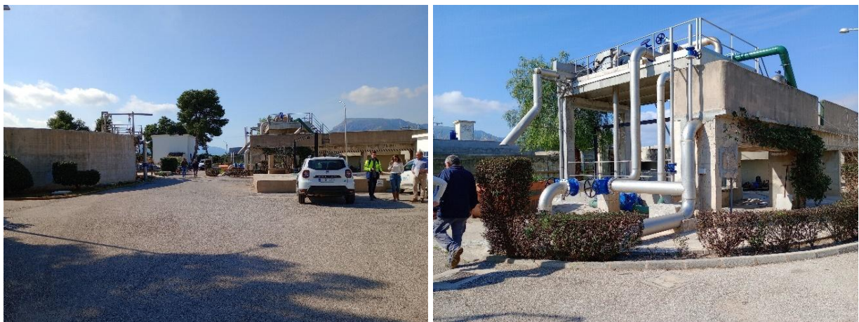
Instalaciones de la depuradora ya operativa.
