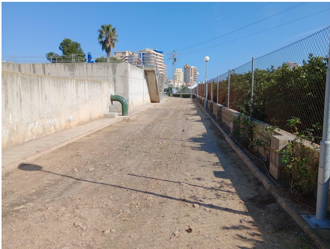
1. SECCIÓN DE CAMINO DETERIORADO
