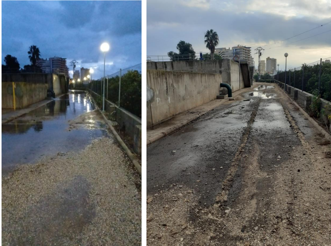
Detalle de la inundación del camino y del barro arrastrado.
