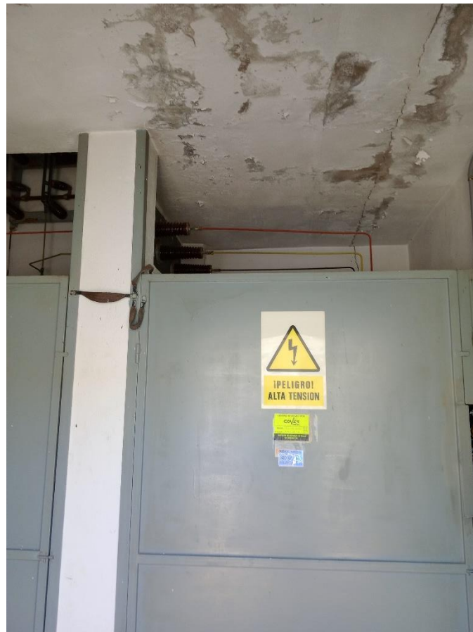
3. CENTRO DE TRANSFORMACIÓN. DAÑOS POR FILTRACIONES EN CUBIERTA (4)
