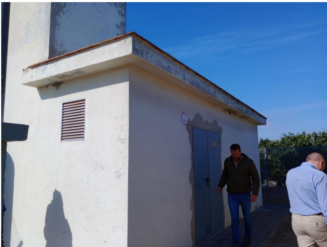
2. EXTERIOR DEL CENTRO DE TRANSFORMACIÓN
