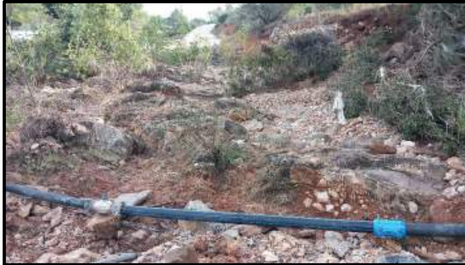
Fotografía nº 1. Tubería afectada Creuetes 1
