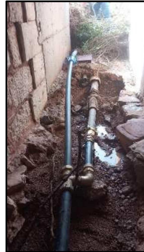
Fotografía nº 3. Tubería afectada y bypass provisional Creuetes 2
