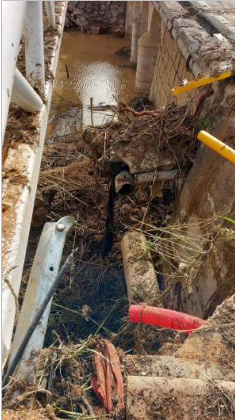
Fotografía 1. Tubería general de abastecimiento a Vilamarxant de fibrocemento DN300 afectada en el cruce del Barranco La Teulada
