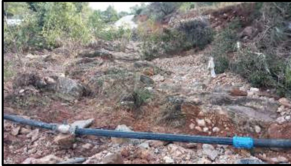
Fotografía nº 1. Tubería afectada Creuetes 1
