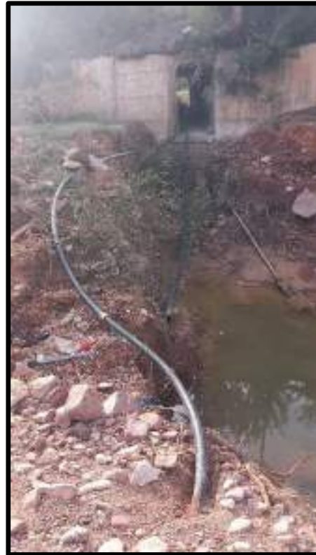
Fotografía nº 2. Tubería afectada Creuetes 2
