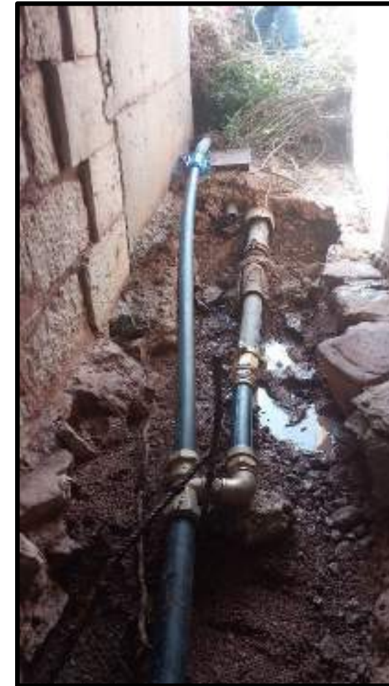
Fotografía nº 3. Tubería afectada y bypass provisional Creuetes 2
