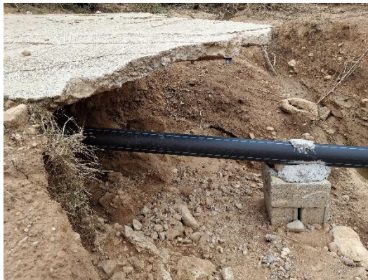
Daños en tuberías de Urbanización Masía Pavía (anclado mediante dados de hormigón de forma provisional)
