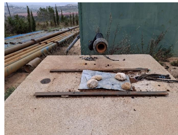
Bomba Pozo el Rafol
