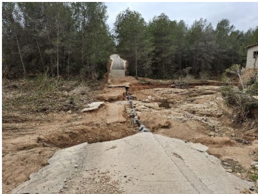
Daños en tuberías de Urbanización Masía Pavía (anclado mediante dados de hormigón de forma provisional)
