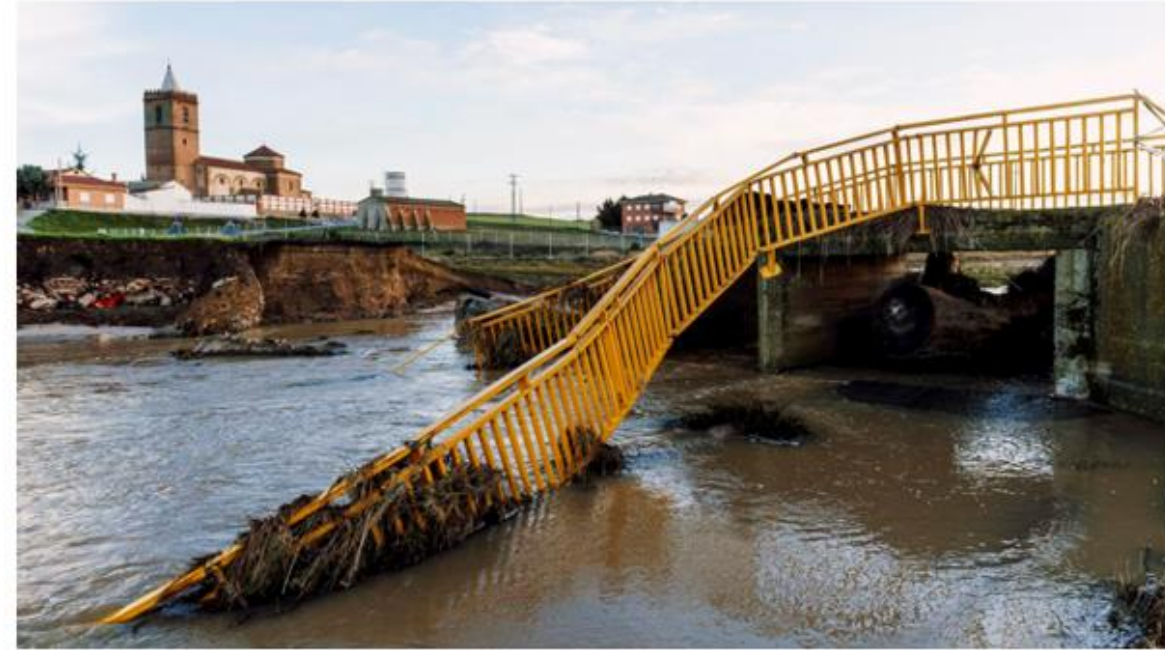
Puente sobre el río Zapardiel derribado por la crecida en el t.m. de Císla
