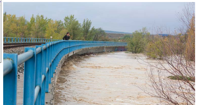
Figura 5.3. Crecida de octubre de 2012 chocando con el tablero del puente.
