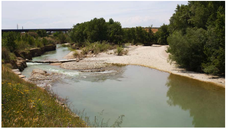
Figura 5.7. Tras la crecida (18 mayo 2018) con el gasoducto colgando
