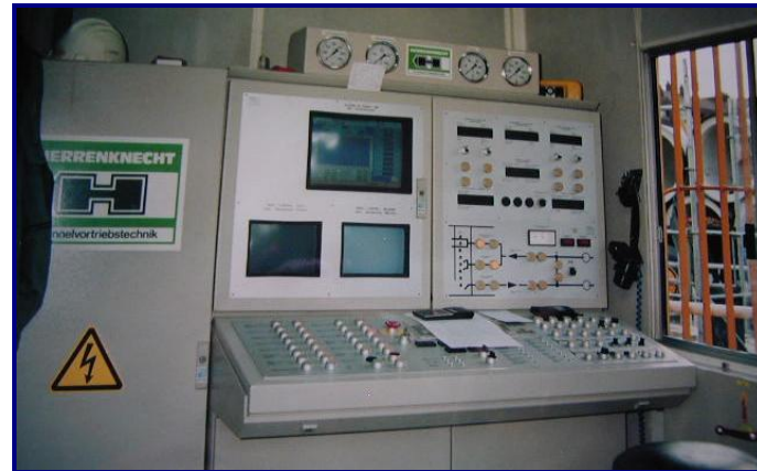
Imagen 29. Cabina de mando y control
