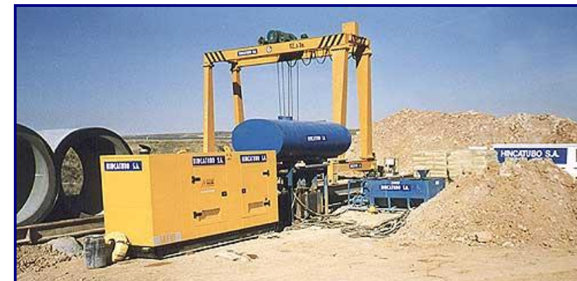
Imagen 10. Generador de corriente auxiliar para dotar de energía eléctrica a la tuneladora
