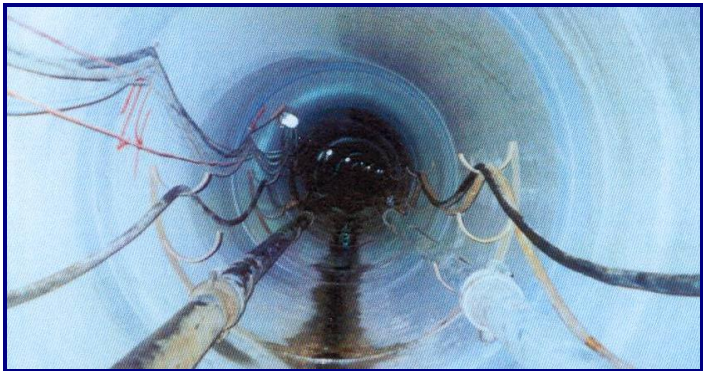
Imagen 27. Circuito de transporte de lodos, por el interior de la tubería
