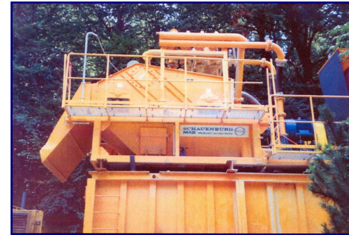
Imagen 32. Desarenador de ciclones
