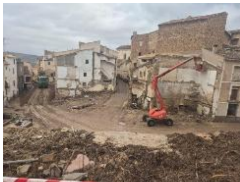
Figura 40. Estado de la plaza de Las Moreras tras las labores de desescombro, fotografía tomada desde donde se situó el edificio que colapsó
