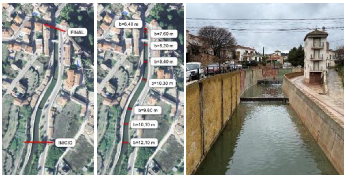
Figura 15. Ubicación (izquierda), diferentes anchuras (centro) y estado actual del encauzamiento (derecha)
