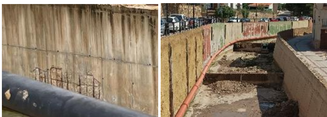
Figura 25. Desperfectos en los cajeros del encauzamiento (izda.) y en la solera (dcha.)
