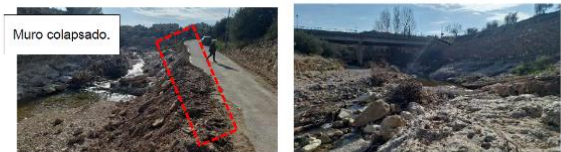
Figura 57. Detalle muro destruido por las inundaciones en el camino de San Antón. Aguas arriba de Letur
