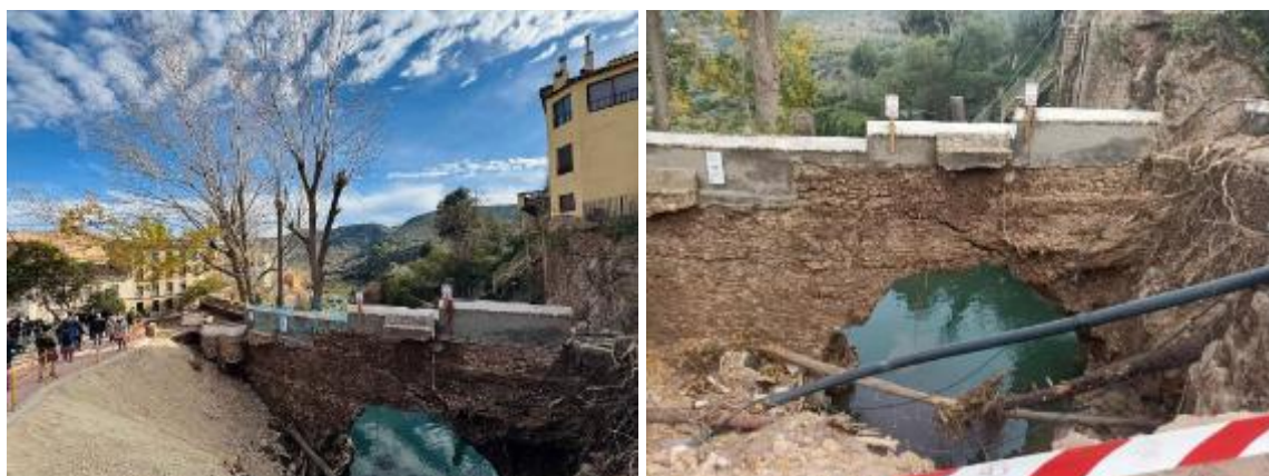
Figura 36. Socavón relleno en la calle Moreras. Daños en el muro originados por el flujo al caer en las pozas
