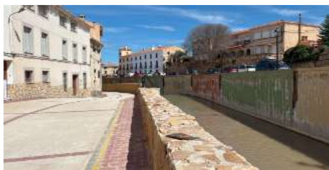
Figura 20. Calle Camino de San Antón con las barandillas de la margen derecha totalmente arrancadas
