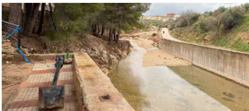
Figura 16. Estado actual del cauce inmediatamente aguas arriba del comienzo del encauzamiento
