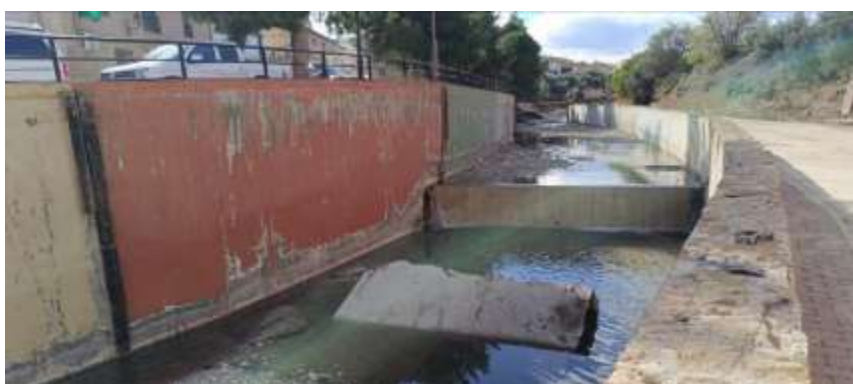
Figura 54. Detalle losa del encauzamiento colapsada entre el primer y segundo resalto
