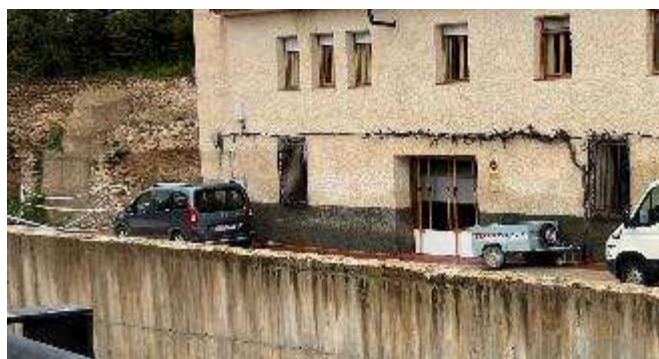
Figura 21. Taller de carpintería en la Calle Camino de San Antón afectado por la DANA
