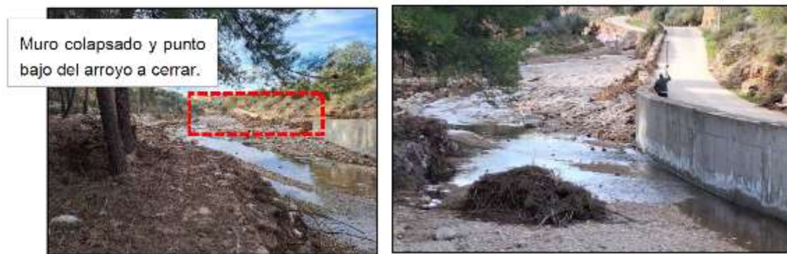
Figura 56. Detalle muro destruido por las inundaciones en el camino de San Antón. Aguas arriba de Letur
