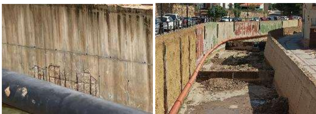
Figura 25. Desperfectos en los cajeros del encauzamiento (izda.) y en la solera (dcha.)
