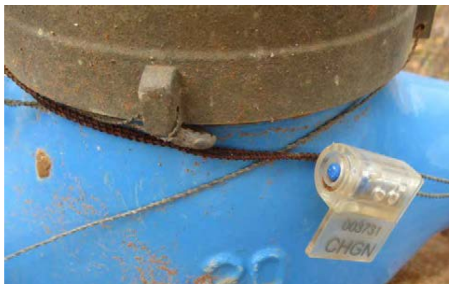
Fig. 5.3. Precinto con inicio de oxidación. Comprobar estado y, en su caso, sustituir.
