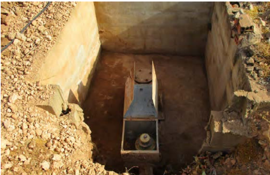
Figura 3.24. Instalación incorrecta. Contador en lugar de difícil acceso y que puede dar lugar a accidentes.
