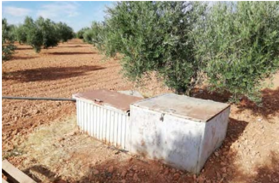
Figura 3.6. Ejemplo de arqueta no inspeccionable. Está cerrada con candado
