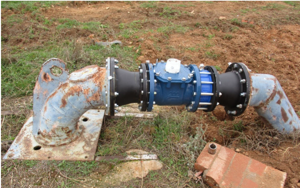
Fig. 4.18. Instalación precintada, en todos sus tramos.
