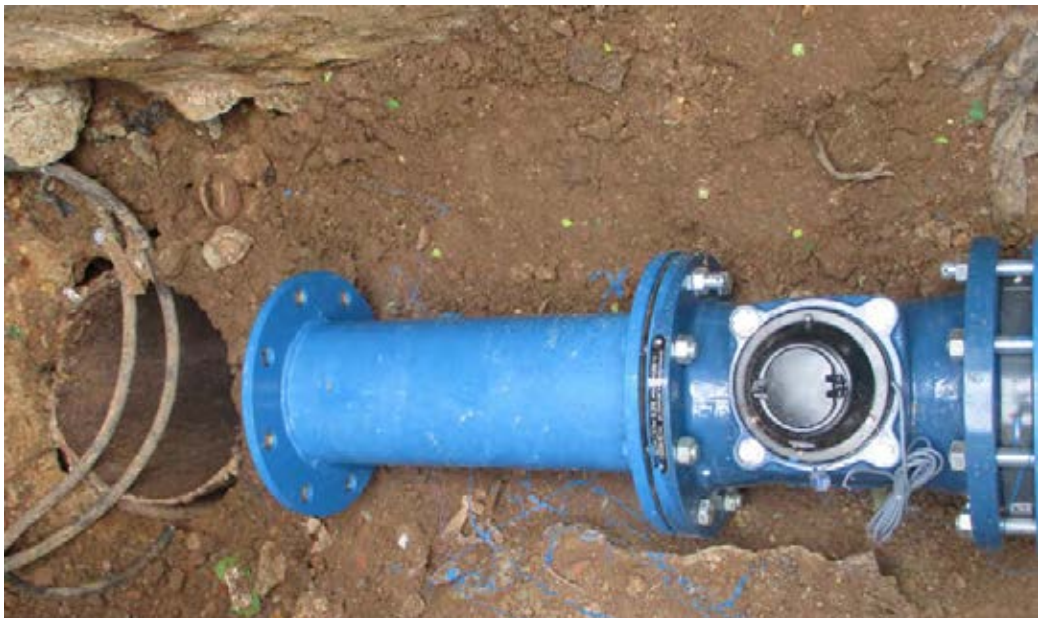
Figura 3.26. Instalación incorrecta. Captación no instalada. Se puede instalar sin conectar al contador.
