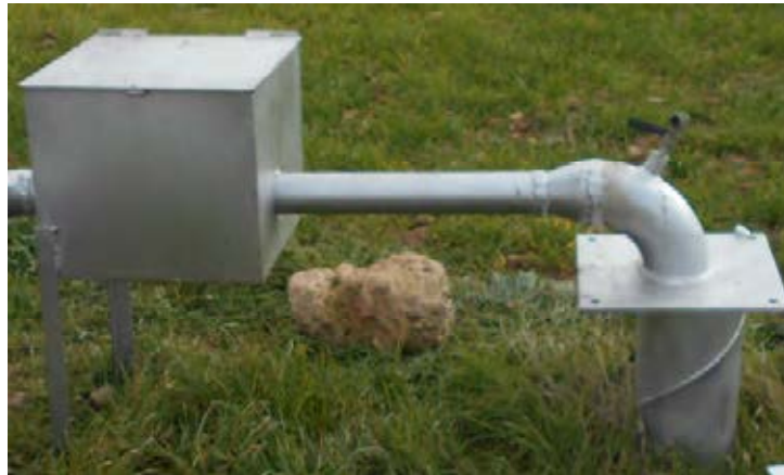
Figura 3.12. Grifo antes de contador. Incorrecto.
