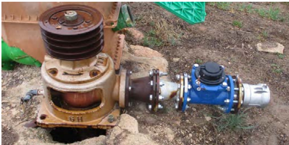
Figura 3.22. Instalación incorrecta. Secuencia de conos de reducción/ampliación sin tramos rectos. Tipo de unión no válida. Insuficiente longitud de tubería aguas abajo. Entrada de aire al interior de la instalación, que puede dar lugar a conteo negativo.
