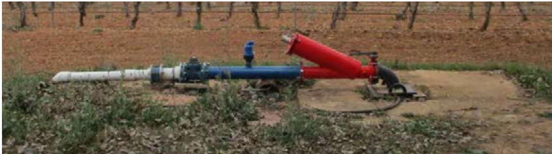
Figura 3.14. Filtro antes de contador.
