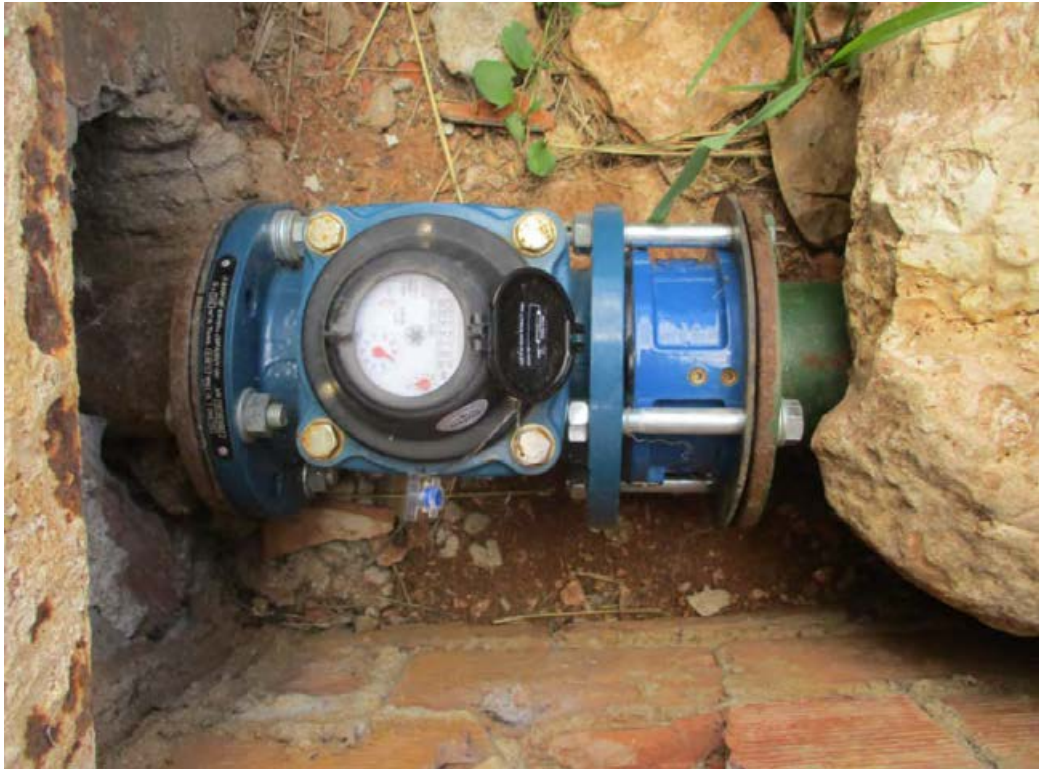
Figura 3.27. Tubería no visible entre captación y contador. Antes de precintarse comprobar que la misma es visible en el interior de la caseta, no existen derivaciones y cumple resto de requisitos antes de precintarse. Si la tubería está enterrada y no es visible, no precintarse.
