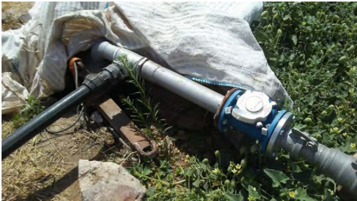
Figura 3.19. Instalación incorrecta. Derivación antes del contador. Unión no válida aguas abajo del contador que permite acceso directo al interior del mismo. En este caso sólo se ha precintado el contador, no se han precintado uniones, bancada, etc.
