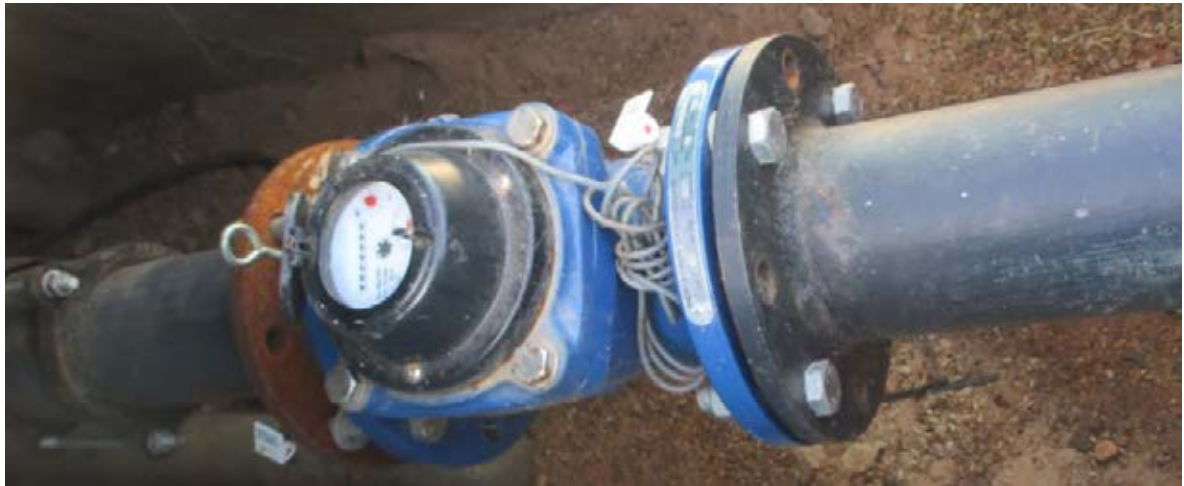
Fig. 4.16. Contador Woltmann. Precintos no conforman eje paralelo a la dirección del flujo.
