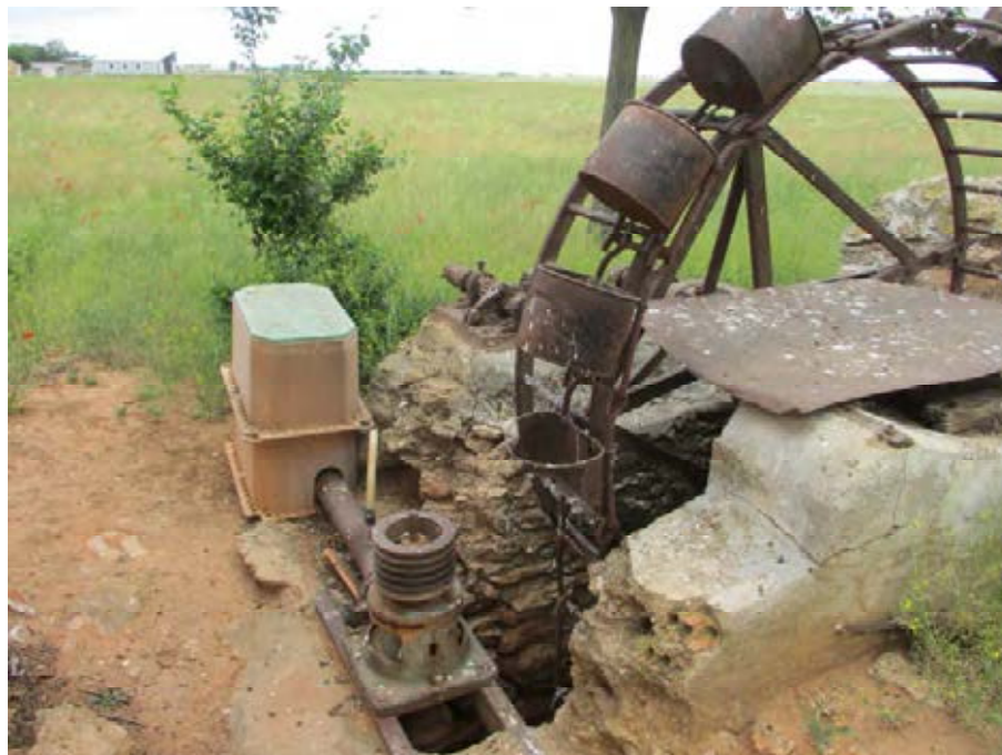
Fig. 6.2. Bomba vertical instalada en una noria. No es aplicable la excepción al no tratarse de una bomba de succión.
