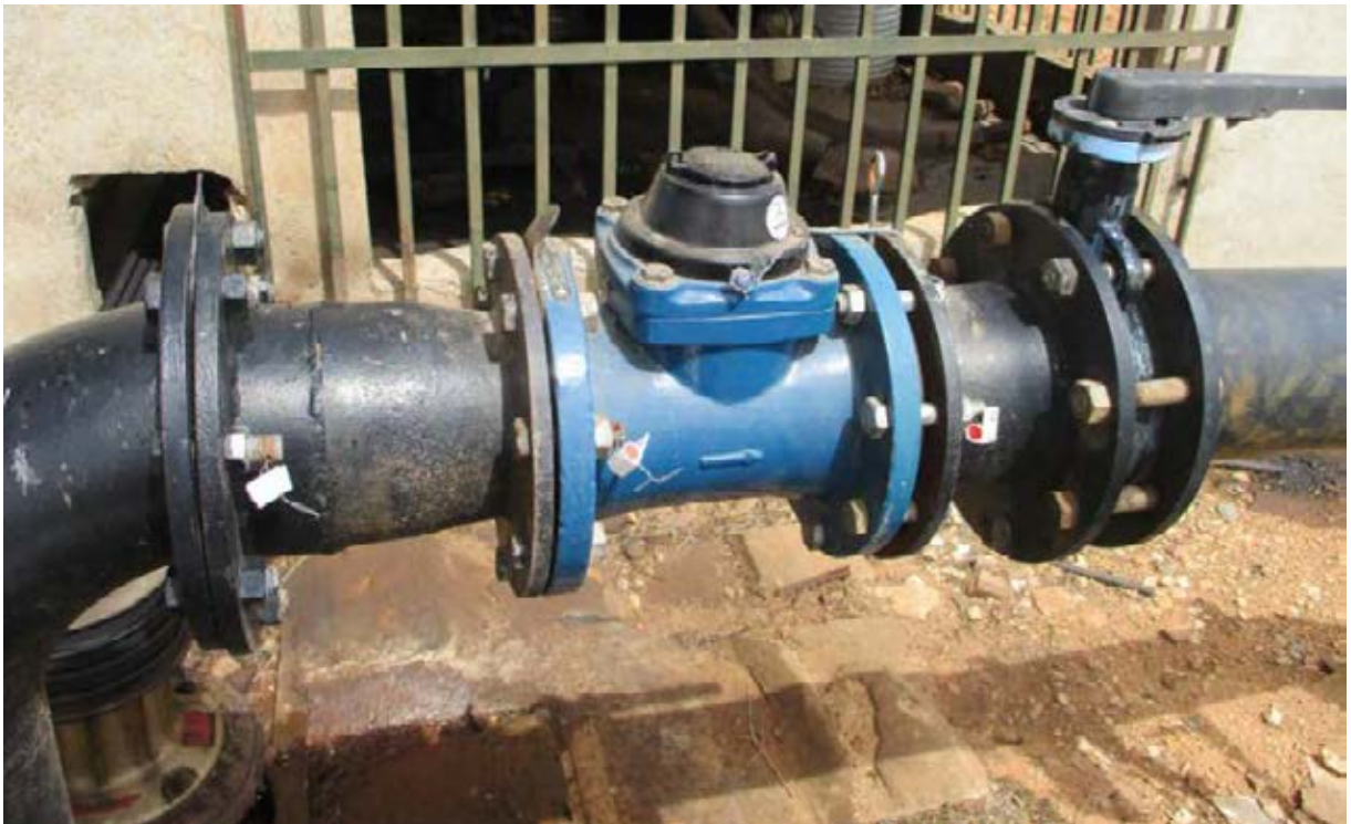
Figura 3.17. De izq. a dcha. Codo, cono de reducción, contador, llave de paso.
