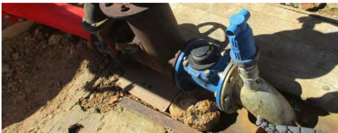
Figura 3.20. Incumplimiento de las prescripciones del fabricante. Insuficiente tramo recto antes y después del contador. Caso más usual de instalación incorrecta.
