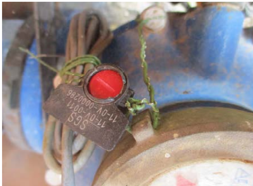
Fig. 4.9. Precintos de SGS, entidad verificadora de contadores
