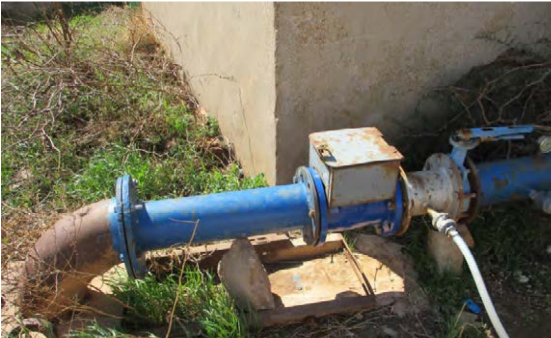
Figura 3.23. Instalación incorrecta. Arqueta que no protege el contador. Tiene el objeto de impedir tomar la lectura e inspeccionar el contador.
