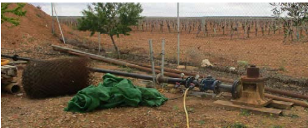
Figura 4.4. Precintado suficiente tramo recto. Modificar instalación si es necesario. Hay que eliminar la derivación justo posterior al contador, facilita el acceso al interior del mismo.
