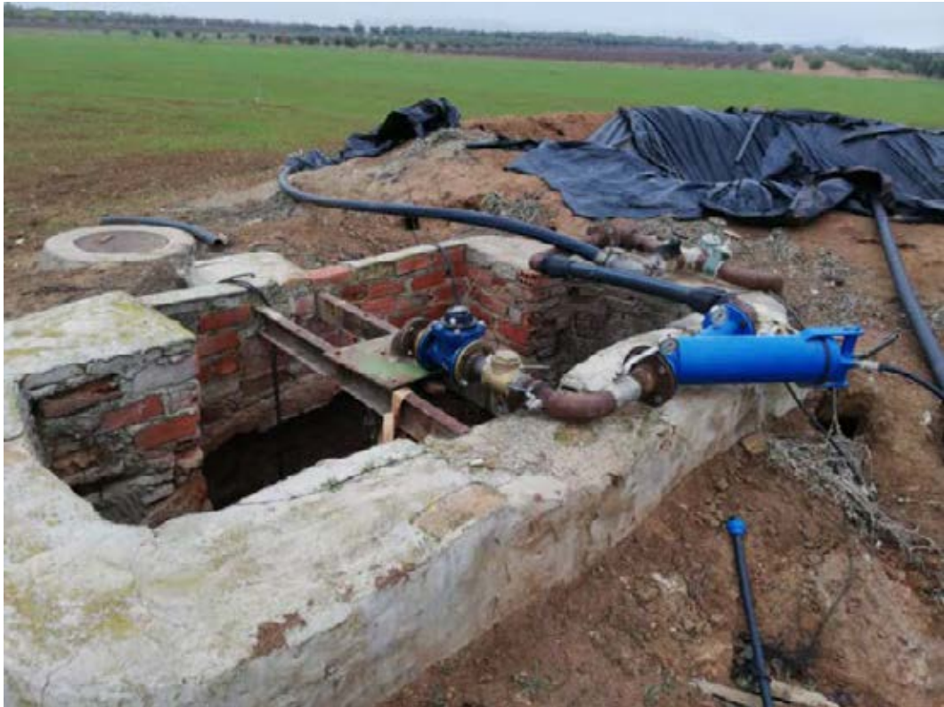
Figura 3.25. Instalación incorrecta. Contador en lugar de difícil acceso y que puede dar lugar a accidentes. Durante el precintado y la toma de lecturas se corre el riesgo de caer dentro de la captación.
