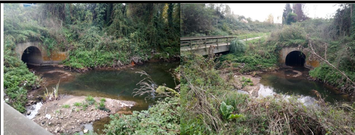
Punto de vertido por desbordamiento del sistema de saneamiento en episodios de lluvia al DPH (PVDSS), asociado a una Infraestructura de Regulación de Aguas Residuales (IRAR), Tanque de Tormentas. España. Fuente: MITECO.
