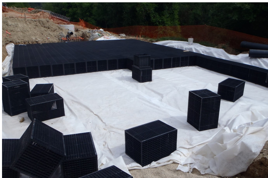
FIGURA 9: DEPÓSITO RETICULAR INSTALADO EN GUERENDIAIN (NAVARRA).
