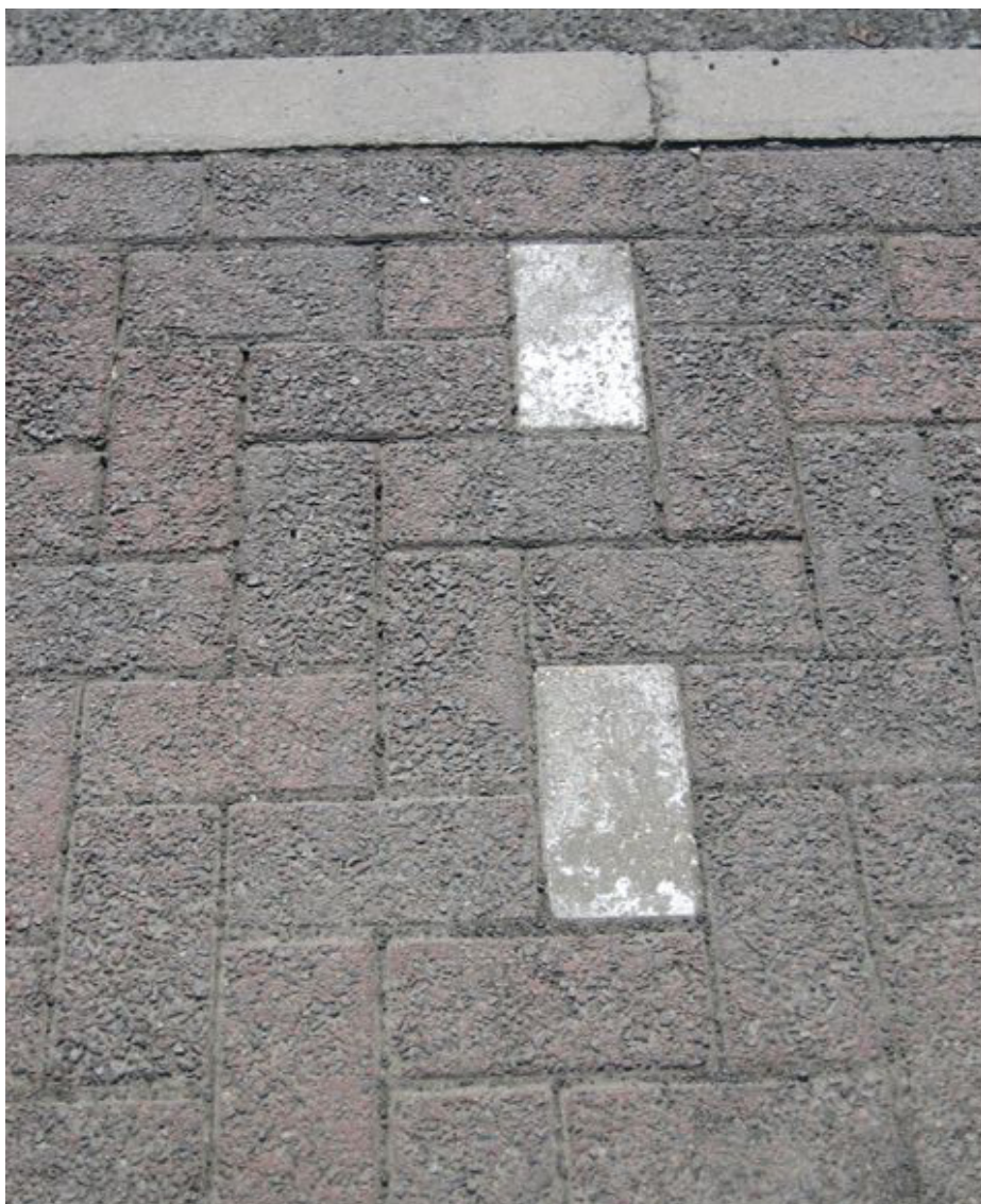
FIGURA 43: EJEMPLO DE FALTA DE CONSIDERACIÓN DEL MANTENIMIENTO EN FASE DE DISEÑO DE LOS SUDS, DUNDEE (ESCOCIA).
