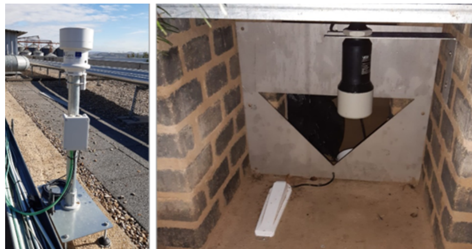
FIGURA 50: PLUVIÓMETRO Y MEDIDOR DE NIVEL.
