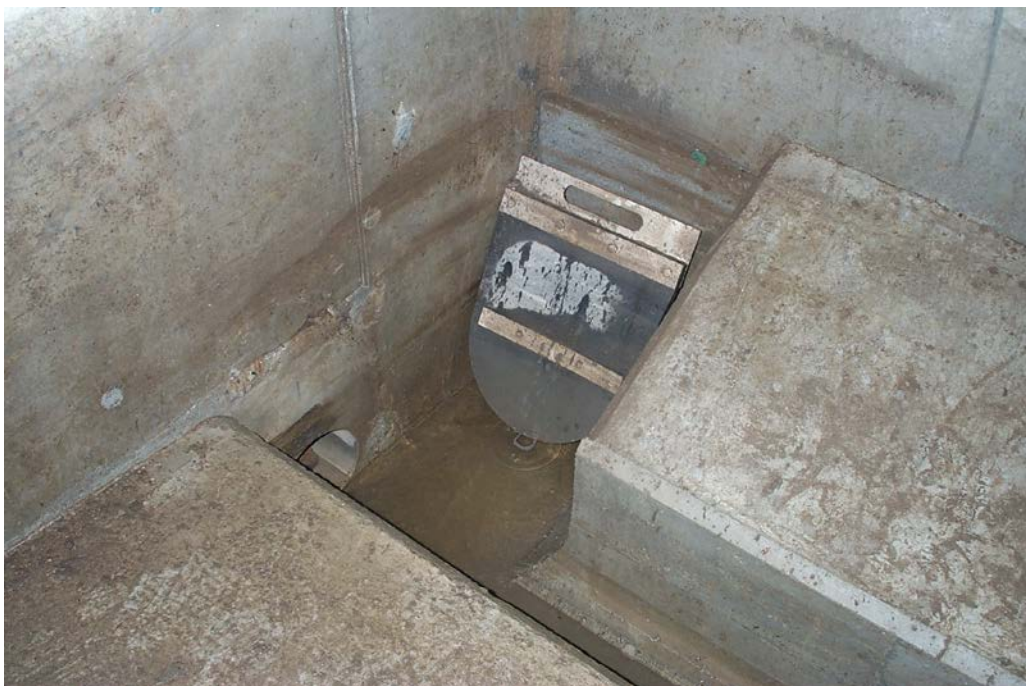
Figura 42 Clapeta antiretorno en tanque Louro (Pontevedra)
