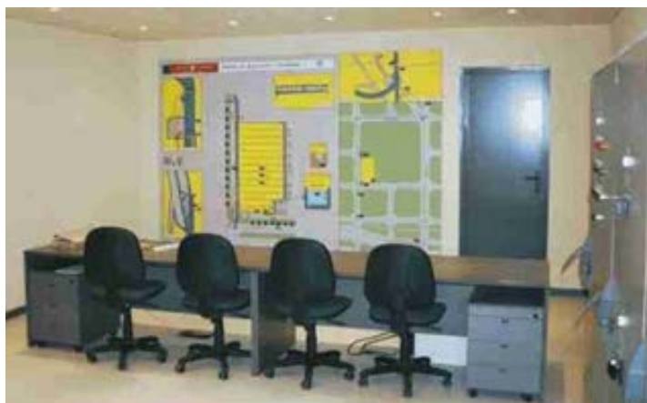
Figura 86 Local técnico de un tanque
