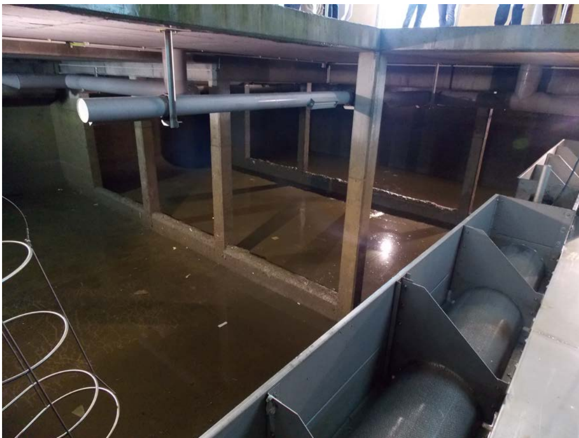
Figura 34 Tanque de tormentas en Lugo.
