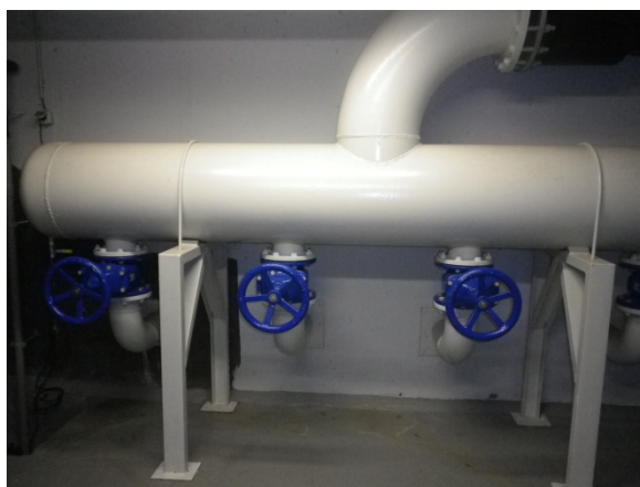
Figura 78 Colector de salida de una impulsión
