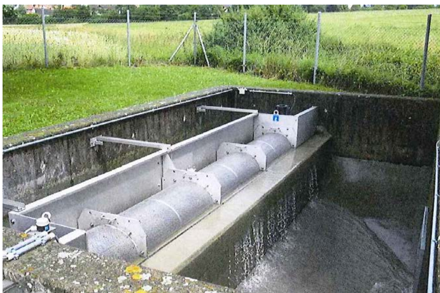
Figura 31 Tamiz rotativo automático colocado en un aliviadero
