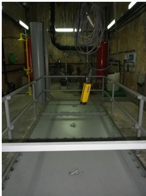
Figura 85 Acceso al mantenimiento de las bombas
