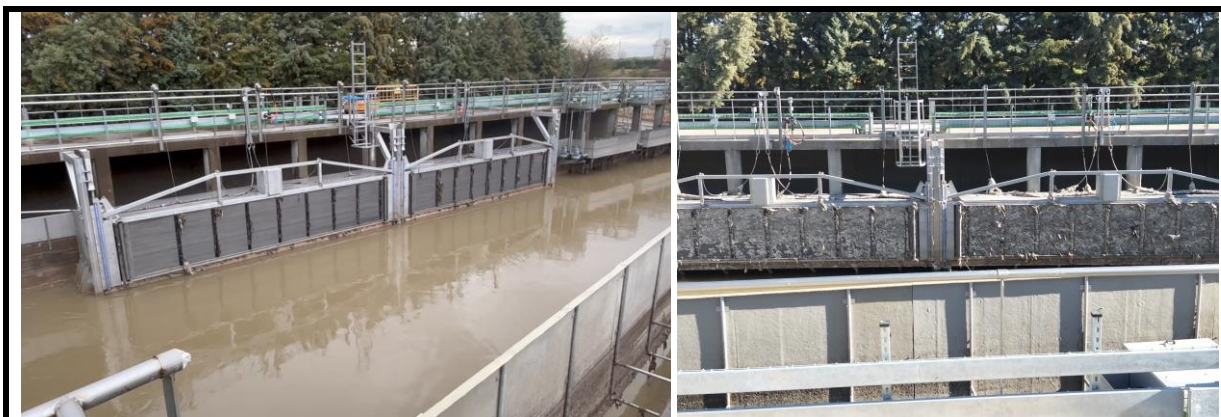
Dos tamices de aliviadero de limpieza automática tipo PEINE, con sistema de limpieza lateral, antes (izquierda) y después (derecha) de un episodio de lluvia (en pruebas, por dicho motivo no se activó la limpieza lateral, observándose la acumulación de contaminantes), instalados en un sistema de saneamiento unitario. Fuente: Hidrostack.
