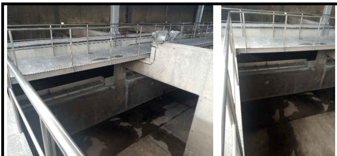
Tamices rotativos instalados entre la Cámara central y las Cámaras de retención en el Aliviadero Oviedo Sur (o Tanque de Tormentas Oviedo Sur). Cuenca del río Nora en Oviedo (Asturias). Cortesía del Consorcio de Aguas de Asturias (CADASA). Gobierno del Principado de Asturias.
