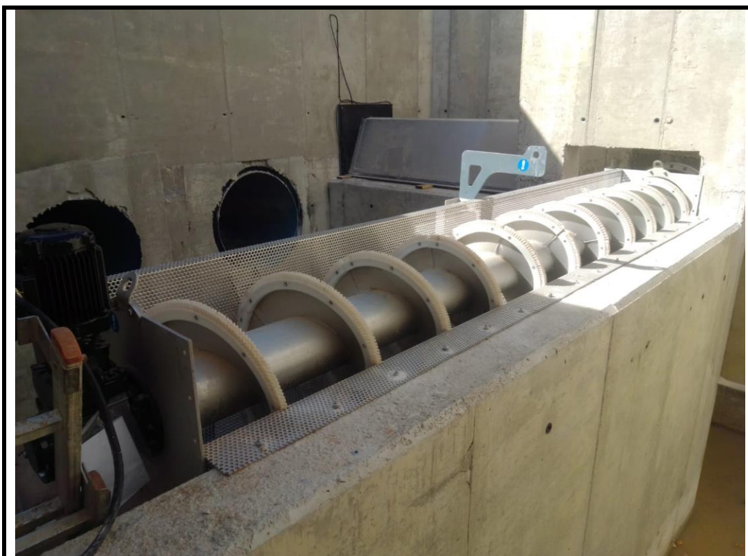
Tamiz de aliviadero tipo tornillo en espiral, montado aguas abajo. Gestión localizada de los residuos a una arqueta adyacente. Al fondo, aliviadero flexible para verter un elevado caudal (l/s·m) y que no entre en carga el sistema de saneamiento. Fuente: CleanWater.
