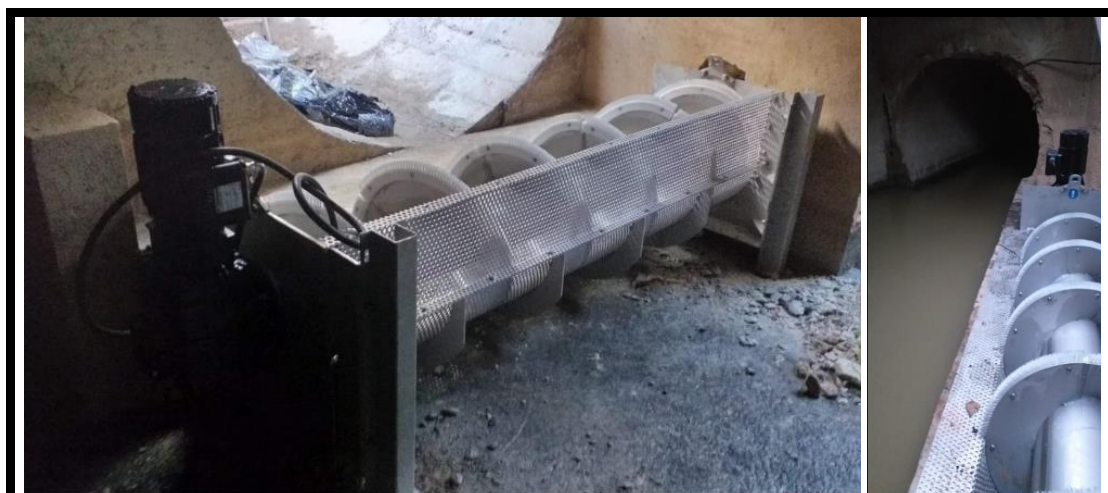
Tamices en espiral instalados en aliviaderos del sistema de saneamiento de Castellón. Cortesía del Ayuntamiento de Castellón.
