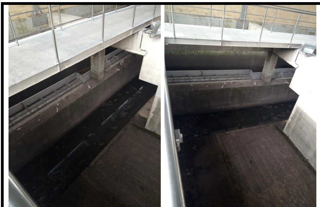
Tanque de Tormentas Fluyente Off-Line. Tamices rotativos en el Aliviadero Oviedo Norte (o Tanque de Tormentas Oviedo Norte) entre la Cámara central y las Cámaras de retención. Cortesía del Consorcio de Aguas de Asturias (CADASA). Gobierno del Principado de Asturias.
