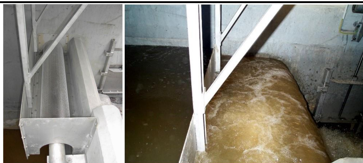
Evolución del funcionamiento de un tamiz de aliviadero de limpieza automática tipo PAS (con energía y orificios con un diámetro Ø nominal de 6 mm) y pantalla deflectora de flotantes, durante un episodio de lluvia e instalados en un sistema de saneamiento unitario. Tras el episodio el tamiz vuelve a estar operativo y limpio. Alemania. Fuente: Hidrostock.
