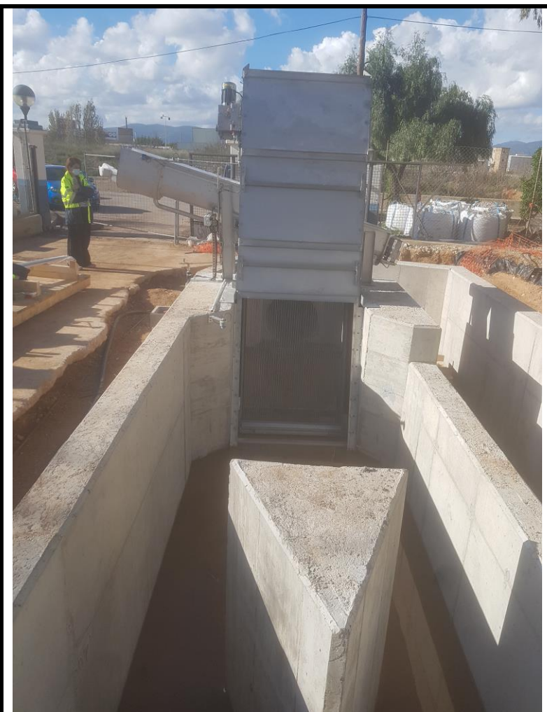
Reja de desbaste motorizada en un canal de alivio de un sistema de saneamiento separativo. Fuente: CleanWater.
