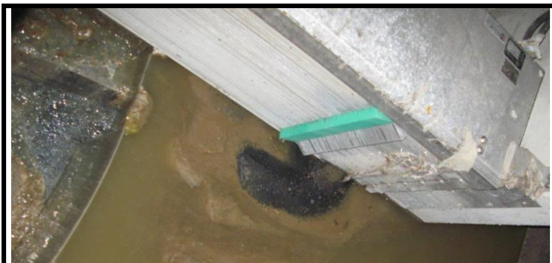
Red primaria de saneamiento del Consorcio de Aguas Bilbao Bizkaia. Tamiz lateral sobre vertedero. Instalado paralelo y encima del propio vertedero. Filtra de arriba hacia abajo. La limpieza se realiza mediante un peine con sentido de izquierda a derecha. Posibilidad de rebose por encima. Cuenta con una sonda de nivel que se activa a partir de cierta cota. Fuente: Consorcio de Aguas Bilbao Bizkaia (CABB).
