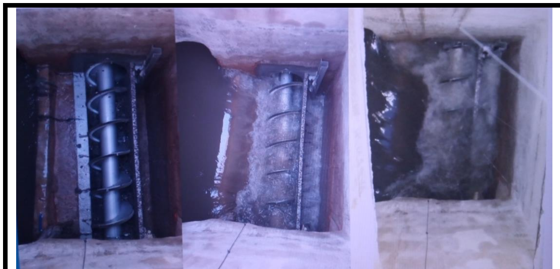
Tamiz en espiral instalado en el aliviadero Río Seco del sistema de saneamiento de Castellón. Malla de paso de 10 mm, 2,10 m de largo y 0,5 m de diámetro. El tornillo sin fin dispone de unas escobillas que retiran los sólidos de la malla de paso y los conduce a otra arqueta independiente. En dicha arqueta se retiran los sólidos mediante camión cuba. Cortesía del Ayuntamiento de Castellón.
