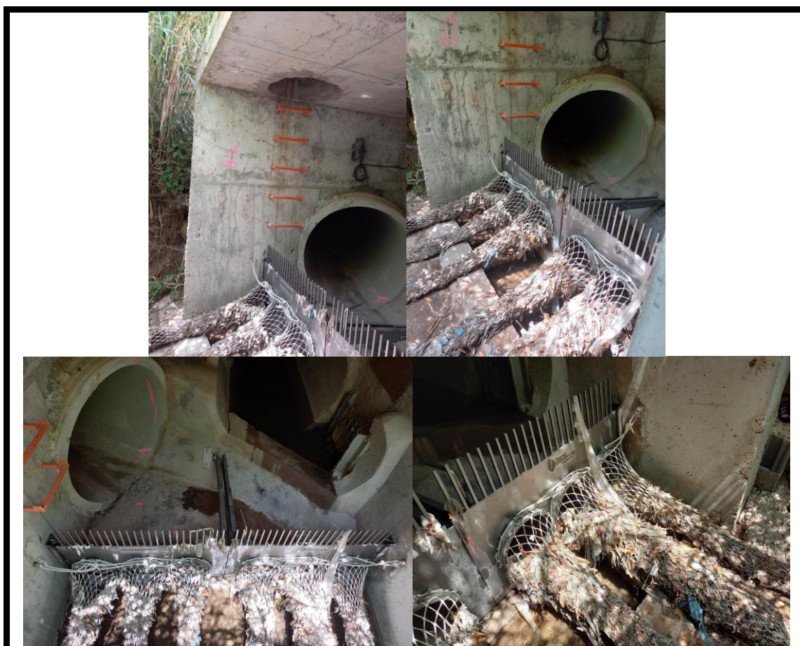
Retención de sólidos gruesos y flotantes mediante la instalación de 6 cestas TecnoGrabber® y su monitorización [Sensor de nivel por ultrasonidos (US) sin contacto + Registrador de datos SOFREL LT-US (Data Logger)] en un colector del sistema de saneamiento de Sant Fruitós de Bages (Barcelona). Río d'Or. 28/07/2022. Fuente: Agencia Catalana del Agua (ACA), LACROIX SOFREL y Tecnoconverting.
