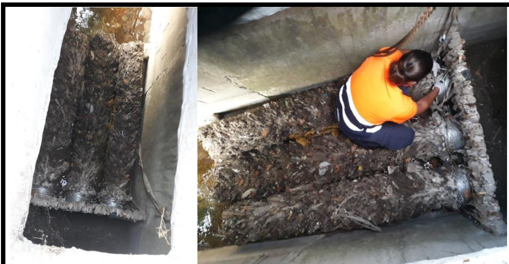
Retención de sólidos gruesos y flotantes mediante 3 cestas TecnoGrabber® tras un episodio de lluvia, instaladas en un colector del sistema de saneamiento. Parc de La Clota. Sabadell (Barcelona). Río Ripoll. 03/09/2020. Fuente: Tecnoconverting.
