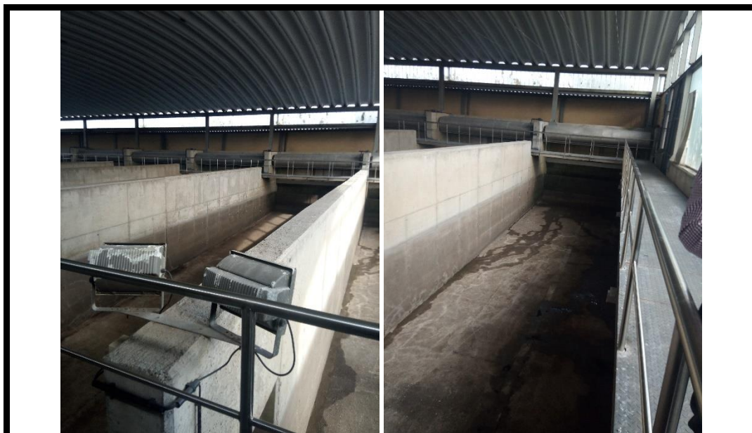
Cámaras de retención en el Aliviadero Oviedo Sur (o Tanque de Tormentas Oviedo Sur). Cuenca del río Nora en Oviedo (Asturias). Cortesía del Consorcio de Aguas de Asturias (CADASA). Gobierno del Principado de Asturias.
