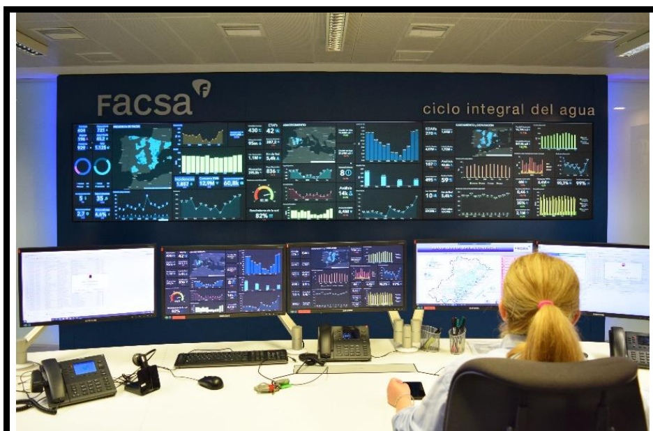
Centro de control. Fuente: Facsá.
