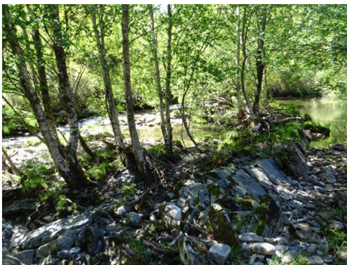
Foto 5: Inicio del canal de derivación abandonado
