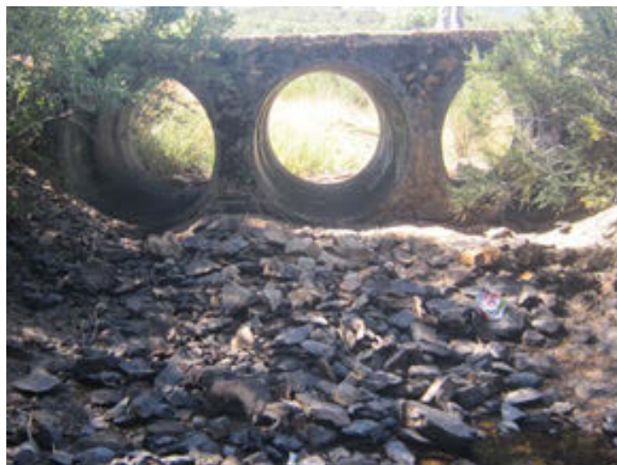
Foto 8: Vista frontal del puente cortado de la foto anterior
