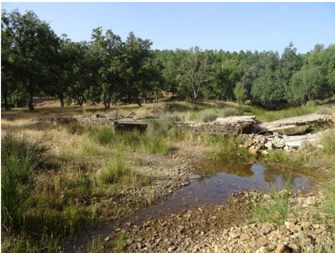
Foto 3: Vado en ruinas en la Zona 2 de la reserva del río Montoro
