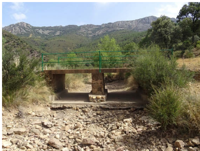
Foto 14 : Puente descalzado en la Zona 3 de la RNF, en el punto de partida del Camino de la Nava, que recorre la ladera meridional de la Sierra de Valdoro, hacia la Hoz de Valdoro.
