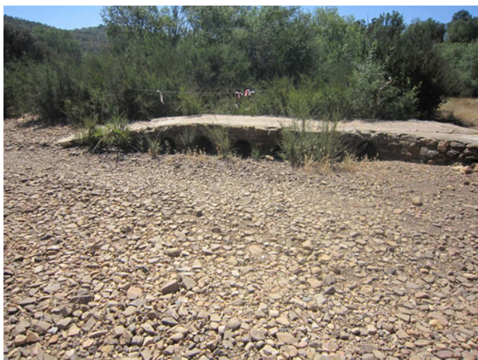
Foto 9: Vado con tubos cerca de Ventillas, ocupando parte del cauce
