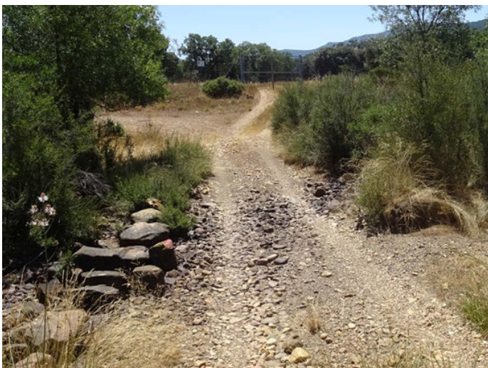
Foto 13: Vado franqueable en el camino de Navamartina, inicio de la Zona 3 de la RNF.
