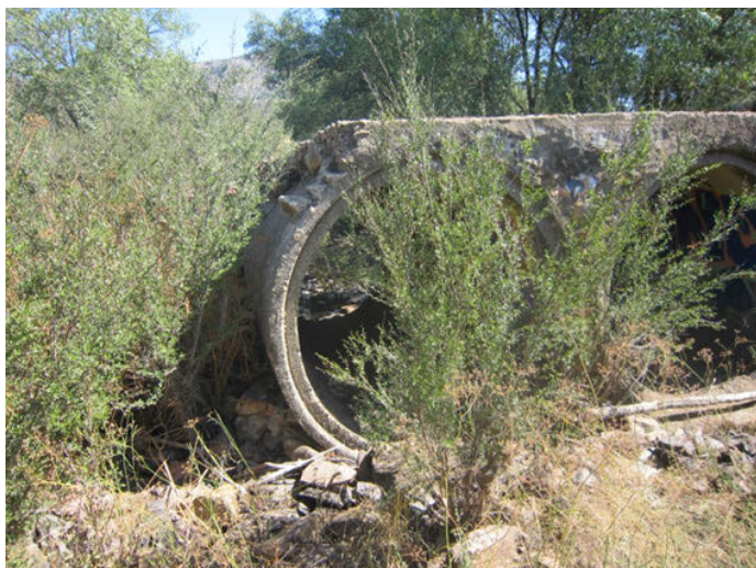
Foto 7: Puente roto,0 junto a la aldea de Ventillas
