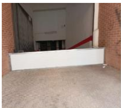
Barrera en puerta de garaje.
