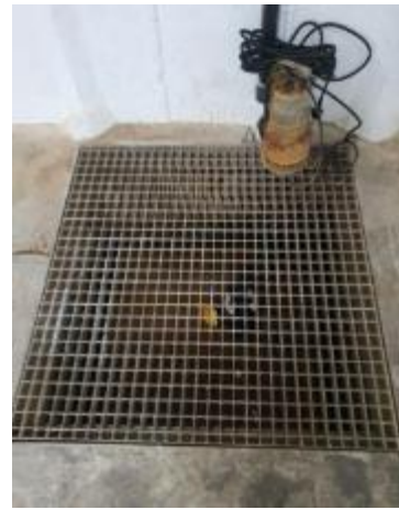
Bomba de achique en el foso.
