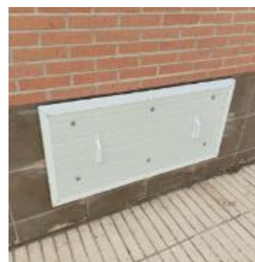
Barrera tipo instalada en huecos de ventanas de garaje.
