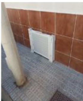
Barrera ventana garaje.
