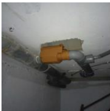
Válvula de retención en acometida de alcantarillado.
