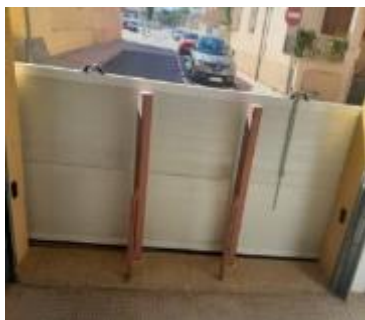
Compuerta de garaje semisótano.
