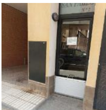
Barrera portal entrada edificio.
