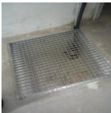
Arqueta y bomba de achique en sótano.
