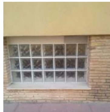
Protección en rejillas de ventilación.
